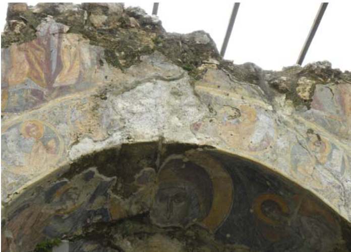
Εικ.36. Φθορές στις περιφερειακές προστατευτικές σφραγίσεις των επιχρισμάτων
