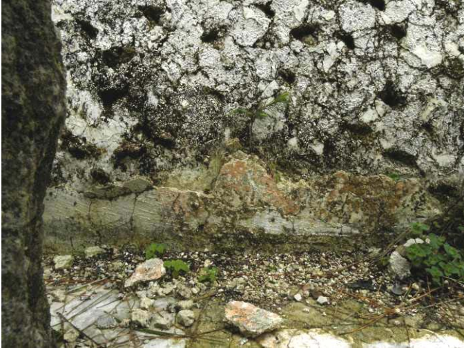
Εικ.30. Παρατηρείται σταδιακή κατάρρευση των επιχρισμάτων.
