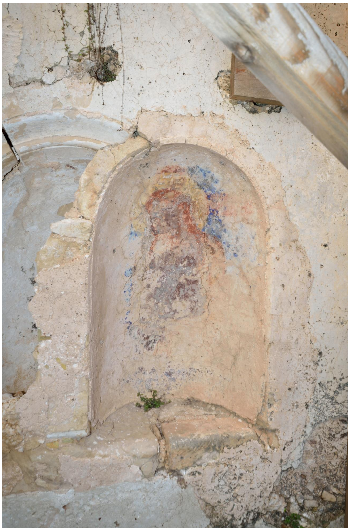
Εικόνα 2: Κοντινή λήψη της κόγχης. Διακρίνεται τα ασβεστοκονιάματα που έχουν επικαλύψει την εικονιζόμενη μορφή.
