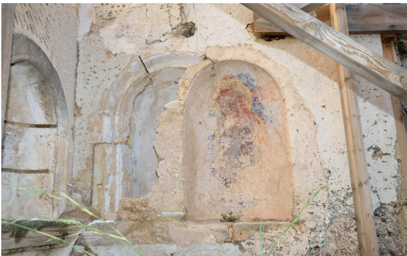
Εικόνα 1: Πάνω και κάτω εικονίζεται σε γενική άποψη του χώρου η θέση της τοιχογραφίας στον ΒΑ τοίχο του ιερού του καθολικού της μονής. Η απουσία στέγης έχει καταστρέψει ανεπανόρθωτα την εικονιζόμενη μορφή.
