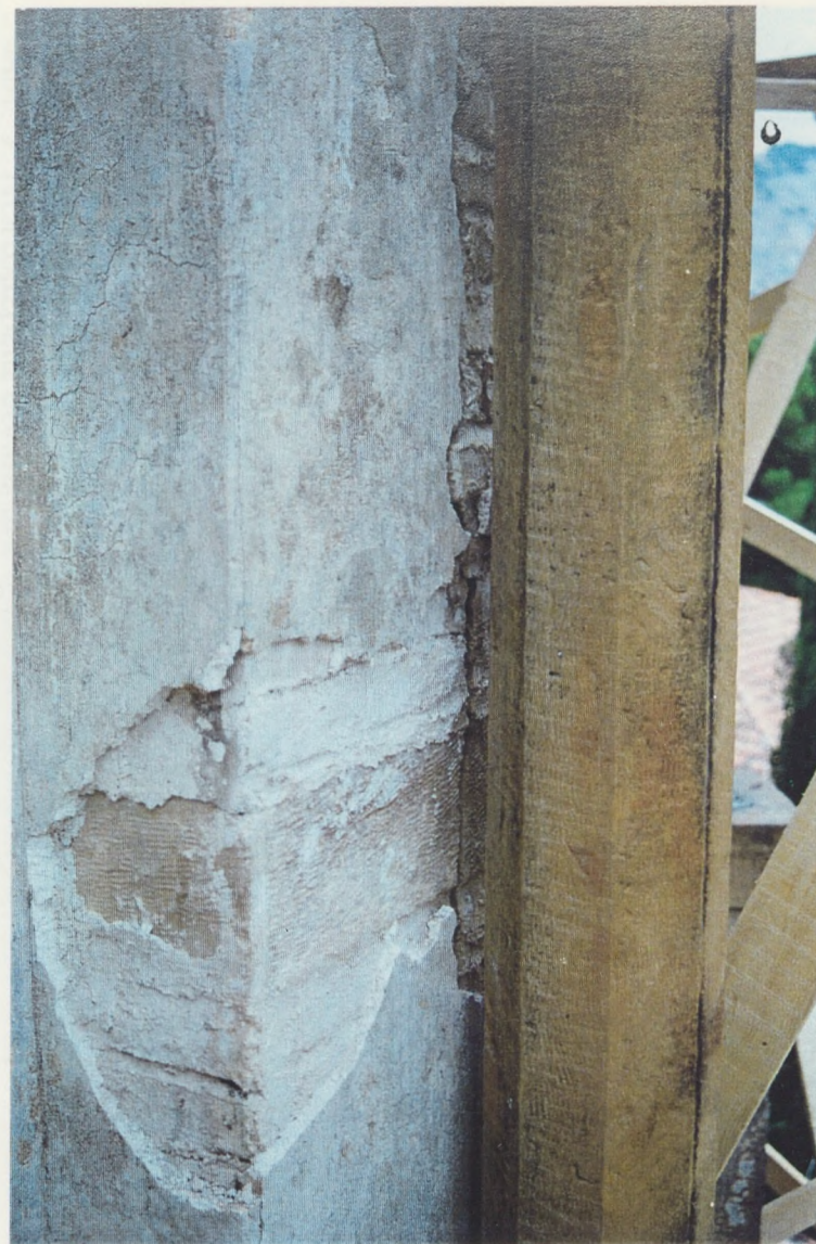
Φωτ. 4. Λεπτομέρεια τυμπάνου του τρούλου. Διακρίνονται κατακόρυφες ρωγμές πίσω από τον κιονίσκο.
