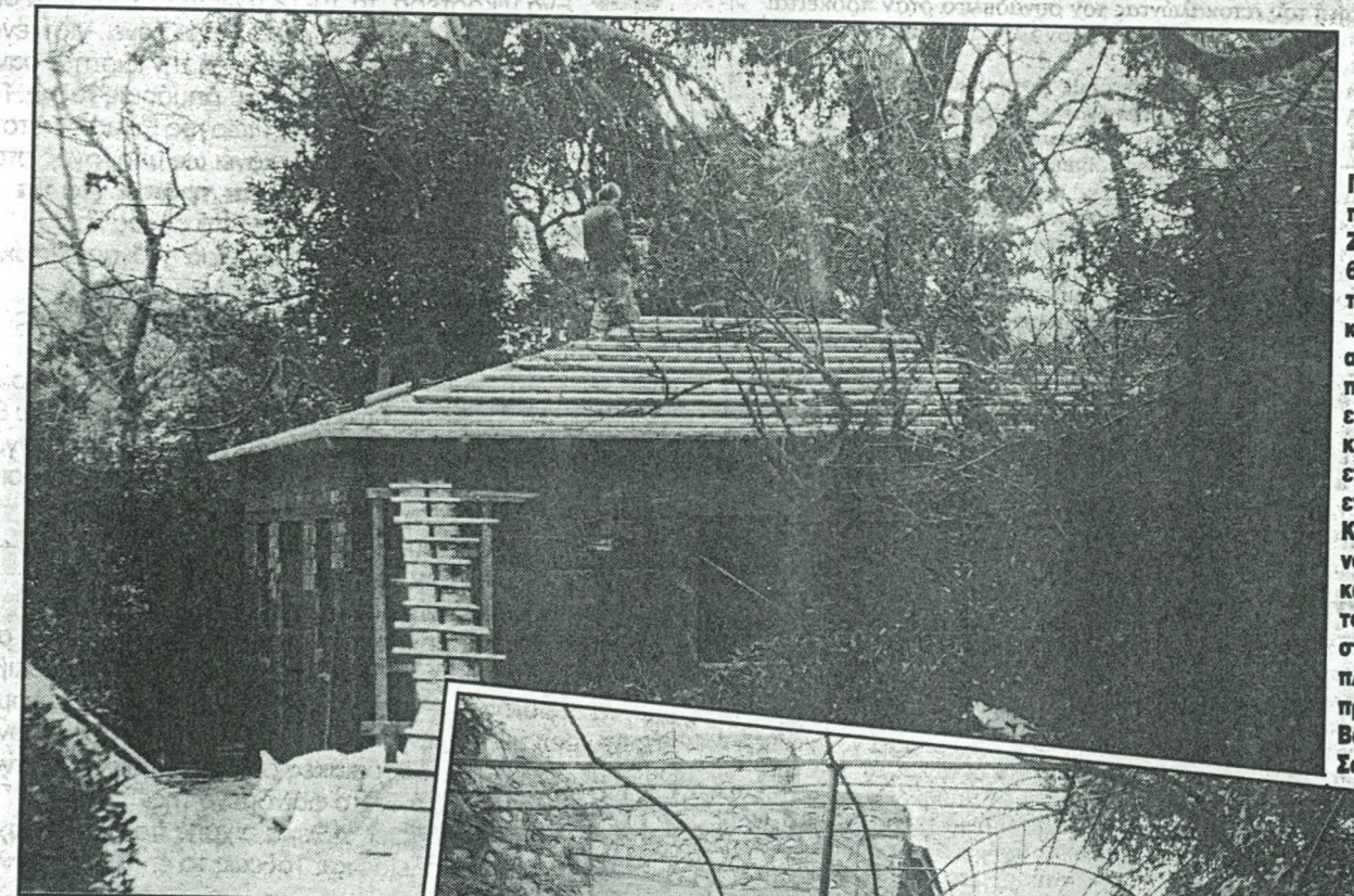
Προς την πλευρά του Ζαπτείου βρίσκεται το υπό κατασκευήν αυθαίρετο, που ευτυχώς κάποιος το εντόπισαν εγκαίρως. ΚΑΤΩ: Το νόμιμο καφέ-ντεάκι του Κήπου, στην πλευρά προς τη Βασιλίσση Σοφίας
