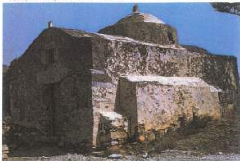
Pl. 26 c et d Hagios Ioannis, Adissarou; à gauche, état avant 1989; à droite, intervention récente.
