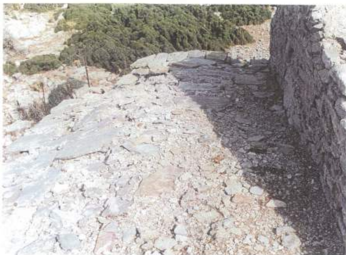
Ο νεώτερος θόλος που καλύπτει το νάρθηκα. Η επικάλυψη κατεστραμμένη. Pl. 6 a La voûte tardive qui couvre le narthex. La couverture est détruite.
