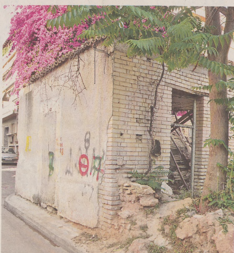
Ανάμεσα στα κτίρια που ελέγχθηκαν, εντοπίστηκαν τριάντα δύο τα οποία χαρακτηρίστηκαν «σοβαρές ανθυγιεινές εστίες».
