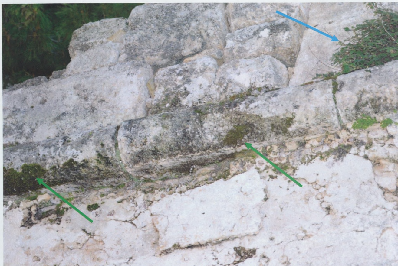
Εικόνα 13: Λίθινη διακοσμητική ζώνη στη τοιχοποιία των τειχών του μοναστηριού στη ΒΑ πλευρά κάτω από το καμπαναριό. Παρουσία κρούστας βιολογικών επικαθίσεων γκριζου χρώματος. Διακρίνονται πληθυσμοί βρύων πράσινου χρώματος . Ανάπτυξη αυτοφύων φυτών στους αρμούς σύνδεσης.
