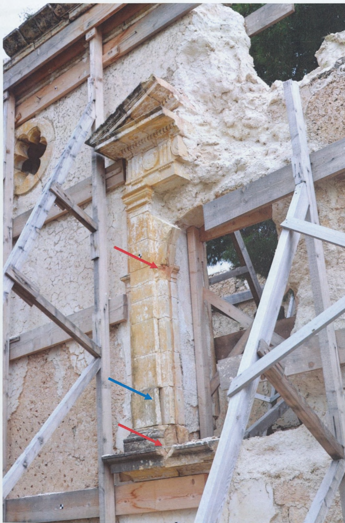
Εικόνα 9: Άνοιγμα Π3 λήψη υπό γωνία. Αποκρούσεις και απώλειες υλικού στους λίθους του οριζόντιου γείσου της ποδιάς και μετατοπίσεις λίθινων τμημάτων.
