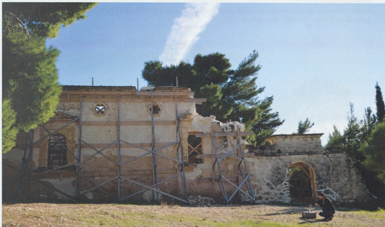
Εικόνα 1: Άποψη από τη ΒΔ πλευρά του καθολικού, διακρίνονται οι σοβαρές φθορές του επιχρίματος και οι επεμβάσεις προσωρινής αντιστήριξης και ενίσχυσης με λευκή τσιμεντοκονία των απολεσθέντων δομικών και διακοσμητικών στοιχείων μετά το μεγάλο σεισμό του 1953.
