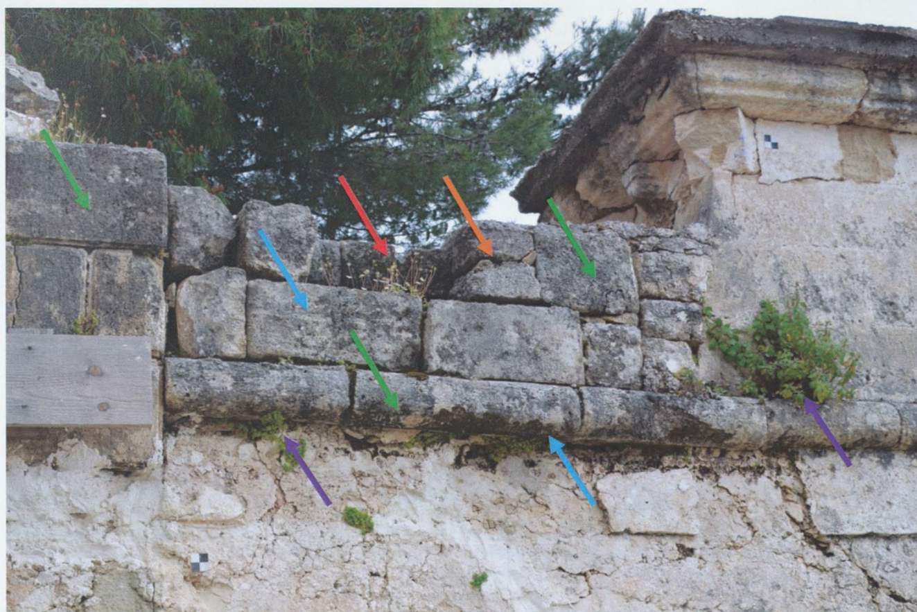
Εικόνα 14: Πάνω: Διακοσμητικός γεισίποδας με επίχρυσμα μπλε χρώματος. Κάτω: τμήμα της εξωτερικής τοιχοποιίας των τειχών του μοναστηριού μεταξύ του καθολικού και του καμπαναριού. Απώλεια υλικού , θραύσεις , κρούστα βιολογικών επικαθήσεων , μετατοπίσεις λίθων , ανάπτυξη αυτοφυών φυτών στα κενά των αρμών.
