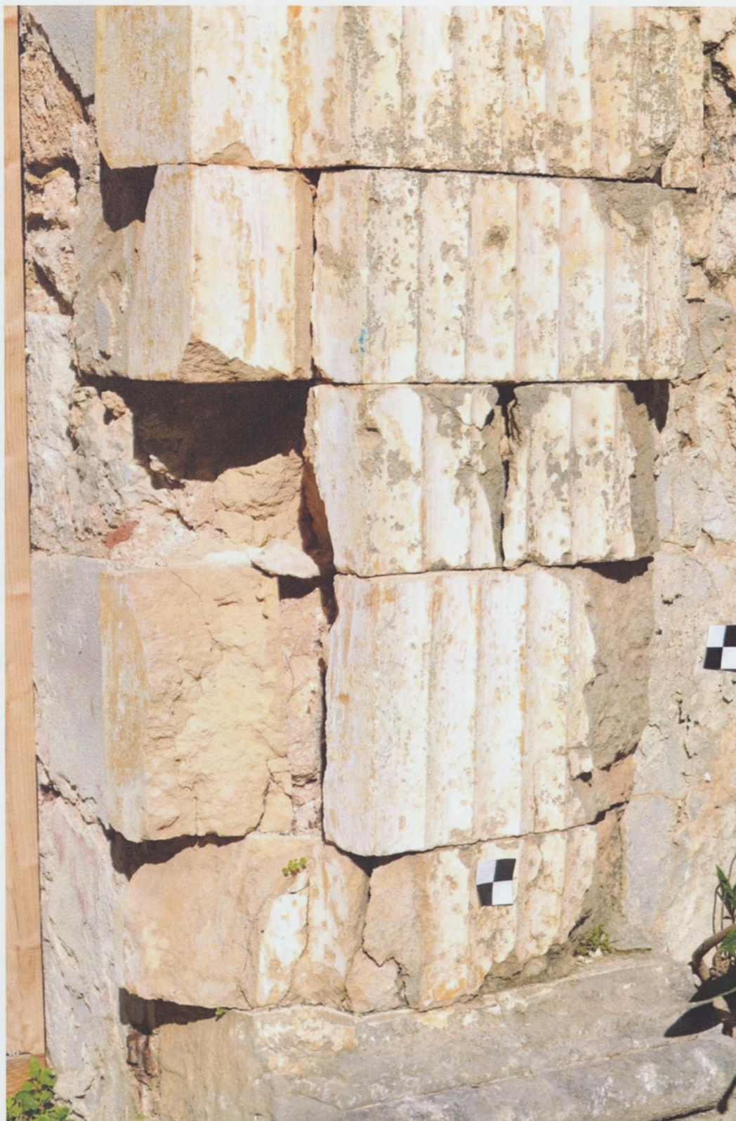
Εικόνα 34: Θύρα Φ2: σημαντικές φθορές χαμηλά στη βάση της αριστερής παραστάδας, με απώλεια υλικού, θραύσεις και ρηγματώσεις.
