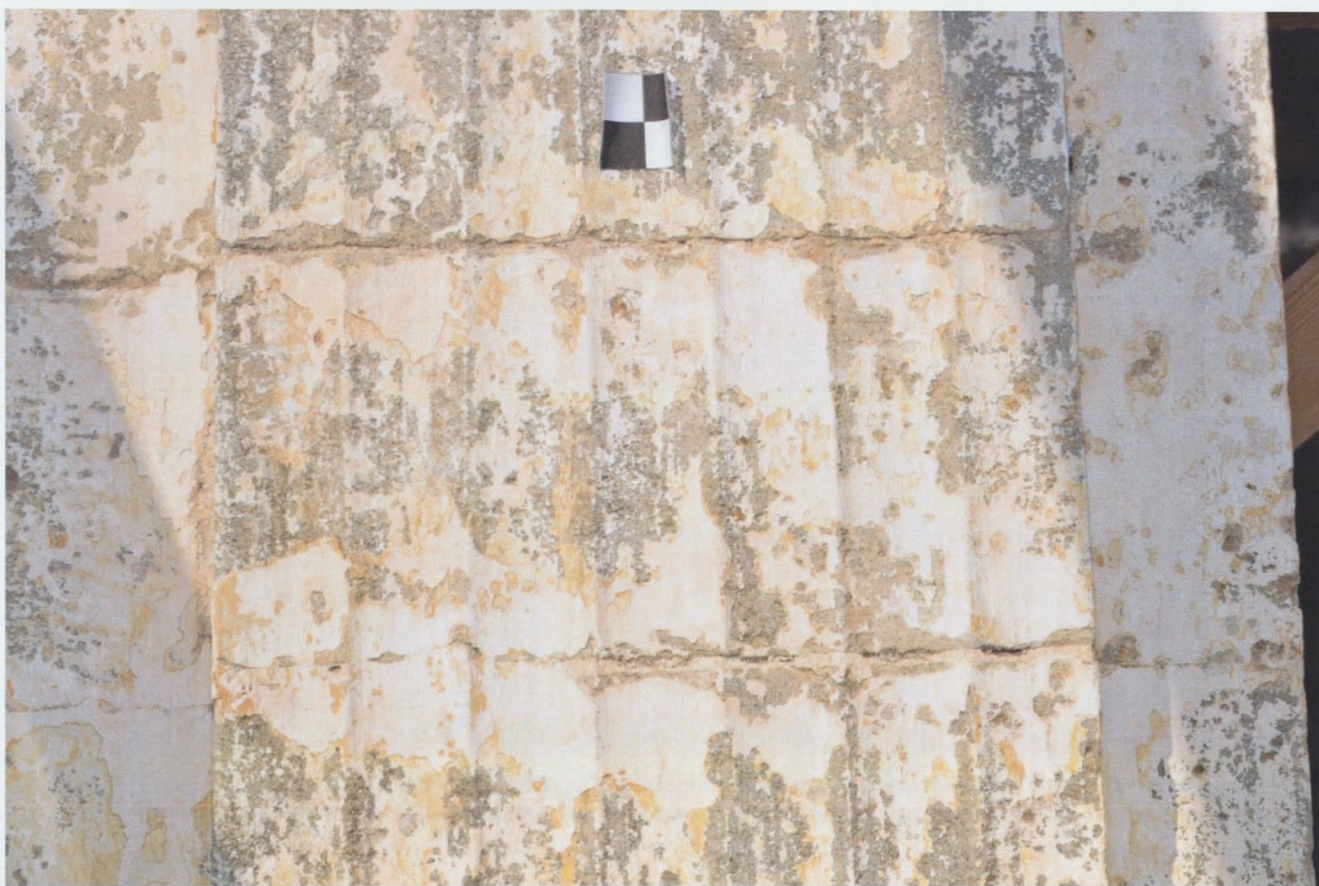
Εικόνα 31, 32: Θύρα Θ2. Πάνω: άποψη των πρόμοχθων και του θριγκού, απώλειες υλικού, βιολογικές επικαθίσεις. Κάτω: λεπτομέρεια από την επιφάνεια της δεξιάς παραστάδας, επάλληλα στρώματα ασβεστοκονίας μαζί με χρώμα, γκρίζες κρούστες από τη δράση βιολογικών παραγόντων.
