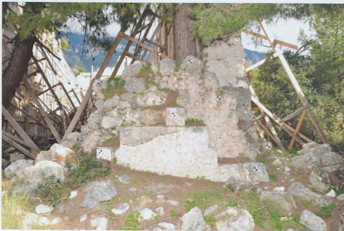
Εικόνα 43, 44: Πάνω Άποψη της κόγχης του ιερού διακρίνεται στη γένεση του θολίσκου το λίθινο μικρό γείσο. Επικαθίσεις βιολογικών παραγόντων στην επιφάνειά του. Κάτω: Τμήμα από τους δόμους της ΒΔ πλευράς που υπέστη πλήρη κατάρρευση μετά το σεισμό του 1953. Επίχρισμα και αλλοίωση της επιφάνειας από τη δράση βιολογικών παραγόντων.
