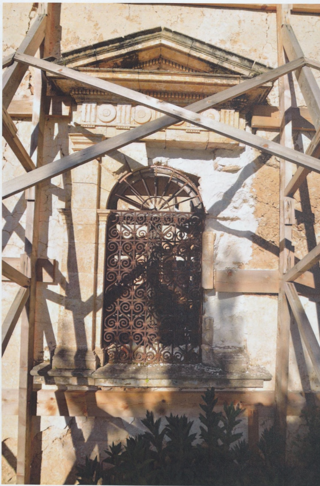
Εικόνα 50: Άνοιγμα Π5, διακρίνεται το σιδερένιο διάφραγμα με το στρώμα οξείδωσης (πορτοκαλί – καφέ απόχρωση).
