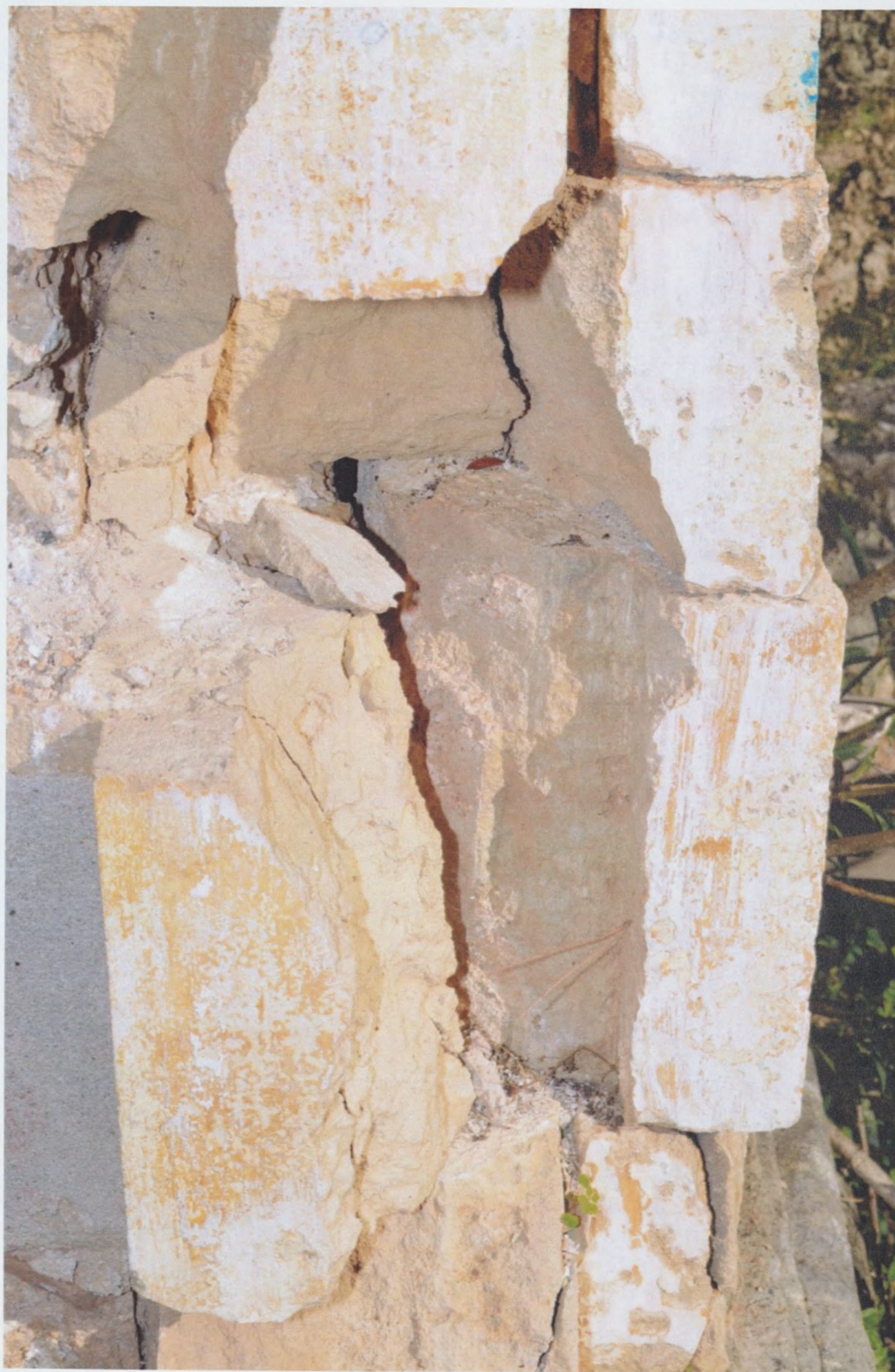
Εικόνα 33: Θύρα 02: Αριστερός λαμπάς. Μετατοπίσεις και θραύσεις δομικού υλικού από μηχανικές πιέσεις που άσκησαν οι σιδερένιοι μεντεσέδες περιστροφής των θυρών του καθολικού.
