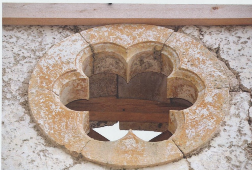
Εικόνα 21: Φεγγίτης στη ΒΑ πλευρά του καθολικού. Παρατηρούνται υπολείμματα ασβεστοκονίας στην επιφάνεια των λίθινων τμημάτων.
