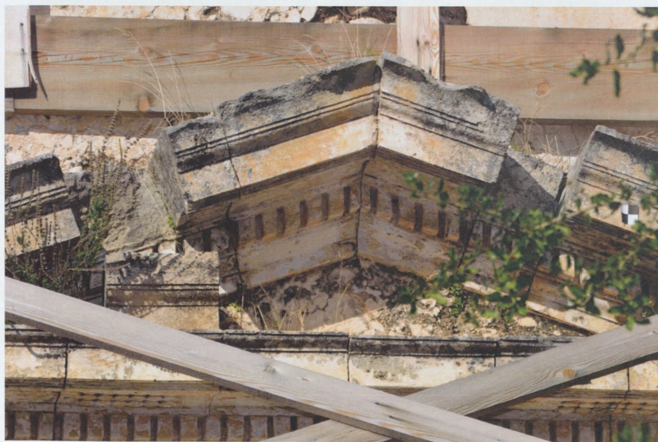
Εικόνα 29, 30: Θύρα Θ2. Πάνω: Λεπτομέρεια από το αέτωμα της θύρας. Σοβαρές απώλειες και καταστροφή της αρχικής μορφής εξαιτίας της δράσης των βιολογικών παραγόντων. Κάτω: απώλειες υλικού από τη δράση του σεισμού και τη πτώση θραυσμάτων από το οριζόντιο γείσο της στέγης.
