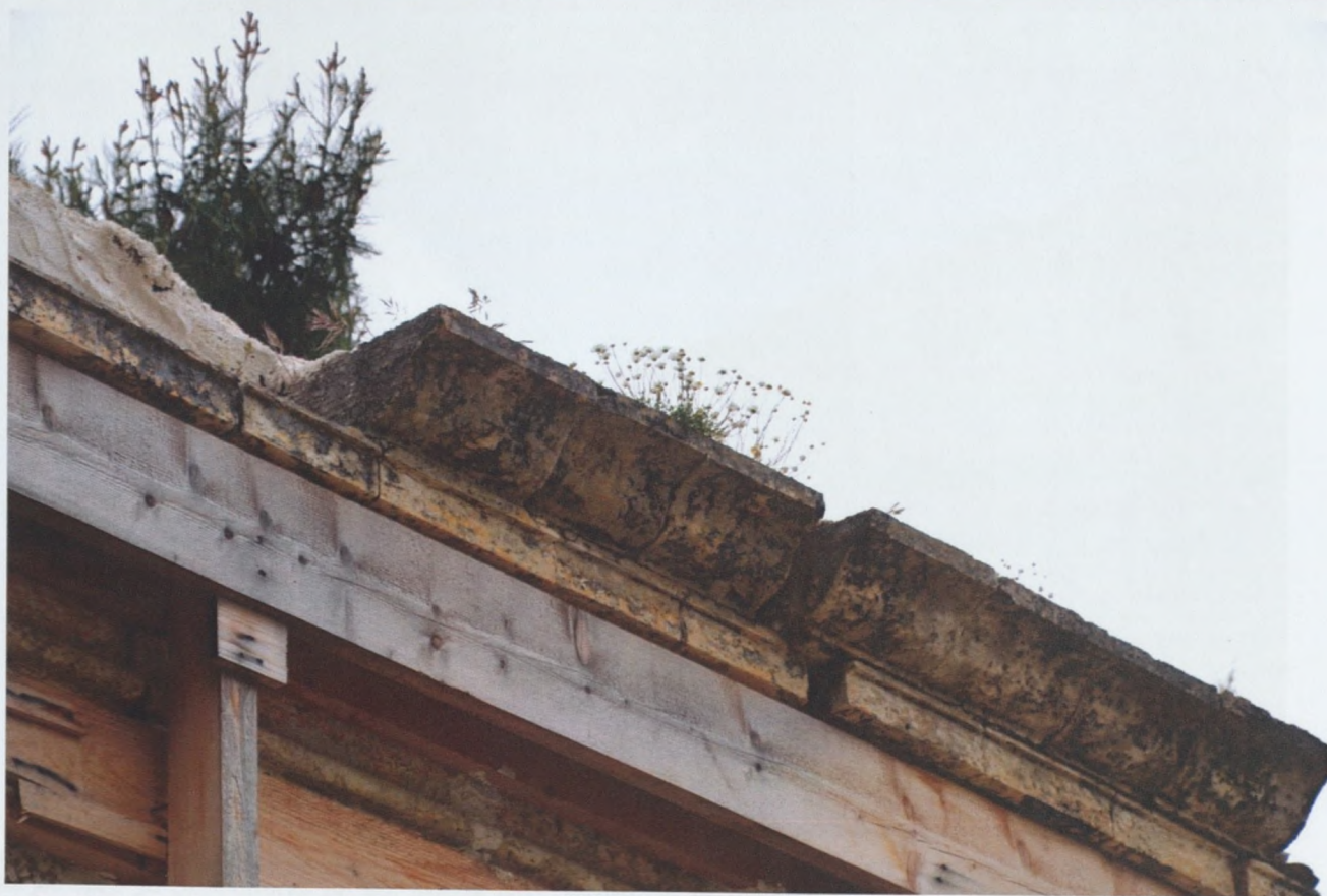
Εικόνα 18, 19: Λεπτομέρεια από το περίτεχνο γείσο της στέψης. Τα λίθινα τμήματα από τοπικό πωρόλιθο έχουν υποστεί επιφανειακή αλλοίωση από τους βιολογικούς παράγοντες, απώλεια υλικού από τη σεισμική δραστηριότητα του νησιού και μετατοπίσεις από μηχανικές καταπονήσεις των ριζών των αυτοφυών φυτών.
