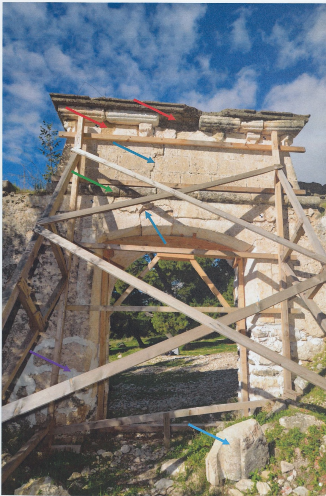
Εικόνα 11: Η τοξωτή θύρα της εισόδου – πίσω όψη. Μαύρες επικαθίσεις βιολογικών παραγόντων στα λίθινα εμφανή στοιχεία, απώλειες υλικού (γείσιποδες) κάτω από τη τσιμεντένια πλάκα, ρηγματώσεις και σύγχρονες ενισχυτικές προσθήκες για στατικούς λόγους, λίθινο τμήμα γείσου από τη στέγη πεσμένο στο έδαφος μετά από τη σεισμική δόνηση του 1953 από τη κατάρρευση της ΒΔ πλευράς.
