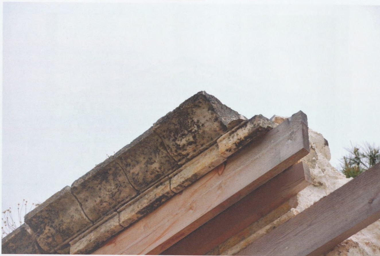
Εικόνα 20: Λεπτομέρεια του ιδίου γείσου από στη ΒΑ πλευρά του καθολικού. Απώλειες υλικού και κρούστα βιολογικών επικαθίσεων.
