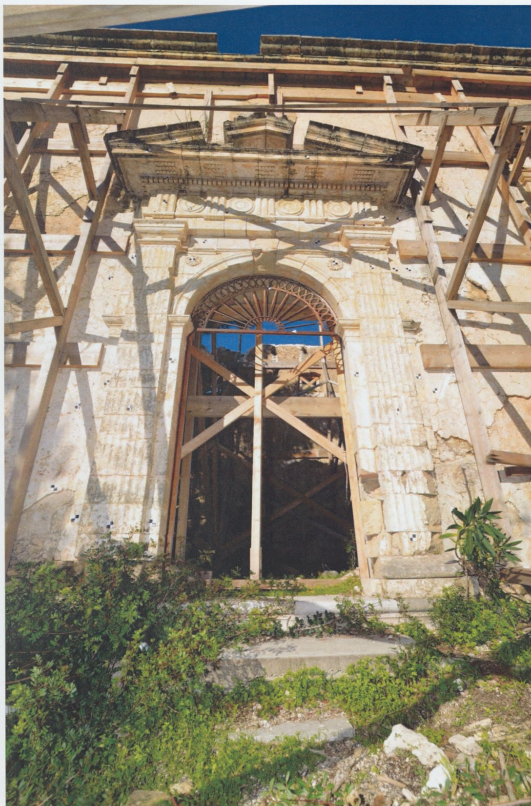
Εικόνα 51: Θύρα 02, διακρίνεται το σιδερένιο διάφραγμα με το στρώμα οξείδωσης (πορτοκαλί – καφέ απόχρωση) στο υπέρθυρο. Επίσης διακρίνονται ίχνη χρώματος στα δεξιά του.
