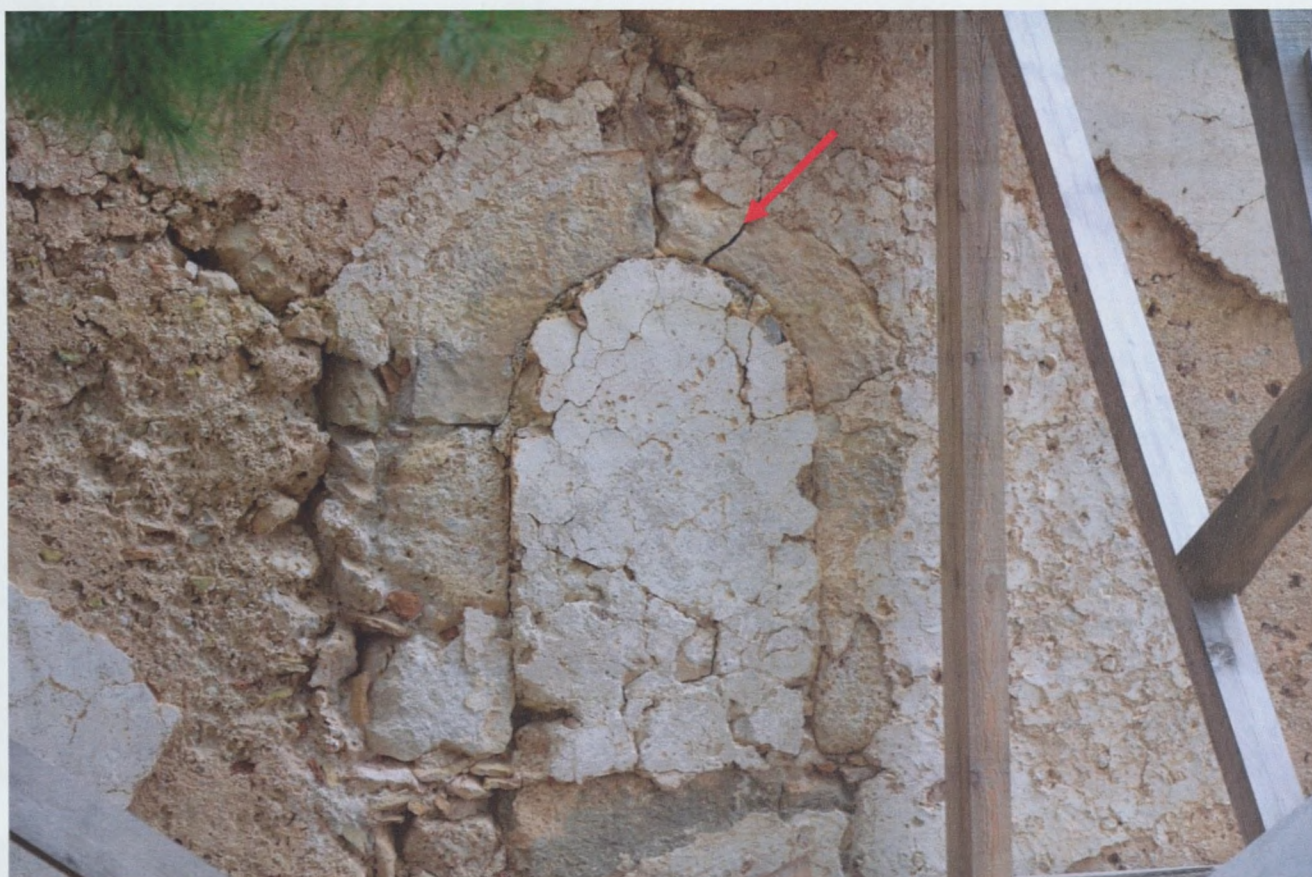
Εικόνα 15: Άνοιγμα Π1: Το μικρό αυτό άνοιγμα στη ΒΑ πλευρά του καθολικού έχει σφραγιστεί με λίθους και κονίαμα σε μεταγενέστερη φάση του μνημείου. Τα λίθινα στοιχεία του θυρώματος έχουν υπολείμματα επίχρσης και ο πάνω αριστερά τοξωτός λίθος φέρει ρήγμα από μηχανικές πιέσεις.
