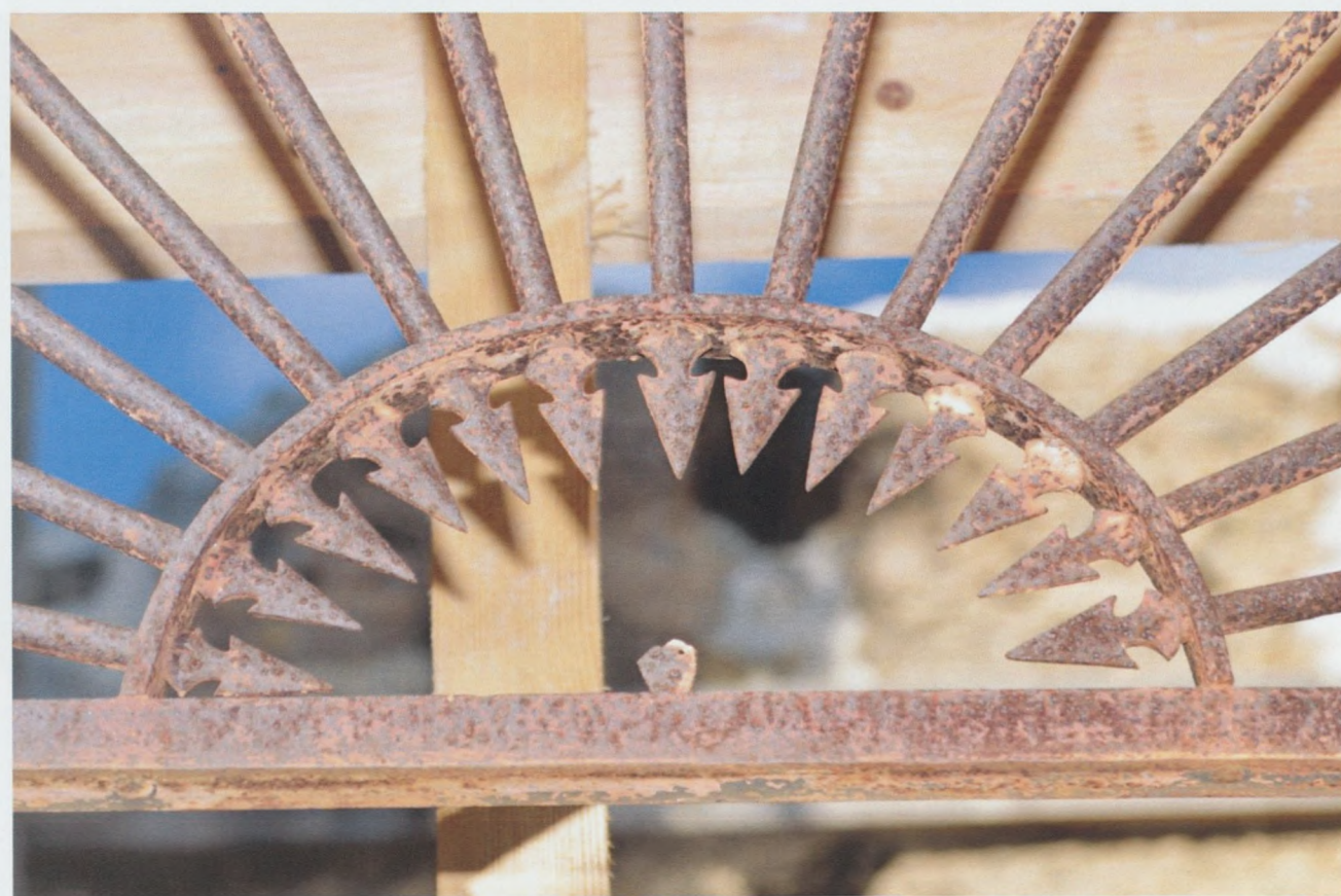
Εικόνα 53, 54: Θύρα 02, λεπτομέρειες από το σιδερένιο διάφραγμα του υπερθύρου. Διακρίνεται το στρώμα διάβρωσης των οξειδίων του σιδήρου και στρώμα από λευκό χρώμα στην φωτογραφία 26.
