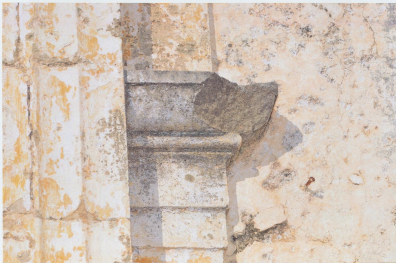
Εικόνα 17 Πάνω: φωλιά εντόμου κάτω από τους πρόμοχθους του αετώματος. Κάτω: Απώλεια επικράνου μικρής παραστάδας στην αριστερή πλευρά της θύρας πιθανότατα από πτώση υπερκείμενου δομικού στοιχείου.
