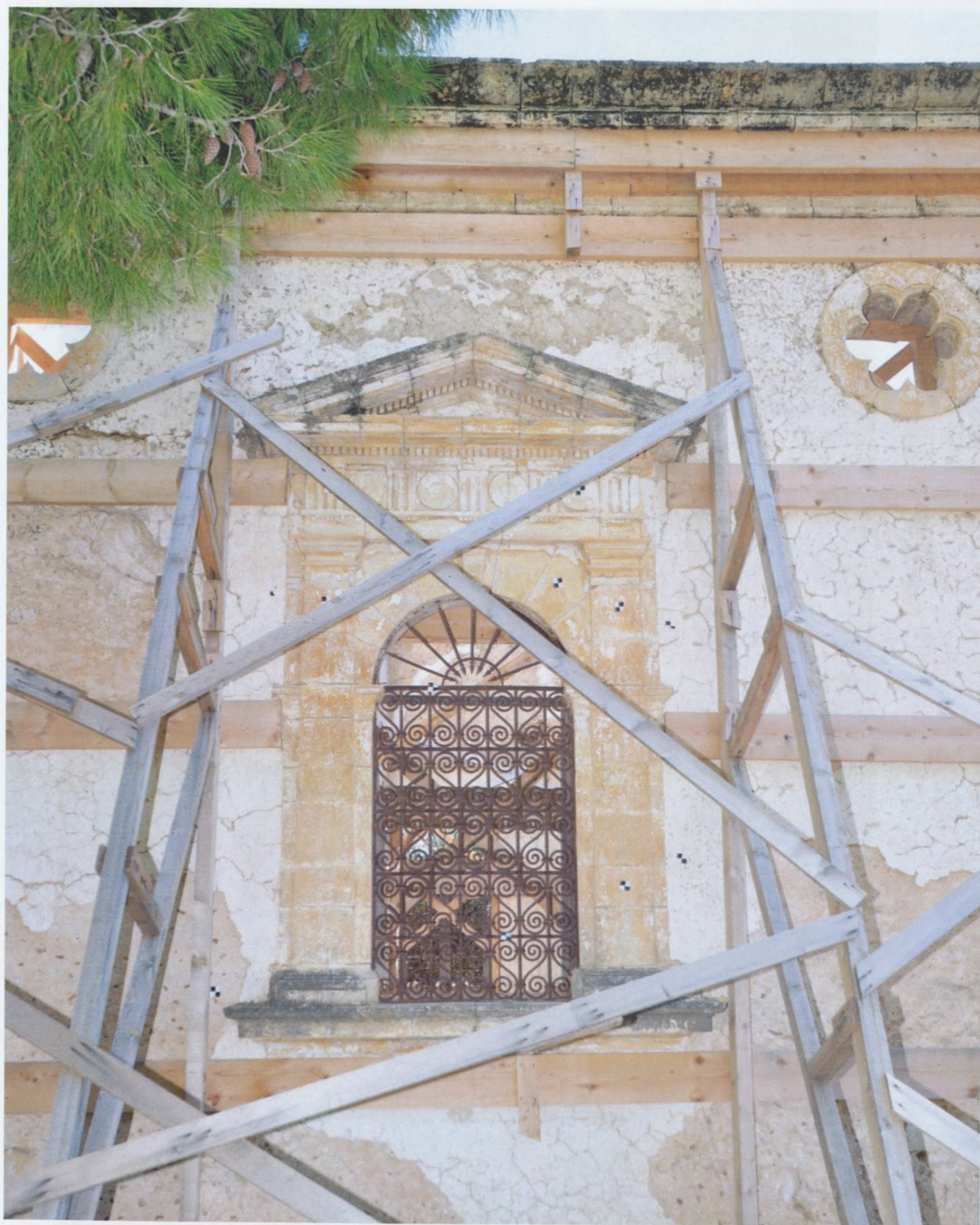
Εικόνα 52: Άνοιγμα Π2, διακρίνεται το σιδερένιο διάφραγμα με το στρώμα οξείδωσης (πορτοκαλί – καφέ απόχρωση).
