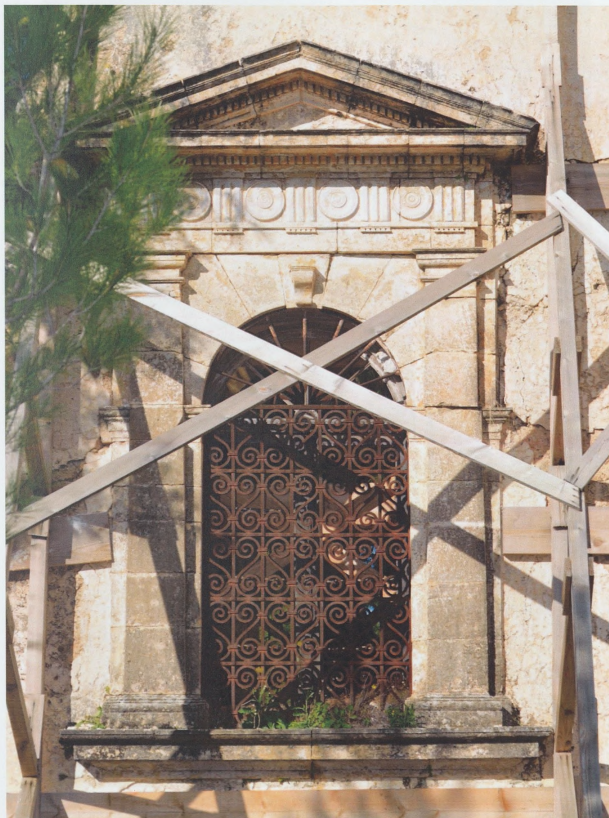
Εικόνα 49: Άνοιγμα Π4, διακρίνεται το σιδερένιο διάφραγμα με το στρώμα οξείδωσης (πορτοκαλί – καφέ απόχρωση).
