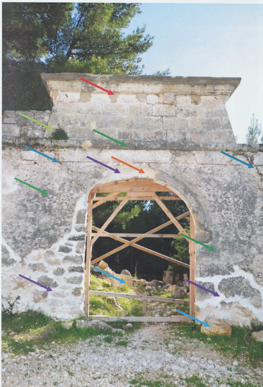
Εικόνα 10: Η τοξωτή θύρα της εισόδου στον αύλιο χώρο της μονής. Μαύρες επικαθίσεις βιολογικών παραγόντων στα λίθινα εμφανή στοιχεία, απώλειες υλικού (γεισίποδες) κάτω από τη τσιμεντένια πλάκα και απώλειες λίθων από το τοξωτό θύρωμα της εισόδου, ρηγματώσεις και σύγχρονες ενισχυτικές προσθήκες για στατικούς λόγους, λίθοι πεσμένοι στο έδαφος μετά από τη σεισμική δόνηση του 1953 και όχι μόνο, αυτοφυή φυτά ... σε ανάπτυξη.
