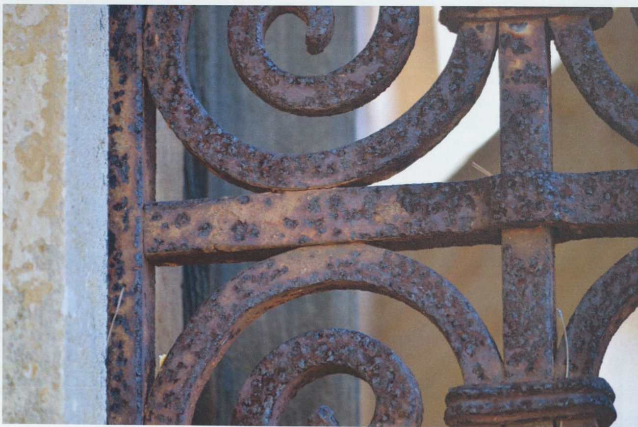
Εικόνα 55, 56: Άνοιγμα Π2, λεπτομέρειες από το σιδερένιο διάφραγμα του υπερθύρου. Διακρίνεται το στρώμα διάβρωσης των οξειδίων του σιδήρου με χρώμα πορτοκαλί - καφέ.
