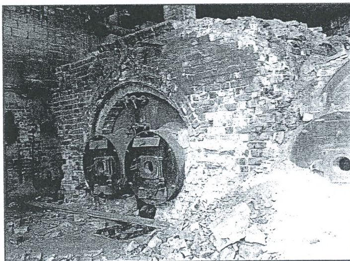
Αποψη των ατμολεβήτων που βρίσκονται στο κτίριο 16.
