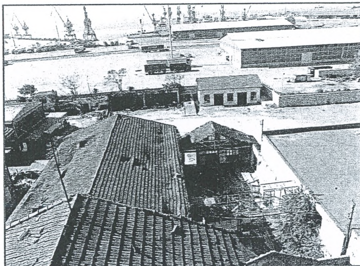
Αποψη των στεγών των κτιρίων 10 και 11, όπου διακρίνονται οι φθορές και η τμηματική κατάρρευση τους.
