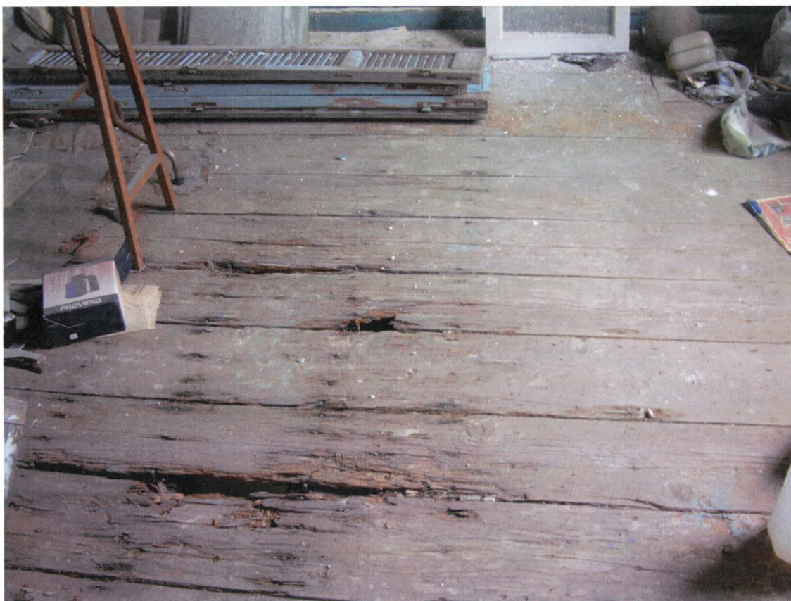
25. ΦΘΟΡΕΣ ΣΤΟ ΞΥΛΙΝΟ ΔΑΠΕΔΟ ΤΟΥ ΙΣΟΓΕΙΟΥ
