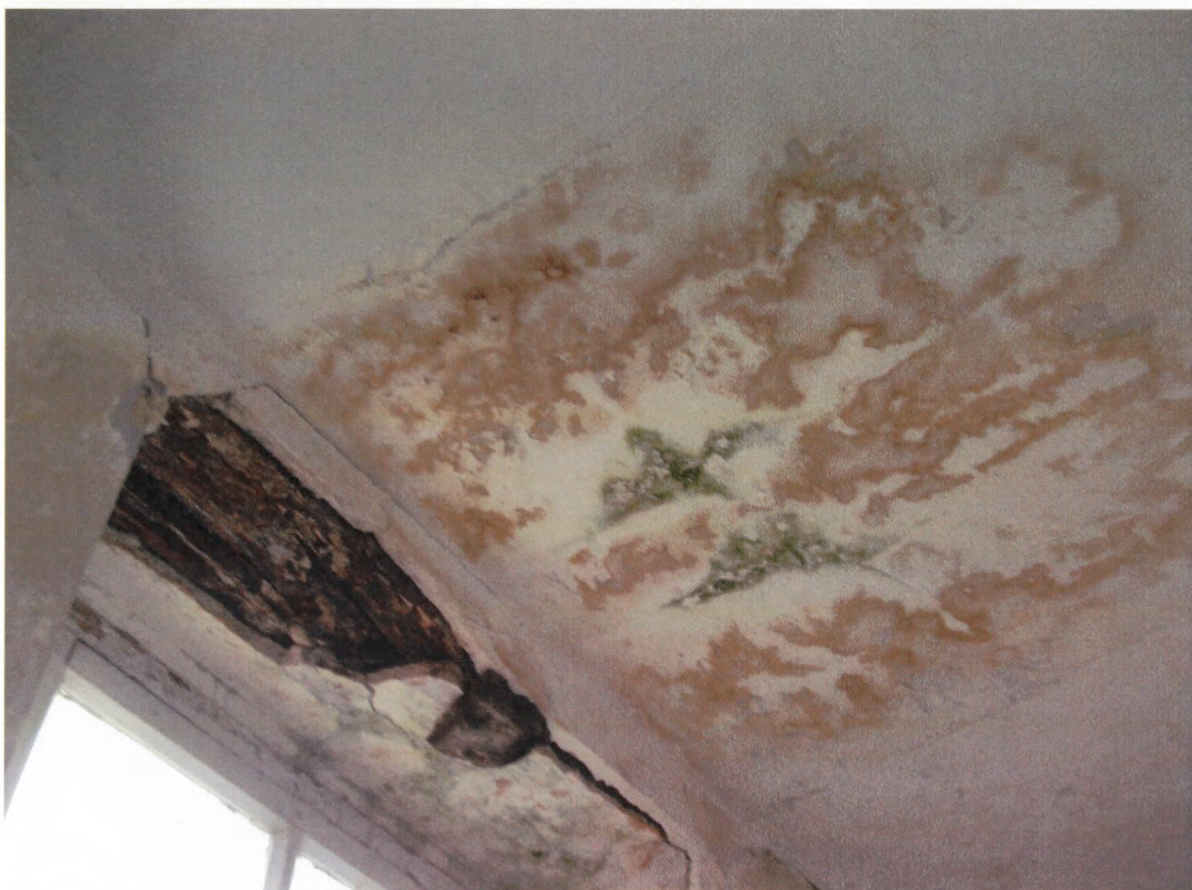
38. ΦΘΟΡΕΣ ΣΤΗΝ ΟΡΟΦΗ ΟΡΟΦΟΥ
