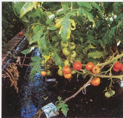
Σύστημα Φυτοκαθαρισμού αστικών λυμάτων.
