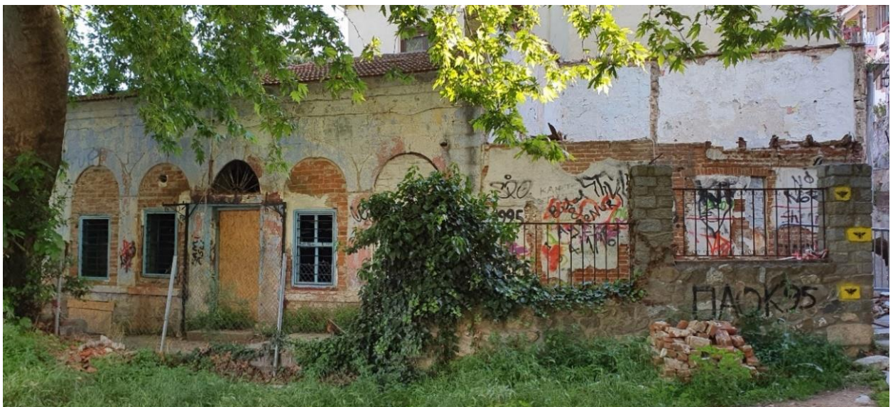
Φ64. (2021) Ο όροφος του γωνιακού κτίσματος, λόγω στατικών προβληματικών προβλημάτων, έχει πλέον κατεδαφιστεί.
