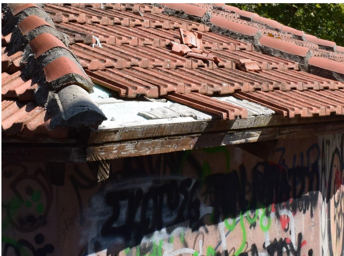
Φ18. (2021) Φθορές του συστήματος επικάλυψης της στέγης.
