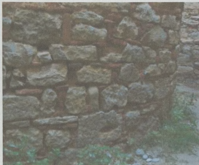
Εικ.31. Α. όψη Απώλεια κονιάματος στη κάτω ζώνη της τοιχοποιίας
