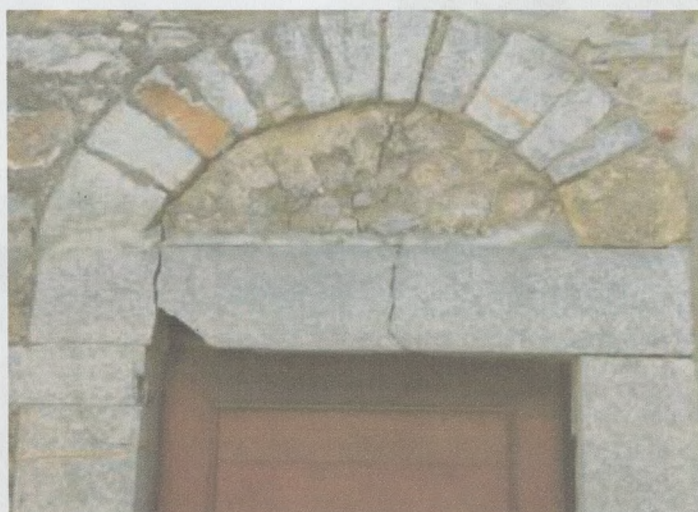
Εικ. 38, Οι θραύσεις στο υπέρθυρο της Νότιας όψης λόγω βλαβών στον τοίχο.
