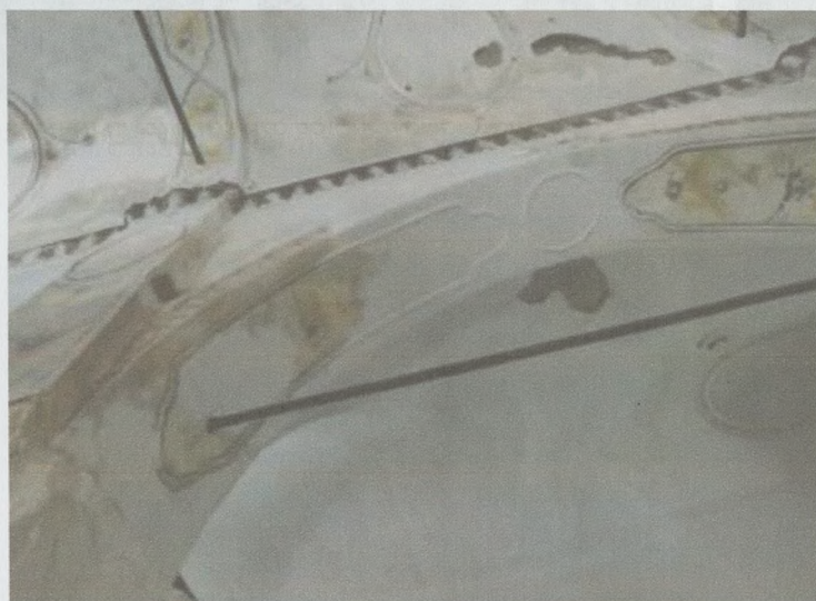
Εικ.36, Άποψη εσωτερικά του ναού όπου φαίνονται οι φθορές στο ζωγραφικό διάκοσμο και τα επιχρίσματα.
