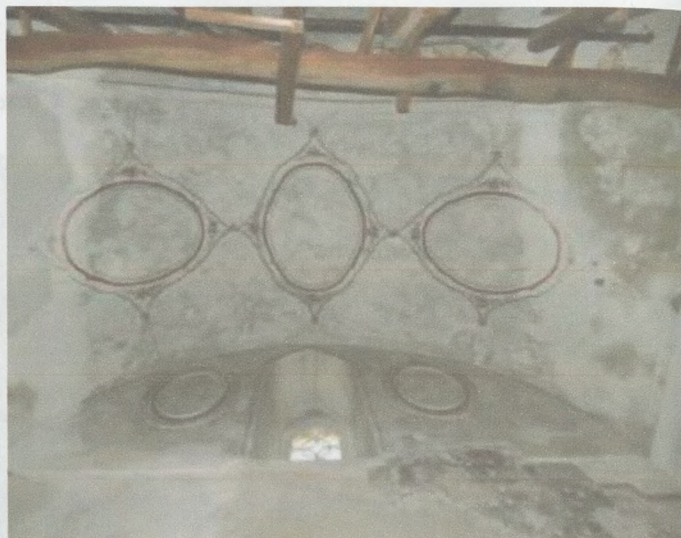
Εικ. 35, Άποψη από το εσωτερικό του ναού όπου εμφανίζονται σκούρες κηλίδες λόγω υγρασίας.
