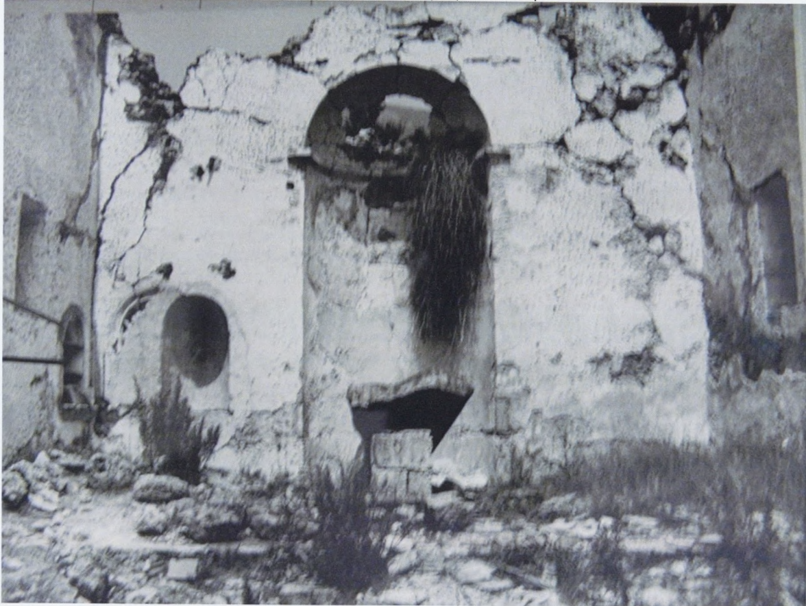
Φωτ. 5. Αποψη εσωτερικό Ναού, Ιερό, μετά τον καταστροφικό σεισμό του 1953
