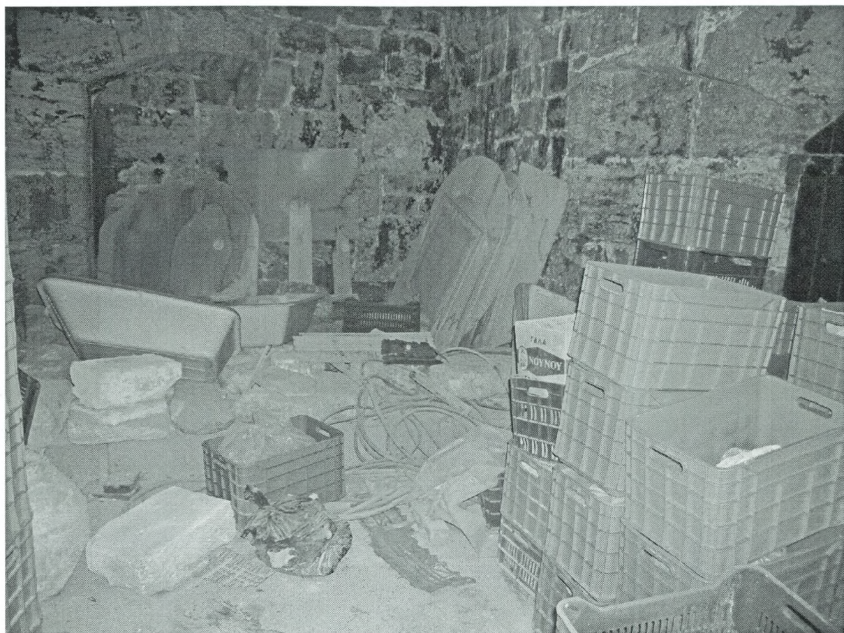
Ενδεικτική κατάσταση διατήρησης κάποιων από τους εσωτερικούς χώρους του φρουρίου που χρησιμοποιούνται ως πρόχειρες αποθήκες.
