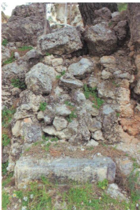
11. ΛΙΘΟΣ ΑΠΟ ΤΗ ΛΑΞΕΥΤΗ ΤΟΙΧΟΔΟΜΗ ΤΗΣ ΝΔ ΓΩΝΙΑΣ ΤΟΥ ΚΤΗΡΙΟΥ.
