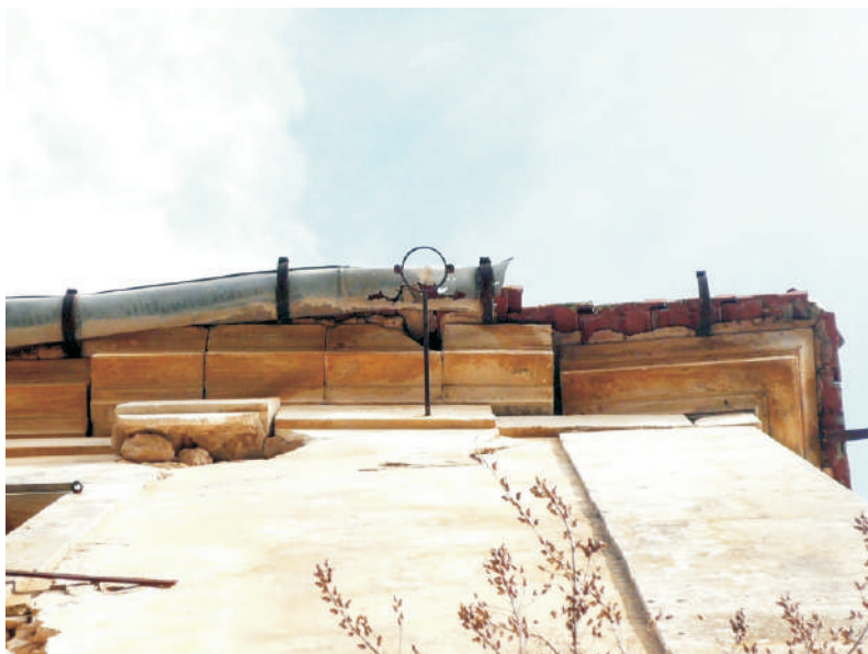
ΦΩΤΟ 3.6.2.4 ΜΕΤΑΤΟΠΙΣΕΙΣ ΤΜΗΜΑΤΩΝ ΤΗΣ ΖΩΦΟΡΟΥ ΚΑΙ ΤΟΥ ΓΕΙΣΟΥ ΣΤΗΝ ΝΟΤΙΟΑΝΑΤΟΛΙΚΗ ΓΩΝΙΑ ΤΟΥ ΚΤΙΡΙΟΥ.
