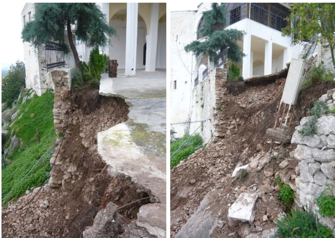
Εικ. 2-3. Λεπτομέρειες της περιοχής μετά την κατάρρευση του αναλημματικού τοίχου βορειοανατολικά της εισόδου (15 Νοεμβρίου 2009).
