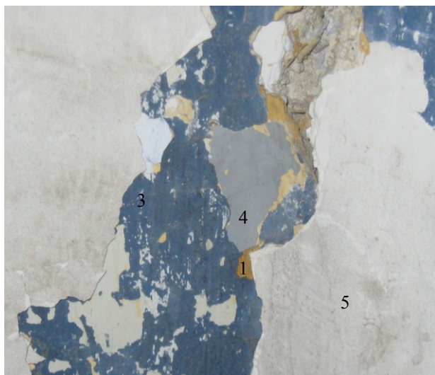
Εικόνα 15 Δείγμα από το νότιο τοίχο της κουζίνας.
