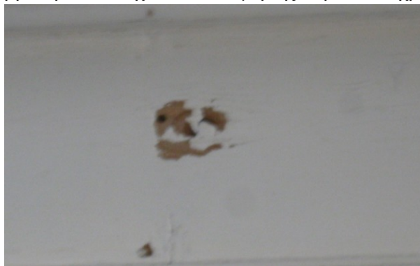
Εικόνα 20 Δείγμα από την οροφή του χώρου του κλιμακοστασίου.
