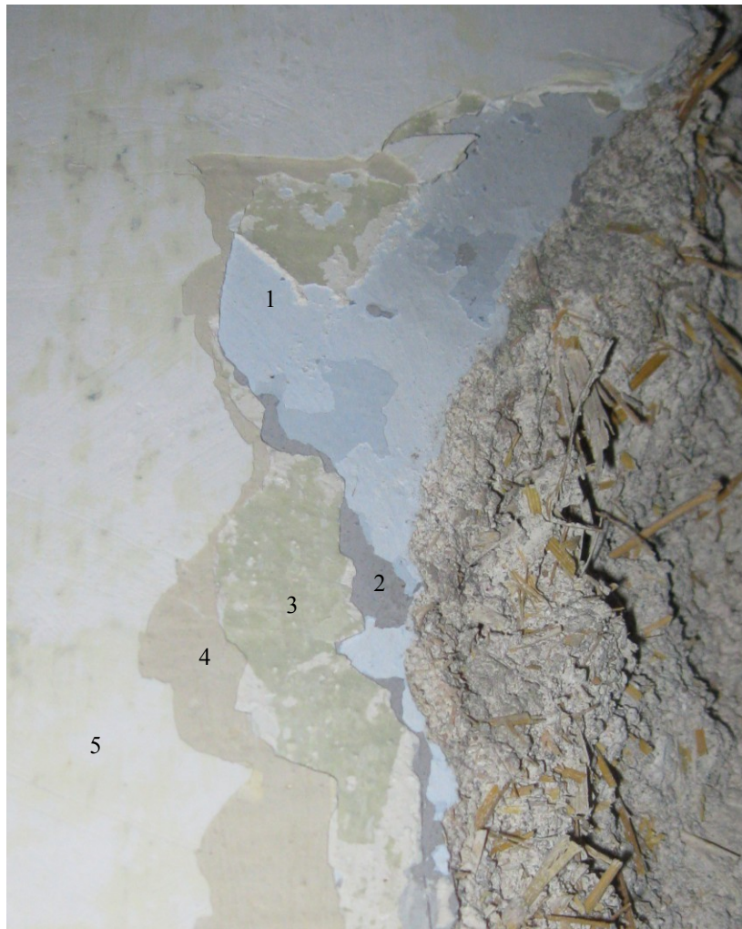
Εικόνα 29 Δείγμα από το βόρειο τοίχο του ΝΔ δωματίου.
