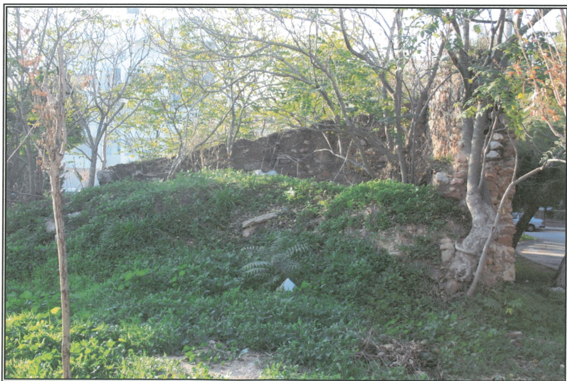
Τμήμα του περιτοιχίσματος και κελλιών - διακρίνεται ο όγκος υλικών από προσπάθειες κατεδάφισης
