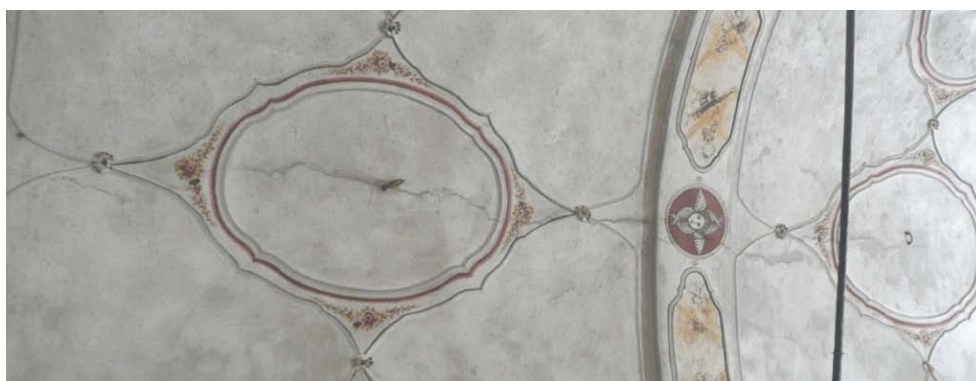
Εικ. 3.3: Ρηγμάτωση στην κλείδα της θολοδομίας - νότιο κλίτος
