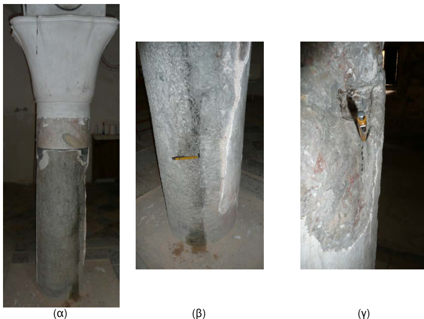
Εικ. 3.6 : Κίονας Κ3: (α) Ν όψη (β) & (γ) Απώλεια υλικού και ρηγμάτωση στη ΝΑ όψη
