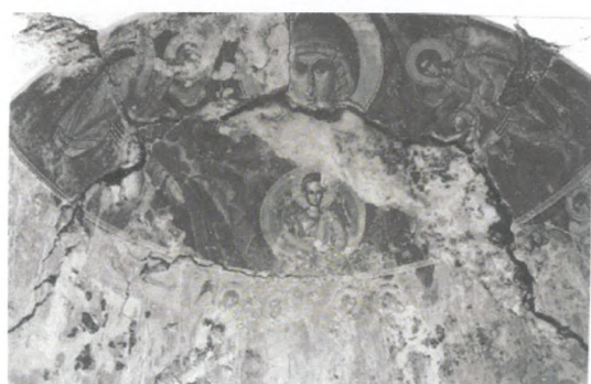
Εικ. 67 Ρωγμή στο τεταρτοσφαίριο της κόγχης του ιερού (1970-1980). Από το αρχείο του Κοργιαλενείου Ιδρύματος.
