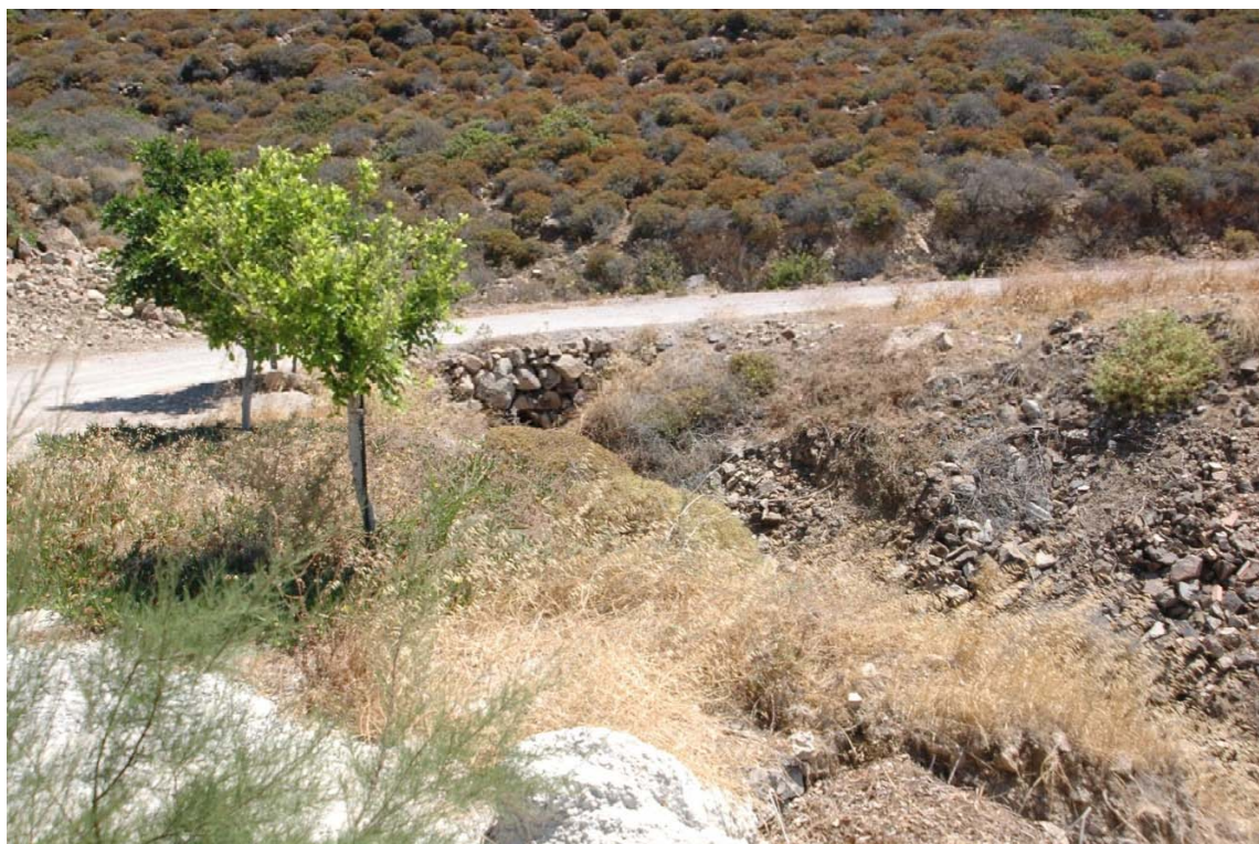
Εικ. 12. Περιοχή Γ. Αναλημματικός τοίχος με παλαιό αγωγό απορροής ομβρίων.
