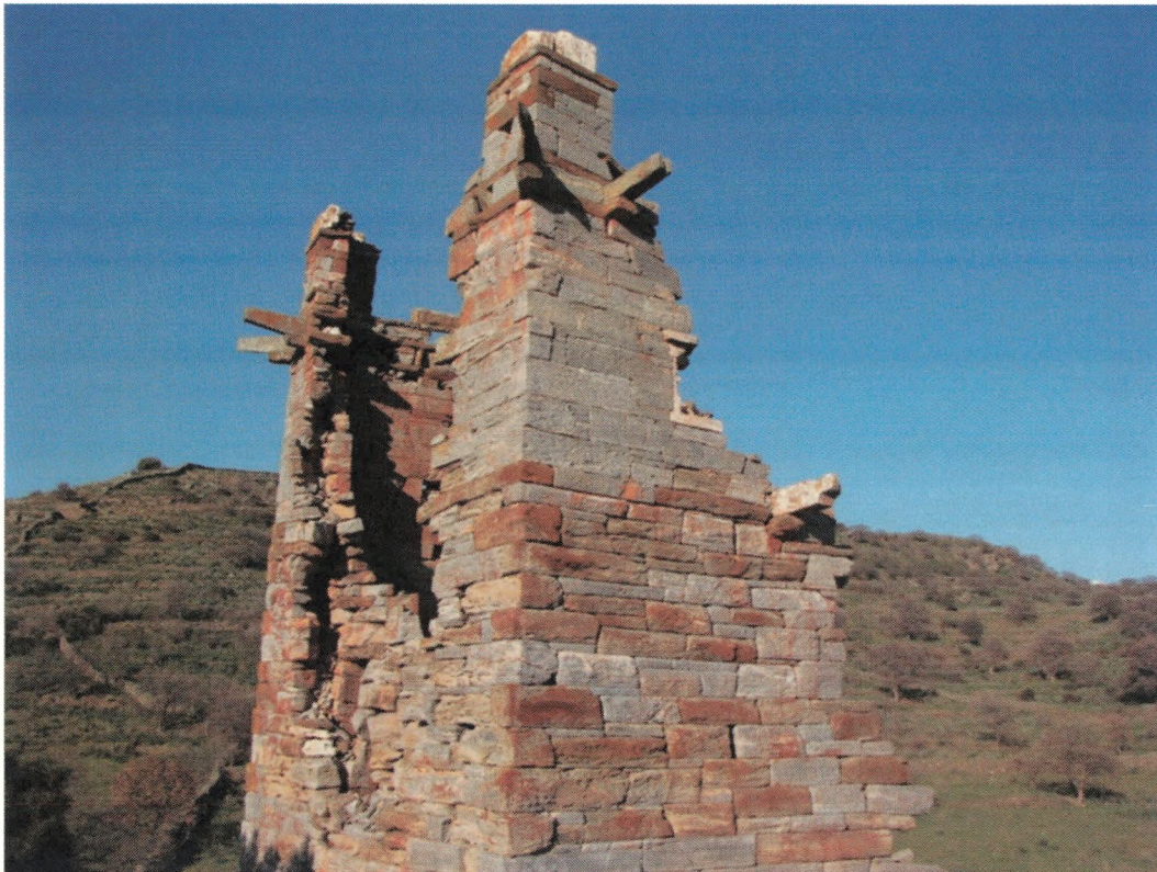
Εικ. 42. Άποψη από ΝΔ. Έντονη αποκόλληση των δυο πλευρών του δυτικού τοίχου στη ΒΔ γωνία.
