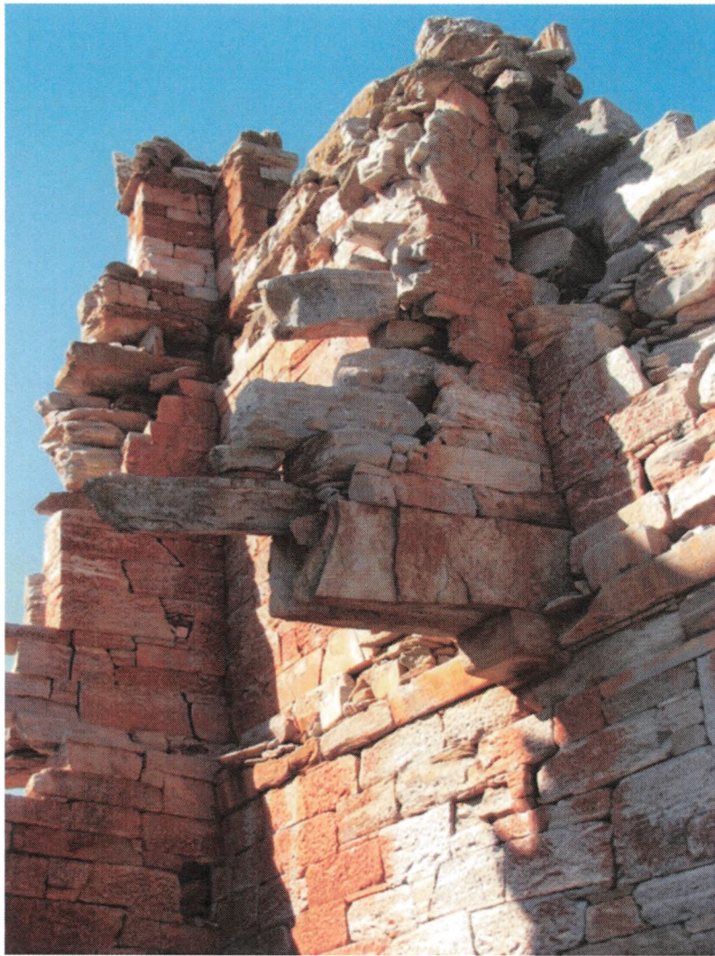
Εικ. 36. Ο μεσότοιχος του Γ' ορόφου, που παρασύρει το βόρειο τοίχο προς το εσωτερικό του πύργου.
