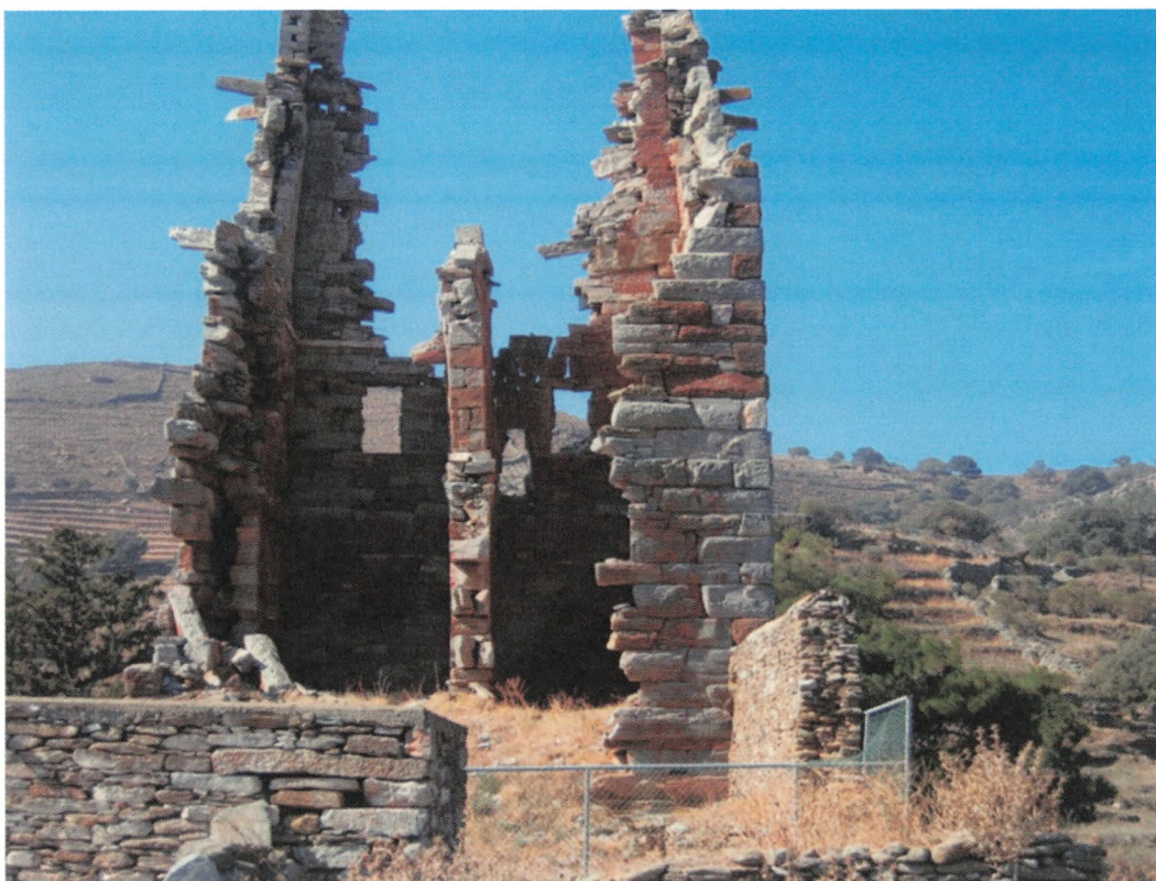
Εικ. 18. Άποψη του πύργου από Α., πριν από την κατάρρευση του μεσότοιχου του Β' ορόφου (Φωτογραφία 28/10/2005).
