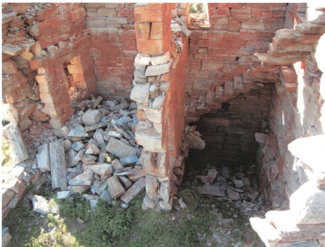
Εικ. 50. Ο ερειπωμένος μεσότοιχος και οι πεσμένοι λίθοι στο νότιο διαμέρισμα.
