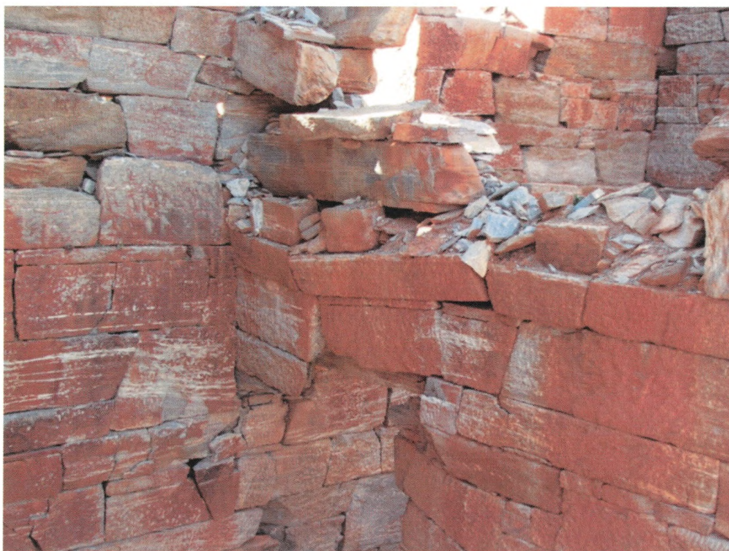
Εικ. 53. Λεπτομέρεια του θραυσμένου και έντονα παραμορφωμένου ανωφλίου του προς Δ. ανοίγματος του μεσότοιχου.
