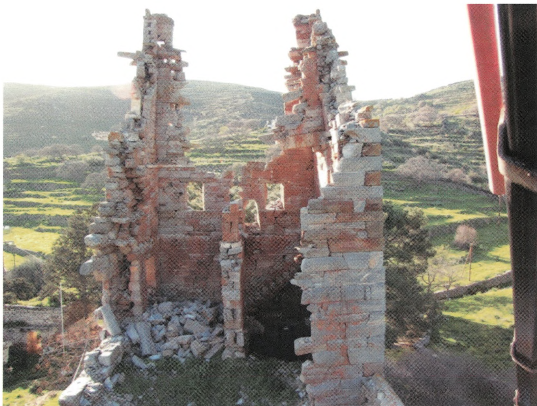
Εικ. 34. Η παραμόρφωση του άνω τμήματος του βόρειου τοίχου και η αντίστοιχη στροφή του κρεμάμενου ερειπωμένου μεσότοιχου του Γ' ορόφου προς το εσωτερικό του πύργου.
