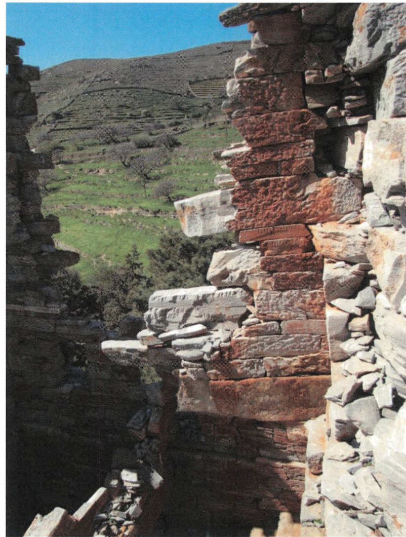
Εικ. 37. Λεπτομέρεια της αποκόλλησης του μεσότοιχου από το βόρειο τοίχο.
