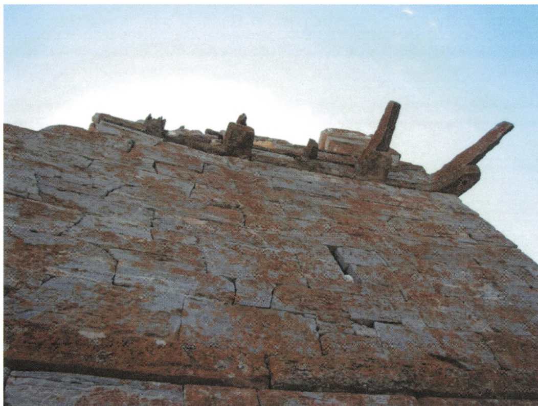
Εικ. 32. Το άνω τμήμα του βόρειου τοίχου με την μεγάλη παραμόρφωση – καμπύλωση της εξωτερικής παρειάς.
