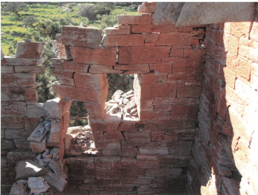
Εικ. 43. Εσωτερική πλευρά του δυτικού τοίχου. Κύρτωση προς το εσωτερικό.
