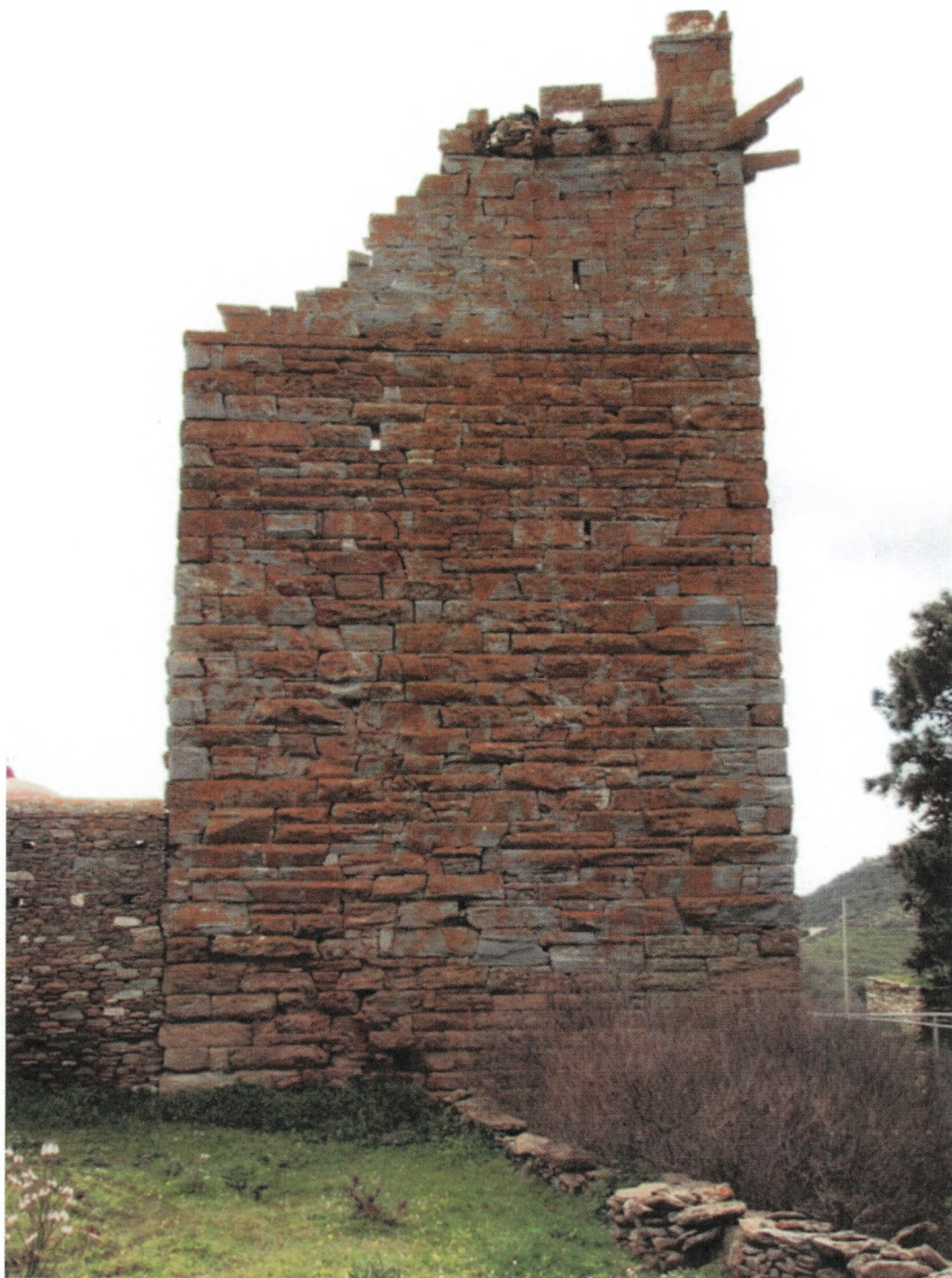
Εικ. 7. Άποψη του πύργου από Β. Η βόρεια πλευρά έχει τη μεγαλύτερη πληρότητα, αλλά και το σοβαρότερο πρόβλημα ετοιμορροπίας λόγω εκτροπής του τοίχου πάνω από τη στάθμη του γεισώματος με τους λίθους μικρού ύψους. Διακρίνονται οι τοξοθυρίδες, οι πρόβολοι της οροφής του Γ' ορόφου και ο γωνιακός πεσσός στην ανώτατη στάθμη.
