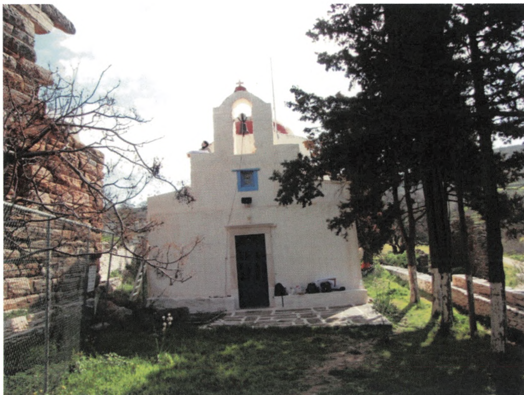
Εικ. 10. Ο ιερός ναός της αγίας Μαρίνας. Το καθολικό της ομώνυμης μονής. Μεταξύ του πύργου και της εκκλησίας διακρίνονται οι λίθοι που κατέπεσαν το 2005 από το νότιο τοίχο.
