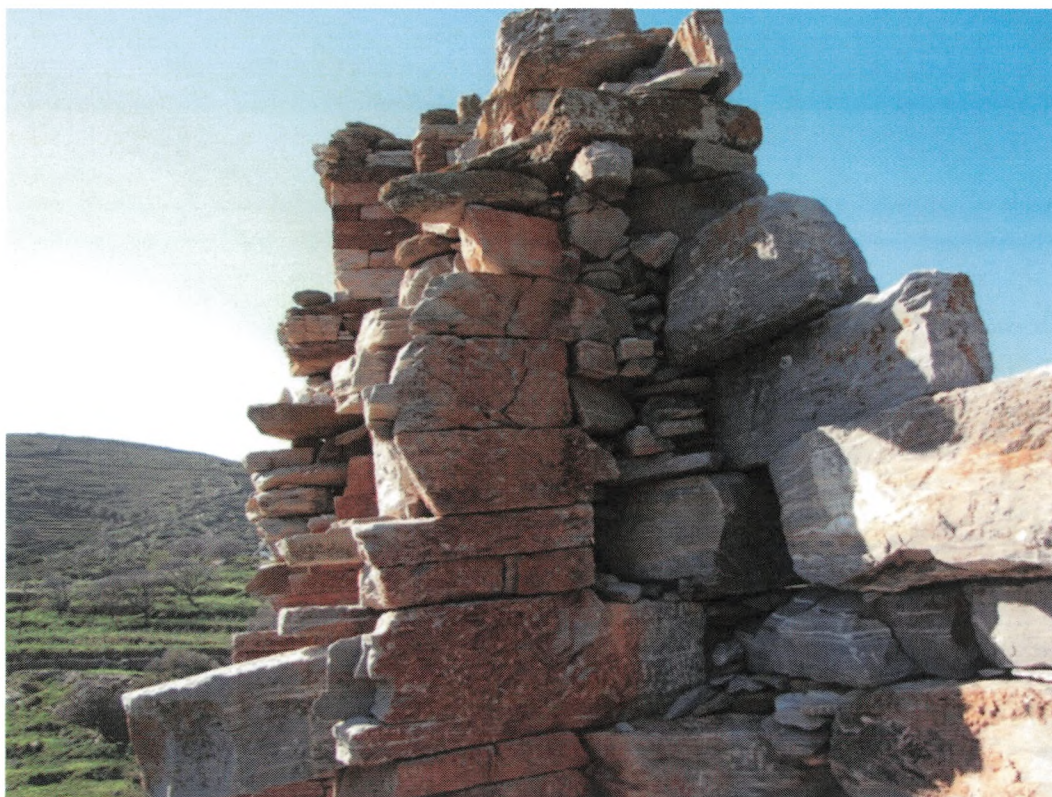
Εικ. 38. Λεπτομέρεια της αποκόλλησης του μεσότοιχου από το βόρειο τοίχο.
