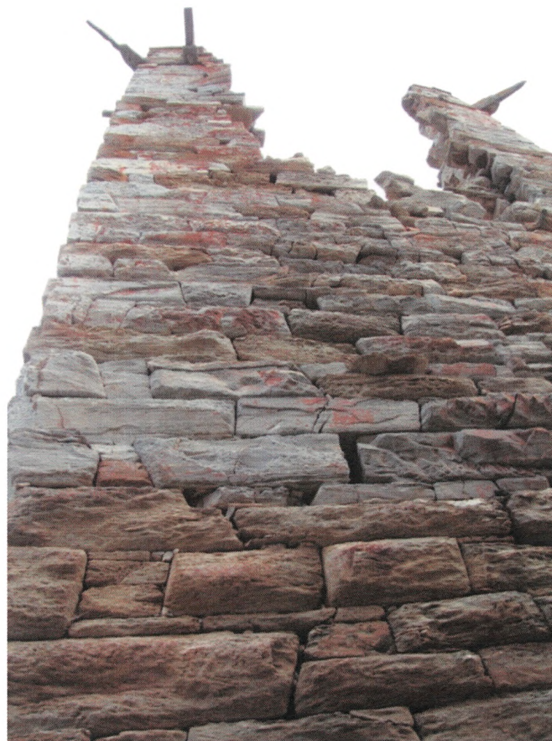
Εικ. 41. Ο δυτικός τοίχος του πύργου. Αποκόλληση των δυο πλευρών της τοιχοποιίας.
