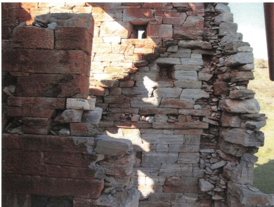
Εικ. 48. Στη ΒΑ γωνία του πύργου έχει καταρρεύσει πλήρως η εσωτερική πλευρά και διακρίνεται ο πυρήνας του τοίχου με τις λατύπες.
