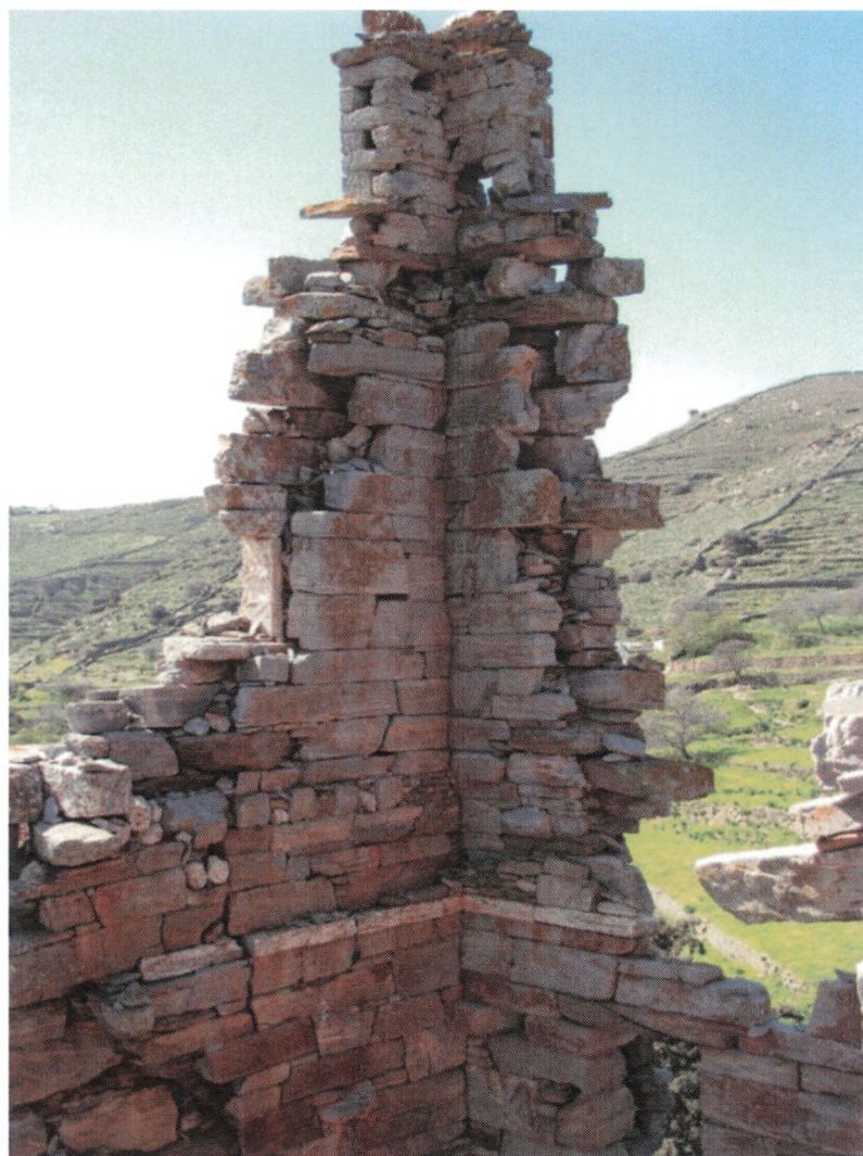
Εικ. 40. Η ΝΔ γωνία του πύργου. Στα όρια της ερείπωσης οι δυο πλευρές της τοιχοποιίας έχουν αποκολληθεί.
