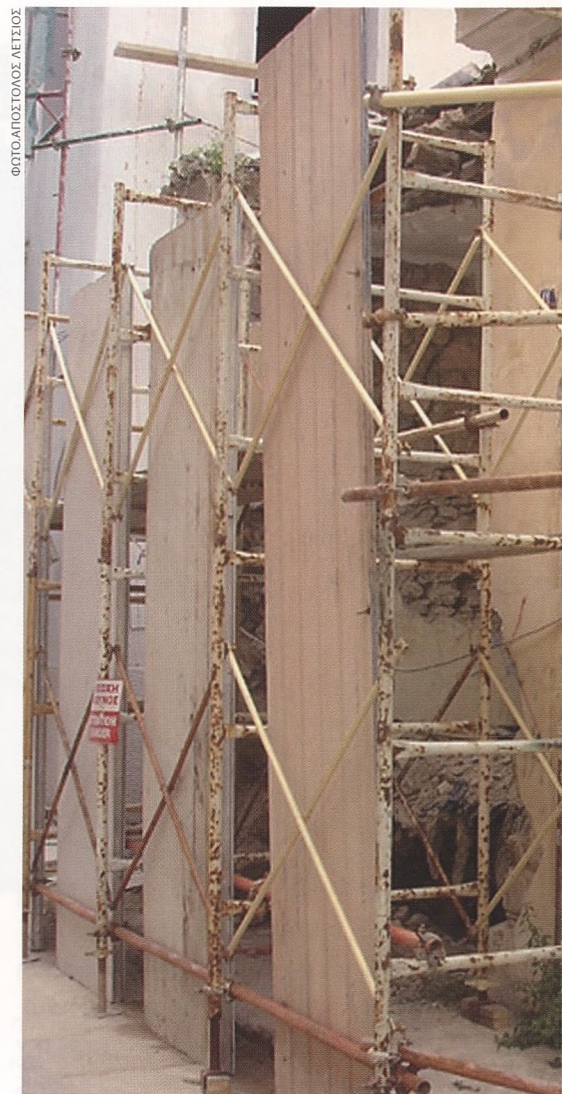
Το διατηρητέο της Κυρρήστου 11 στην Πλάκα μετά την κατάρρευση της πρόσοψης.
