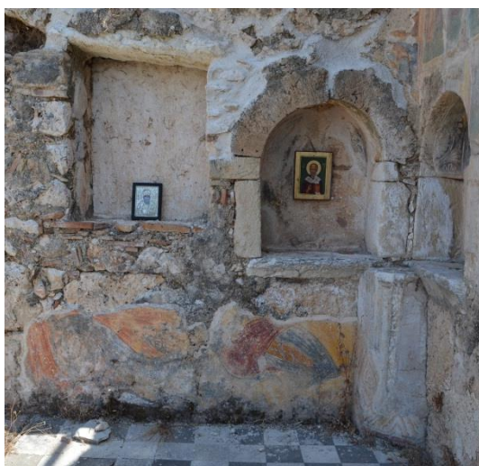
Εικ. 67 Η βόρεια κόγχη του ιερού και το ανατολικό παράθυρο του βόρειου τοίχου. Διακρίνονται τα κονιάματα επισκευής των ρωγμών.
