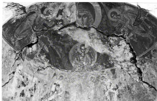
Εικ. 54 Ρωγμή στο τεταρτοσφαίριο της κόγχης του ιερού (1970-1980). Από το αρχείο του Κοργιαλενείου Ιδρύματος.
