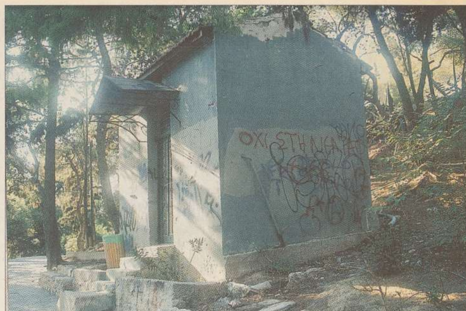
Οι ζημιές είναι εμφανείς σε αρκετές από τις υποδομές στον λόφο του Στρέφη, όπως στο εικονιζόμενο μικρό περίπτερο που βρίσκεται στην είσοδο του πάρκου
