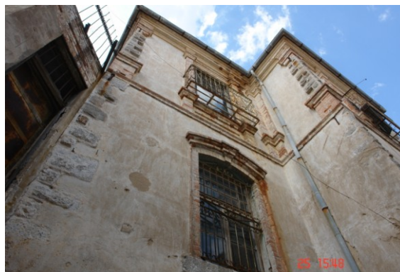
Μαύρη κρούστα, λεκέδες από οξείδωση μεταλλικών στοιχείων, προηγούμενες επεμβάσεις συντήρησης, ατμοσφαιρικοί ρύποι και απώλειες ασβεστοκονιαμάτων και ξύλινου υλικού στην πλάγια όψη του κτιρίου.
