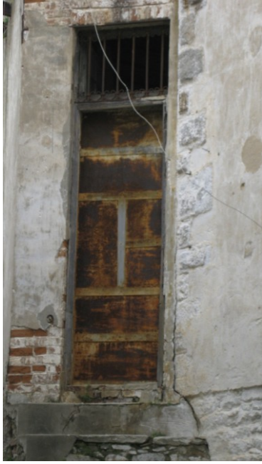
Μαύρη κρούστα, οξείδωση μεταλλικών στοιχείων, προηγούμενες επεμβάσεις συντήρησης, ατμοσφαιρικοί ρύποι και απώλειες ασβεστοκονιαμάτων στην πλάγια όψη του κτιρίου.
