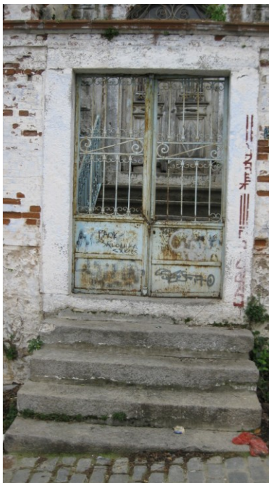
Οξείδωση μεταλλικών στοιχείων, προηγούμενες επεμβάσεις συντήρησης, ατμοσφαιρικοί ρύποι, βιολογικές επικαθίσεις, graffiti's και απώλειες ασβεστοκονιαμάτων στη μεταλλική πόρτα της αυλής.
