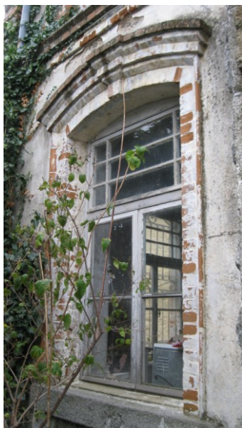
Μαύρη κρούστα, προηγούμενες επεμβάσεις συντήρησης, ατμοσφαιρικοί ρύποι, βιολογικές επικαθίσεις και απώλειες ασβεστοκονιαμάτων και ξύλινου υλικού στην πρόσοψη του κτιρίου.
