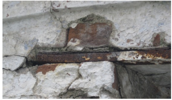
Οξείδωση μεταλλικών στοιχείων, ατμοσφαιρικοί ρύποι και απώλειες ασβεστοκονιαμάτων στη πίσω όψη της μεταλλικής πόρτας της αυλής.
