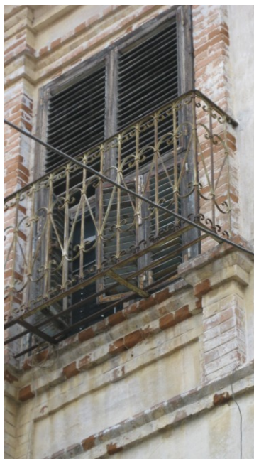
Μαύρη κρούστα, λεκέδες από οξείδωση μεταλλικών στοιχείων, προηγούμενες επεμβάσεις συντήρησης, ατμοσφαιρικοί ρύποι και απώλειες ασβεστοκονιαμάτων και ξύλινου υλικού στην πλάγια όψη του κτιρίου.
