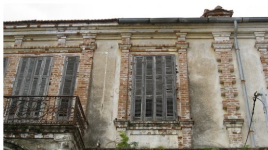
Μαύρη κρούστα, λεκέδες από οξείδωση μεταλλικών στοιχείων, προηγούμενες επεμβάσεις συντήρησης, ατμοσφαιρικοί ρύποι, βιολογικές επικαθίσεις και απώλειες ασβεστοκονιαμάτων και ξύλινου υλικού στην πρόσοψη του κτιρίου.
