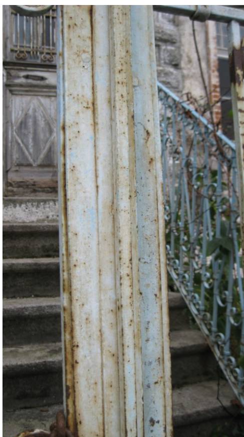
Οξείδωση του μετάλλου και απώλειες βαφής στα κιγκλιδώματα της αυλής.
