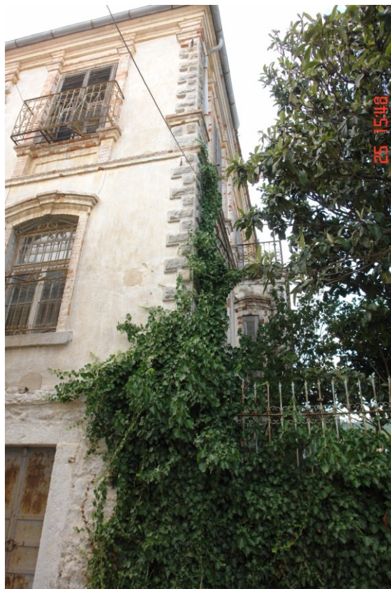
Μαύρη κρούστα, λεκέδες από οξείδωση μεταλλικών στοιχείων, προηγούμενες επεμβάσεις συντήρησης, ατμοσφαιρικοί ρύποι και απώλειες ασβεστοκονιαμάτων σε πλάγια όψη του κτιρίου.
