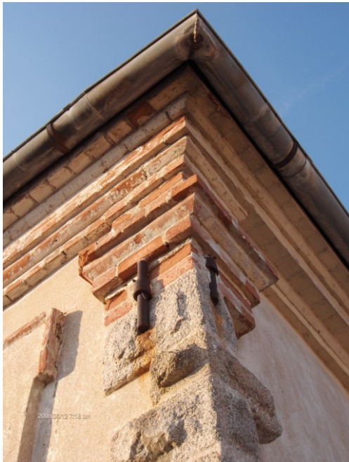
Μαύρη κρούστα, λεκέδες από οξείδωση μεταλλικών στοιχείων, προηγούμενες επεμβάσεις συντήρησης, ατμοσφαιρικοί ρύποι και απώλειες ασβεστοκονιαμάτων σε πλάγια όψη του κτιρίου.
