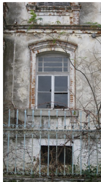
Μαύρη κρούστα, λεκέδες από οξείδωση μεταλλικών στοιχείων, προηγούμενες επεμβάσεις συντήρησης, ατμοσφαιρικοί ρύποι, βιολογικές επικαθίσεις και απώλειες ασβεστοκονιαμάτων και ξύλινου υλικού στην πρόσοψη του κτιρίου.
