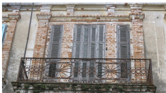
Μαύρη κρούστα, λεκέδες από οξείδωση μεταλλικών στοιχείων, προηγούμενες επεμβάσεις συντήρησης, ατμοσφαιρικοί ρύποι, βιολογικές επικαθίσεις και απώλειες ασβεστοκονιαμάτων και ξύλινου υλικού στην πρόσοψη του κτιρίου.
