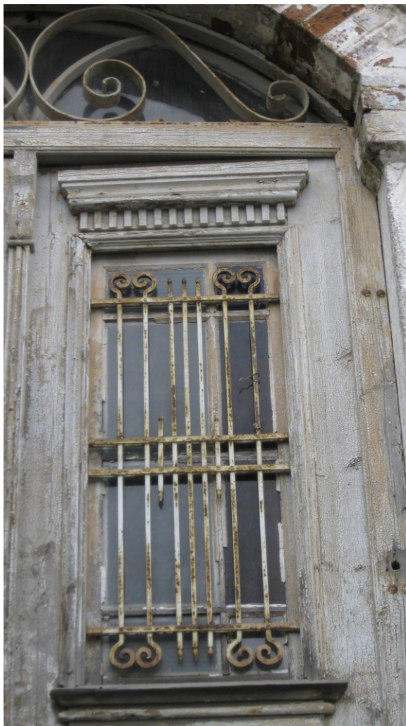
Απώλεια βαφής, μαύρη κρούστα, απώλεια ξύλινου υλικού, οξείδωση μεταλλικών στοιχείων και ίχνη δυο χρωμάτων βαφής σε λεπτομέρεια της κεντρικής πόρτας.
