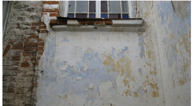
Μαύρη κρούστα, προηγούμενες επεμβάσεις συντήρησης, ατμοσφαιρικοί ρύποι, απώλειες ασβεστοκονιαμάτων και ίχνη διαφορετικών χρωμάτων βαφής στη πίσω όψη του κτιρίου.
