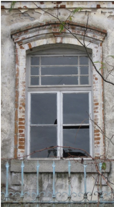
Μαύρη κρούστα, οξείδωση μεταλλικών στοιχείων, προηγούμενες επεμβάσεις συντήρησης, ατμοσφαιρικοί ρύποι, βιολογικές επικαθίσεις και απώλειες ασβεστοκονιαμάτων και ξύλινου υλικού στην πρόσοψη του κτιρίου.
