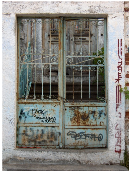
Οξείδωση μεταλλικών στοιχείων, προηγούμενες επεμβάσεις συντήρησης, ατμοσφαιρικοί ρύποι, graffiti's και απώλειες ασβεστοκονιαμάτων στη μεταλλική πόρτα της αυλής.
