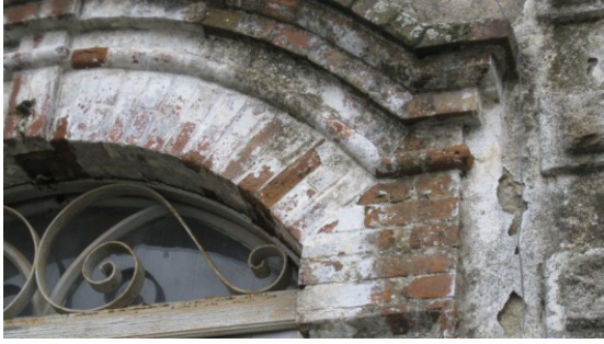
Απώλεια βαφής, μαύρη κρούστα, απώλεια ασβεστοκονιάματος και οξείδωση μεταλλικών στοιχείων σε λεπτομέρεια της κεντρικής πόρτας.
