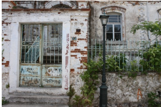
Μαύρη κρούστα, προηγούμενες επεμβάσεις συντήρησης, ατμοσφαιρικοί ρύποι, βιολογικές επικαθίσεις, graffiti και απώλειες ασβεστοκονιαμάτων στην πρόσοψη του κτιρίου.
