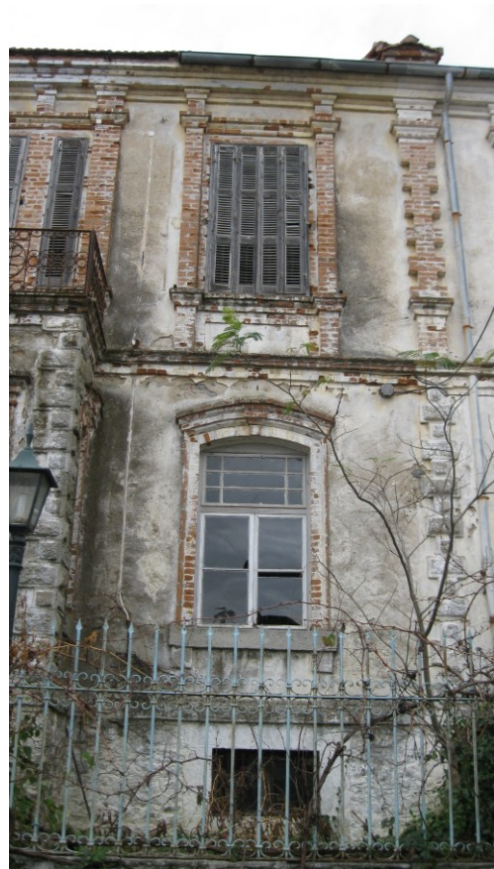
Μαύρη κρούστα, λεκέδες από οξείδωση μεταλλικών στοιχείων, προηγούμενες επεμβάσεις συντήρησης, ατμοσφαιρικοί ρύποι, βιολογικές επικαθίσεις και απώλειες ασβεστοκονιαμάτων στην πρόσοψη του κτιρίου.
