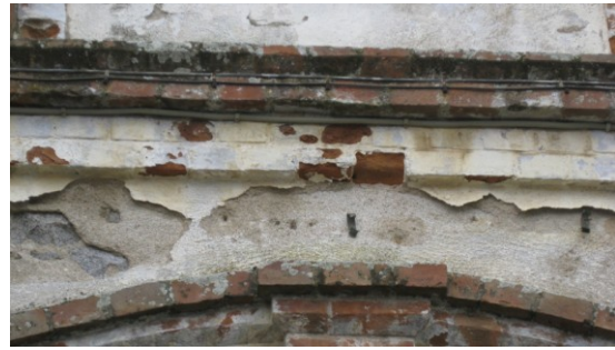
Μαύρη κρούστα, απώλεια ασβεστοκονιάματος και ατμοσφαιρικοί ρύποι σε λεπτομέρεια της κεντρικής πόρτας.
