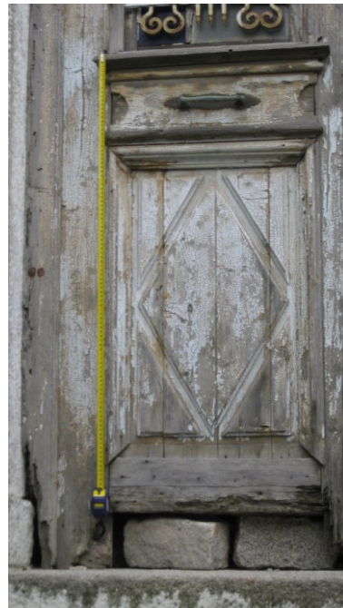
Οξείδωση μεταλλικών στοιχείων, προηγούμενες επεμβάσεις συντήρησης, και απώλειες ξύλινου υλικού στη κεντρική πόρτα του κτιρίου.
