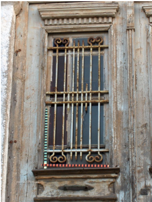
Οξείδωση μεταλλικών στοιχείων, προηγούμενες επεμβάσεις συντήρησης και απώλειες ξύλινου υλικού στη κεντρική πόρτα του κτιρίου.
