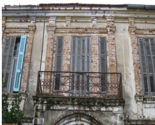
Μαύρη κρούστα, λεκέδες από οξείδωση μεταλλικών στοιχείων, προηγούμενες επεμβάσεις συντήρησης, ατμοσφαιρικοί ρύποι, βιολογικές επικαθίσεις και απώλειες ασβεστοκονιαμάτων και ξύλινου υλικού στην πρόσοψη του κτιρίου.
