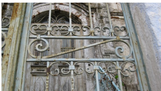
Οξείδωση του μετάλλου και απώλειες βαφής στη μεταλλική πόρτα της αυλής.
