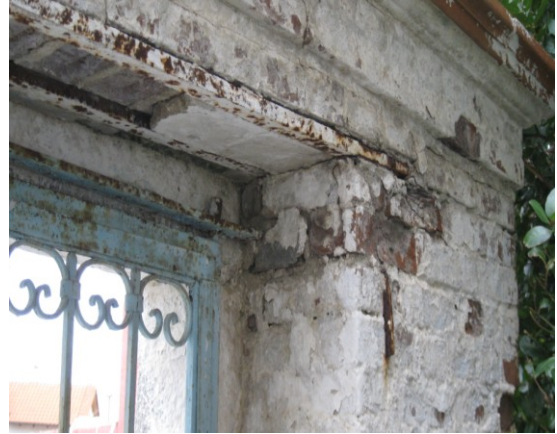
Μαύρη κρούστα, οξείδωση μεταλλικών στοιχείων, προηγούμενες επεμβάσεις συντήρησης, ατμοσφαιρικοί ρύποι και απώλειες ασβεστοκονιαμάτων στη πίσω όψη της μεταλλικής πόρτας της αυλής.
