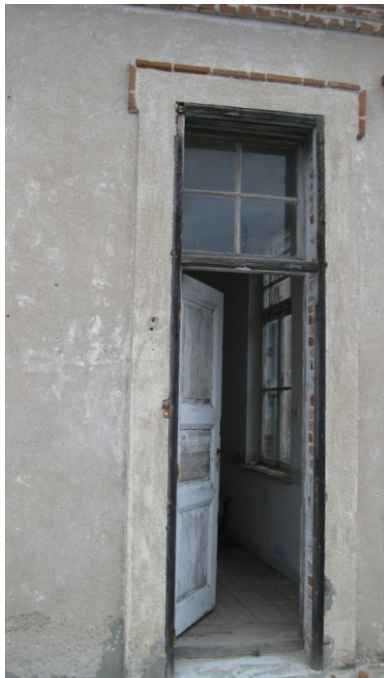
Ατμοσφαιρικοί ρύποι, απώλεια σοβά και προηγούμενες επεμβάσεις συντήρησης στην πίσω όψη του κτιρίου.
