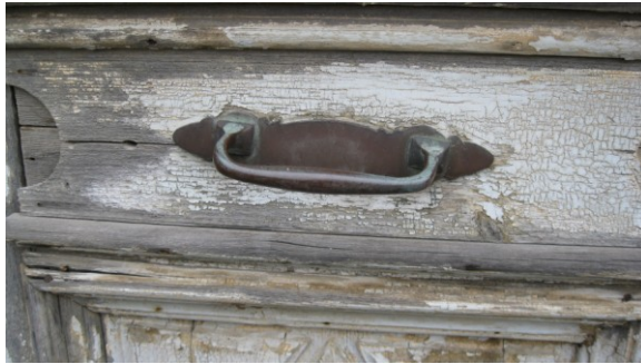
Απώλεια βαφής, απώλεια ξύλινου υλικού και ίχνη δυο χρωμάτων βαφής σε λεπτομέρεια της κεντρικής πόρτας.
