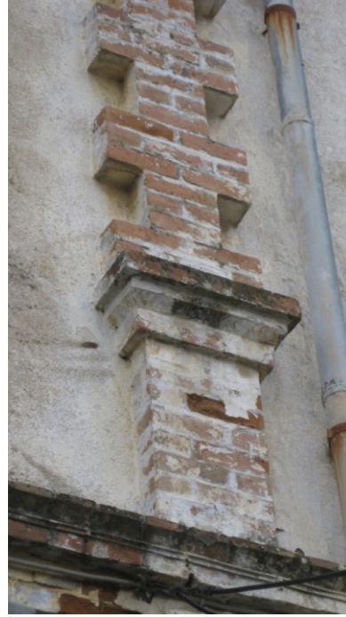
Μαύρη κρούστα, προηγούμενες επεμβάσεις συντήρησης, ατμοσφαιρικοί ρύποι και απώλειες ασβεστοκονιαμάτων στην πρόσοψη του κτιρίου.
