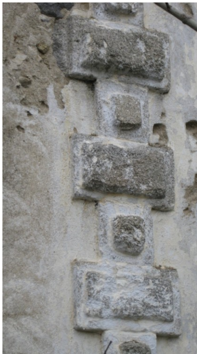
Μαύρη κρούστα, ατμοσφαιρικοί ρύποι και απώλειες ασβεστοκονιαμάτων στην πρόσοψη του κτιρίου.
