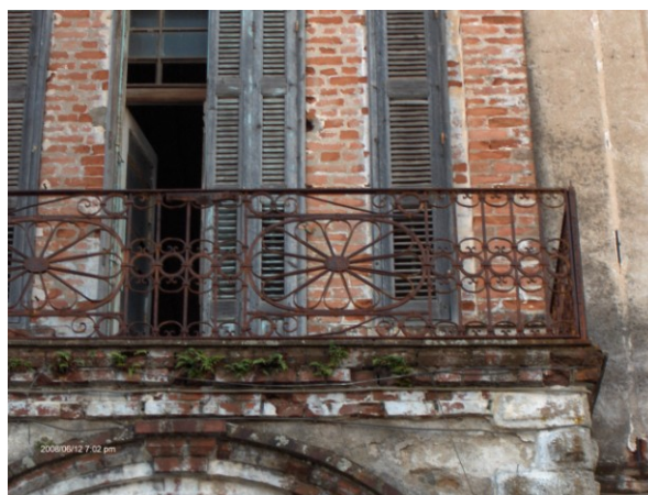
Μαύρη κρούστα, λεκέδες από οξείδωση μεταλλικών στοιχείων, προηγούμενες επεμβάσεις συντήρησης, ατμοσφαιρικοί ρύποι, βιολογικές επικαθίσεις και απώλειες ασβεστοκονιαμάτων και ξύλινου υλικού στην πρόσοψη του κτιρίου.
