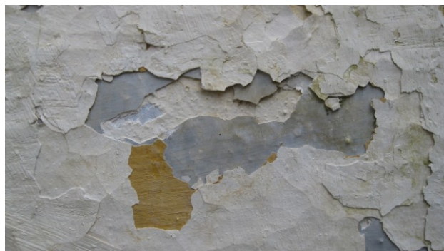
Απώλειες ασβεστοκονιαμάτων και ίχνη διαφορετικών χρωμάτων βαφής στη πίσω όψη του κτιρίου.
