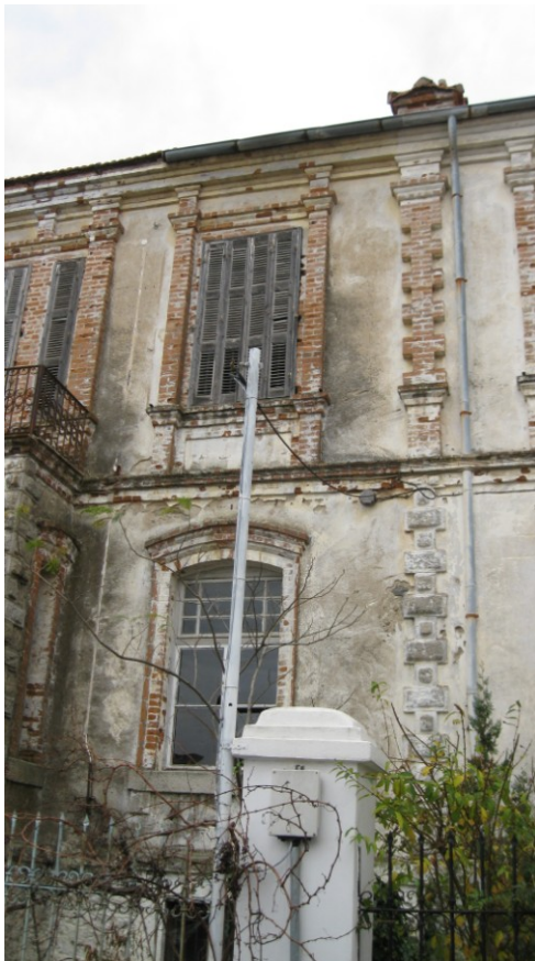
Μαύρη κρούστα, λεκέδες από οξείδωση μεταλλικών στοιχείων, προηγούμενες επεμβάσεις συντήρησης, ατμοσφαιρικοί ρύποι, βιολογικές επικαθίσεις και απώλειες ασβεστοκονιαμάτων στην πρόσοψη του κτιρίου.
