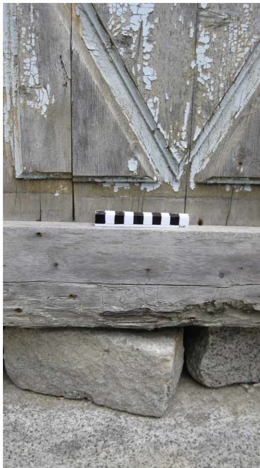
Απώλεια βαφής, απώλεια ξύλινου υλικού και ίχνη δυο χρωμάτων βαφής σε λεπτομέρεια της κεντρικής πόρτας.
