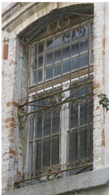
Μαύρη κρούστα, οξείδωση μεταλλικών στοιχείων, προηγούμενες επεμβάσεις συντήρησης, ατμοσφαιρικοί ρύποι και απώλειες ασβεστοκονιαμάτων και ξύλινου υλικού στην πλάγια όψη του κτιρίου.
