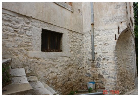
Λεκέδες από οξείδωση μεταλλικών στοιχείων, προηγούμενες επεμβάσεις συντήρησης, ατμοσφαιρικοί ρύποι, βιολογικές επικαθίσεις και απώλειες ασβεστοκονιαμάτων και ξύλινου υλικού στην πλάγια όψη του κτιρίου.
