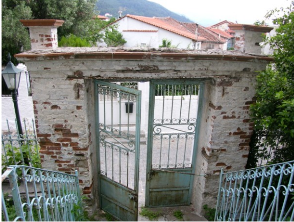
Μαύρη κρούστα, οξείδωση μεταλλικών στοιχείων, προηγούμενες επεμβάσεις συντήρησης, ατμοσφαιρικοί ρύποι, βιολογικές επικαθίσεις και απώλειες ασβεστοκονιαμάτων στη πίσω όψη της μεταλλικής πόρτας της αυλής.
