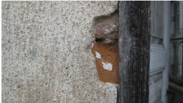
Απώλειες ασβεστοκονιαμάτων στη πίσω όψη του κτιρίου.
