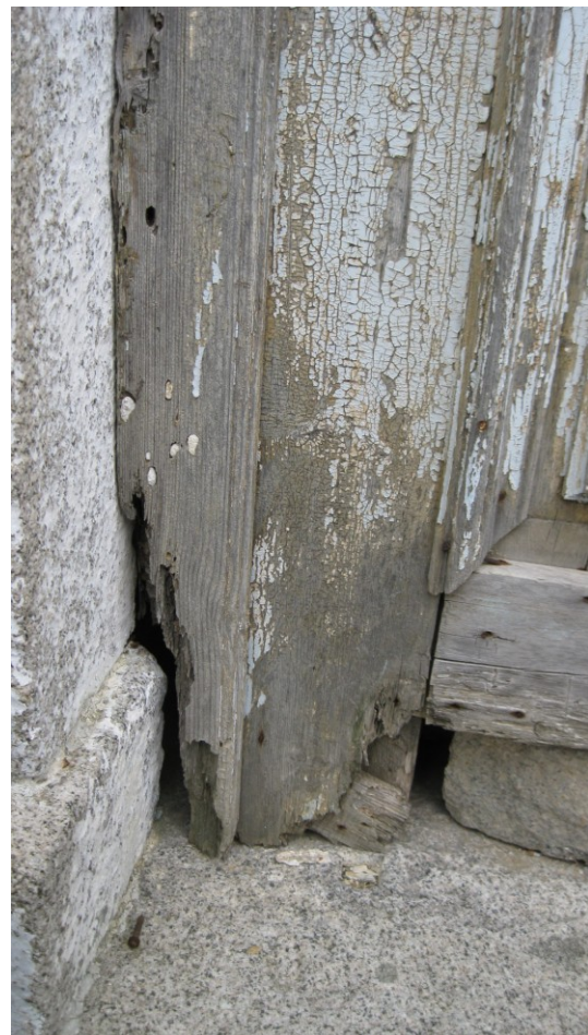
Απώλεια βαφής, απώλεια ξύλινου υλικού και ίχνη δυο χρωμάτων βαφής σε λεπτομέρεια της κεντρικής πόρτας.
