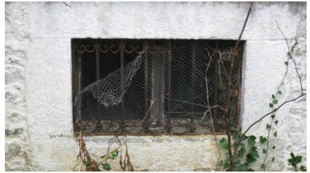
Οξείδωση μεταλλικών στοιχείων, ατμοσφαιρικοί ρύποι και βιολογικές επικαθίσεις στην πρόσοψη του κτιρίου.
