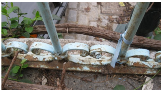
Οξείδωση του μετάλλου και απώλειες βαφής στα κιγκλιδώματα της αυλής.
