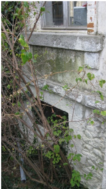
Οξείδωση μεταλλικών στοιχείων, προηγούμενες επεμβάσεις συντήρησης, ατμοσφαιρικοί ρύποι, βιολογικές επικαθίσεις και απώλειες ασβεστοκονιαμάτων και ξύλινου υλικού στην πρόσοψη του κτιρίου.
