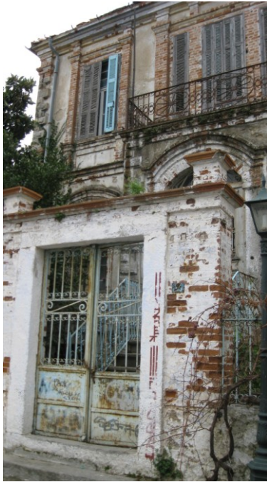
Μαύρη κρούστα, λεκέδες από οξείδωση μεταλλικών στοιχείων, προηγούμενες επεμβάσεις συντήρησης, ατμοσφαιρικοί ρύποι, βιολογικές επικαθίσεις, graffiti's και απώλειες ασβεστοκονιαμάτων στην πρόσοψη του κτιρίου.
