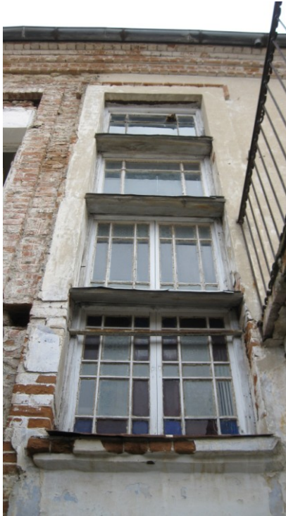
Μαύρη κρούστα, προηγούμενες επεμβάσεις συντήρησης, ατμοσφαιρικοί ρύποι και απώλειες ασβεστοκονιαμάτων στη πίσω όψη του κτιρίου.
