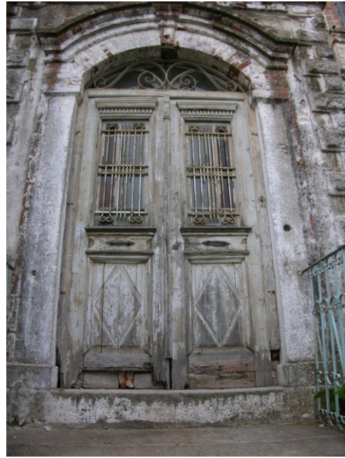
Μαύρη κρούστα, προηγούμενες επεμβάσεις συντήρησης, ατμοσφαιρικοί ρύποι, βιολογικές επικαθίσεις και απώλειες ασβεστοκονιαμάτων και ξύλινου υλικού στη κεντρική πόρτα του κτιρίου.
