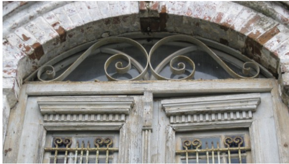
Απώλεια βαφής, μαύρη κρούστα, απώλεια ξύλινου υλικού, οξείδωση μεταλλικών στοιχείων και ίχνη δυο χρωμάτων βαφής σε λεπτομέρεια της κεντρικής πόρτας.
