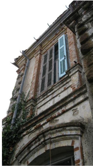
Μαύρη κρούστα, λεκέδες από οξείδωση μεταλλικών στοιχείων, προηγούμενες επεμβάσεις συντήρησης, ατμοσφαιρικοί ρύποι και απώλειες ασβεστοκονιαμάτων στην πρόσοψη του κτιρίου.
