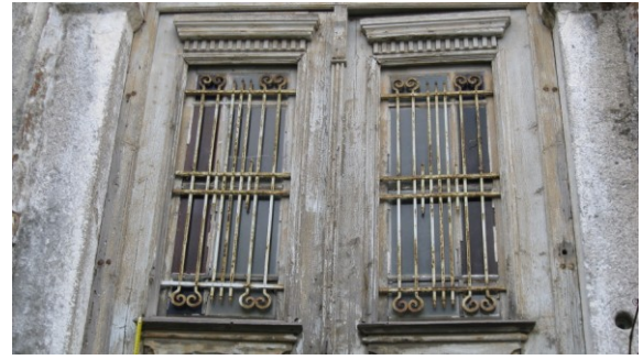
Απώλεια βαφής, απώλεια ξύλινου υλικού, οξείδωση μεταλλικών στοιχείων και ίχνη δυο χρωμάτων βαφής σε λεπτομέρεια της κεντρικής πόρτας.
