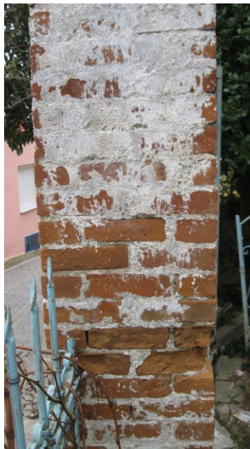
Προηγούμενες επεμβάσεις συντήρησης, ατμοσφαιρικοί ρύποι και απώλειες ασβεστοκονιαμάτων στην πρόσοψη του κτιρίου.
