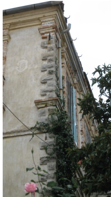
Μαύρη κρούστα, λεκέδες από οξείδωση μεταλλικών στοιχείων, προηγούμενες επεμβάσεις συντήρησης, ατμοσφαιρικοί ρύποι και απώλειες ασβεστοκονιαμάτων σε πλάγια όψη του κτιρίου.
