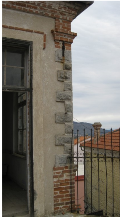
Μαύρη κρούστα, λεκέδες από οξείδωση μεταλλικών στοιχείων, προηγούμενες επεμβάσεις συντήρησης, ατμοσφαιρικοί ρύποι και απώλειες ασβεστοκονιαμάτων στη πίσω όψη του κτιρίου.
