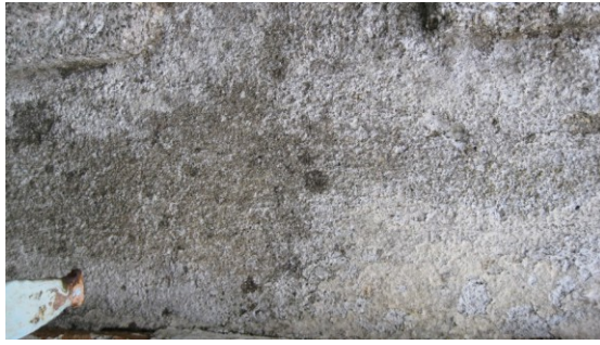
Μαύρη κρούστα και ατμοσφαιρικοί ρύποι, στην πρόσοψη του κτιρίου.
