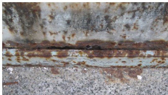
Οξείδωση του μετάλλου, graffiti's και απώλειες βαφής στη μεταλλική πόρτα της αυλής.
