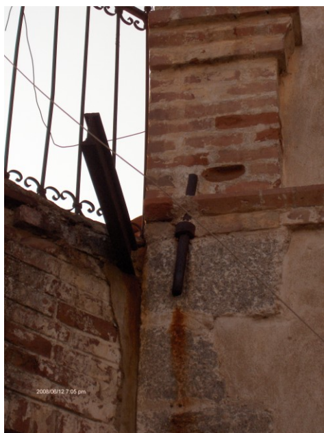
Λεκέδες από οξείδωση μεταλλικών στοιχείων, προηγούμενες επεμβάσεις συντήρησης, ατμοσφαιρικοί ρύποι και απώλειες ασβεστοκονιαμάτων στην πλάγια όψη του κτιρίου.
