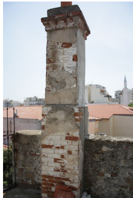
Μαύρη κρούστα, οξείδωση μεταλλικών στοιχείων, προηγούμενες επεμβάσεις συντήρησης, ατμοσφαιρικοί ρύποι, βιολογικές επικαθίσεις και απώλειες ασβεστοκονιαμάτων στην πίσω όψη του κτιρίου.
