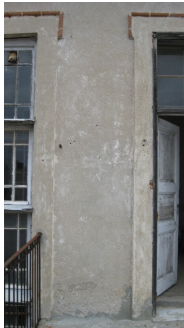
Ατμοσφαιρικοί ρύποι, απώλεια σοβά και προηγούμενες επεμβάσεις συντήρησης στην πίσω όψη του κτιρίου.
