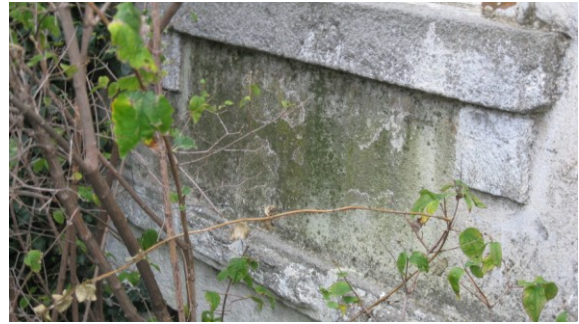
Ατμοσφαιρικοί ρύποι και βιολογικές επικαθίσεις στην πρόσοψη του κτιρίου.
