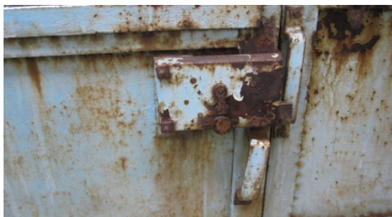
Οξείδωση του μετάλλου και απώλειες βαφής στη μεταλλική πόρτα της αυλής.
