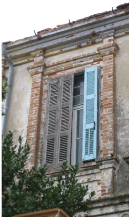
Μαύρη κρούστα, προηγούμενες επεμβάσεις συντήρησης, ατμοσφαιρικοί ρύποι, βιολογικές επικαθίσεις και απώλειες ασβεστοκονιαμάτων και ξύλινου υλικού στην πρόσοψη του κτιρίου.
