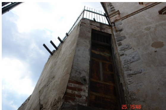
Μαύρη κρούστα, λεκέδες από οξείδωση μεταλλικών στοιχείων, προηγούμενες επεμβάσεις συντήρησης, ατμοσφαιρικοί ρύποι και απώλειες ασβεστοκονιαμάτων στην πλάγια όψη του κτιρίου.
