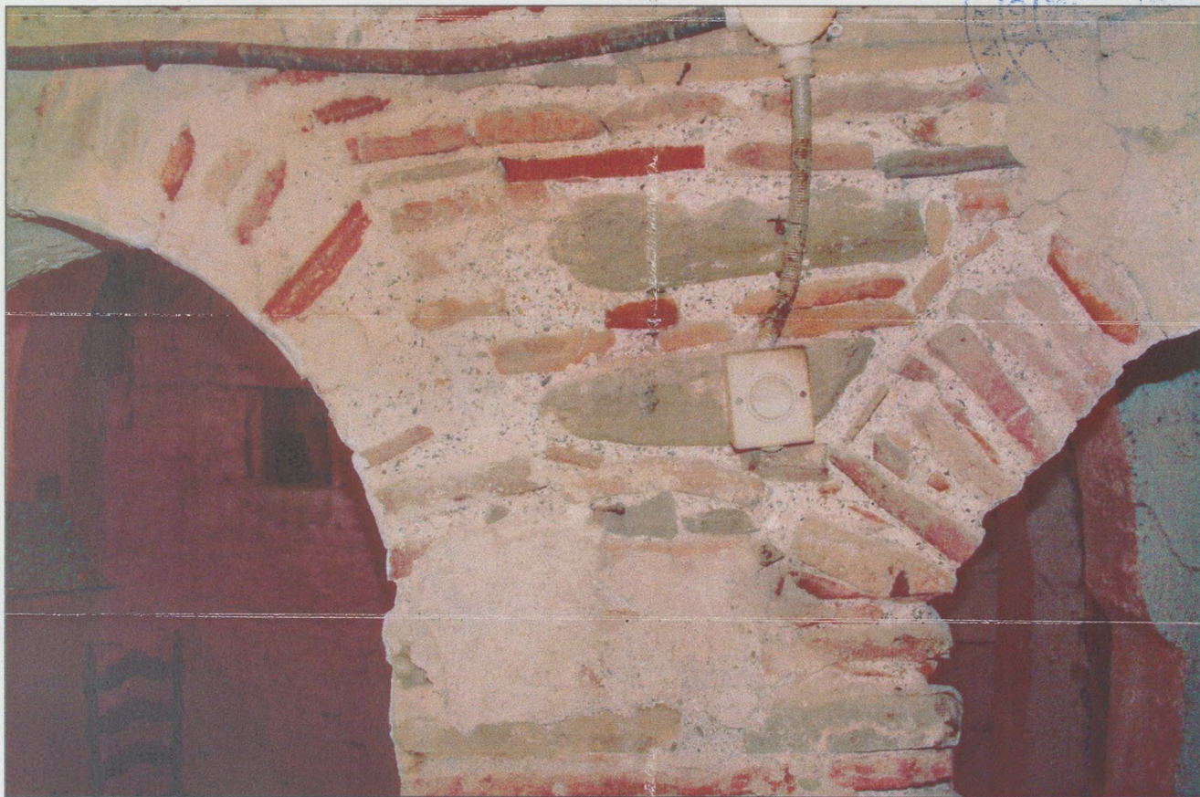
Πιν.25 Άποψη της πλευράς του τέμπλου προς το ιερό. Διακρίνονται οι επισκευασμένες περιοχές από το Στίκα (;) με συμπαγείς οπτόπλινθους (2008)
