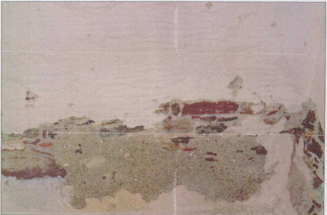
Πιν.30 Προβλήματα στην εσωτερική παρειά της τοιχοποιίας, λόγω ανερχόμενης υγρασίας (2008).
