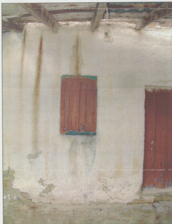
Εικ.40 Χαρακτηριστική εικόνα της εγκατάλειψης και της έλλειψης ορθής συντήρησης του μνημείου (2008).
