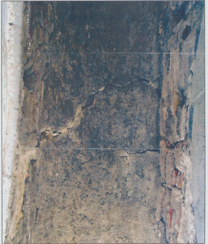
Εικ.34 Χαρακτηριστικές, παράλληλες προς τον Ν τοίχο, ρωγμές στην εγκάρσια καμάρα του ναού, λόγω των πλάγιων ωθήσεων της κατά μήκος καμάρας (2007).
