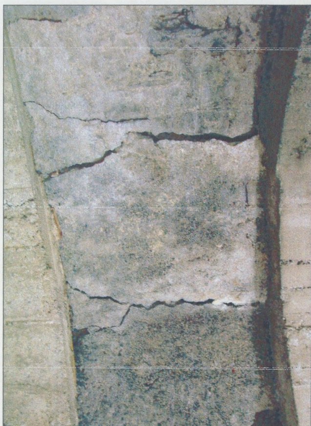
Πιν.34 Ρωγμές μεγάλου εύρους, στο Δ τμήμα της κατά μήκος καμάρας (2007).
