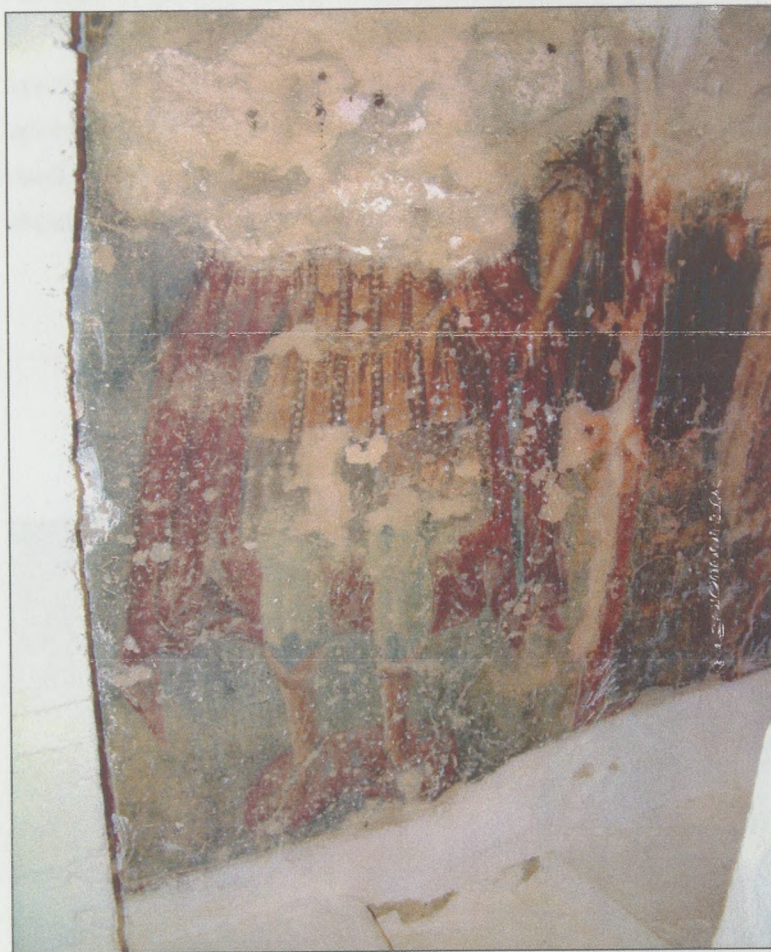
Εικ.36 Τοιχογραφία (Αρχάγγελος Μιχαήλ;) σε κακή κατάσταση διατήρησης. Διακρίνονται οι σημαντικές φθορές και οι στερεωτικές εργασίες (στεφάνωμα) που έχουν πραγματοποιηθεί κατά το παρελθόν (2008).
