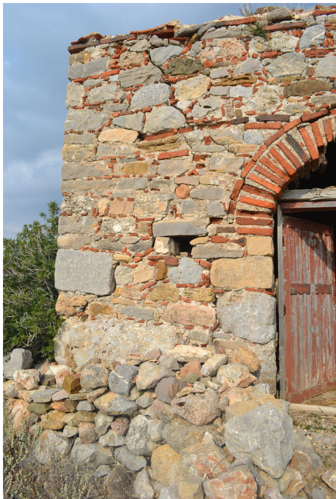
Εικ.20 Νοτιοδυτική γωνία προστώου. Νότια όψη - Διακρίνεται η αποκόλλησή της από το σώμα της λιθοδομής
