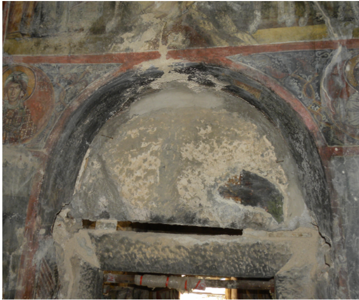
Εικ.25. Μεγάλα κενά, παρατηρούνται στις σφραγίσεις περιμετρικά του Δ. θυρώματος και της ημικυκλικής πλάκας
