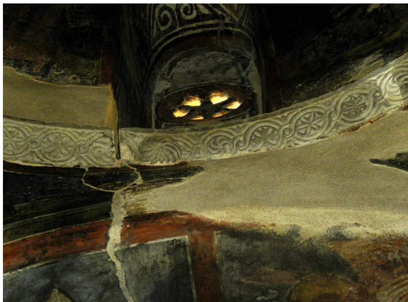
Εικ.20. Στον κοσμήτη έχουν προκληθεί θραύσεις που σχετίζονται με τις ευρύτερες γεωμετρικές μεταβολές, που έχει υποστεί η κατασκευή λόγω των καταπονήσεων.
