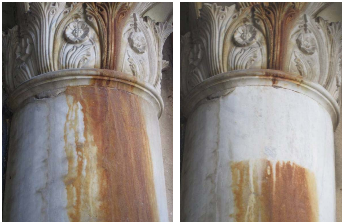
Εικ.30α,β. Λεπτομέρεια κίονα στον οποίο έχει γίνει δοκιμή καθαρισμού για την αφαίρεση κηλίδων από οξείδια σιδήρου.
