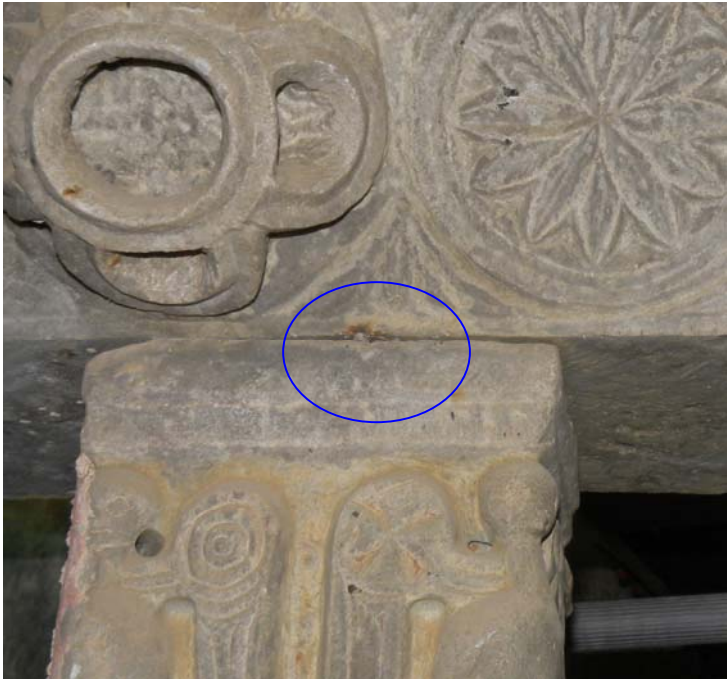
Εικ. 7. Ενσφηνωμένα μεταλλικά στοιχεία στους αρμούς μεταξύ των αρχιτεκτονικών μελών.
