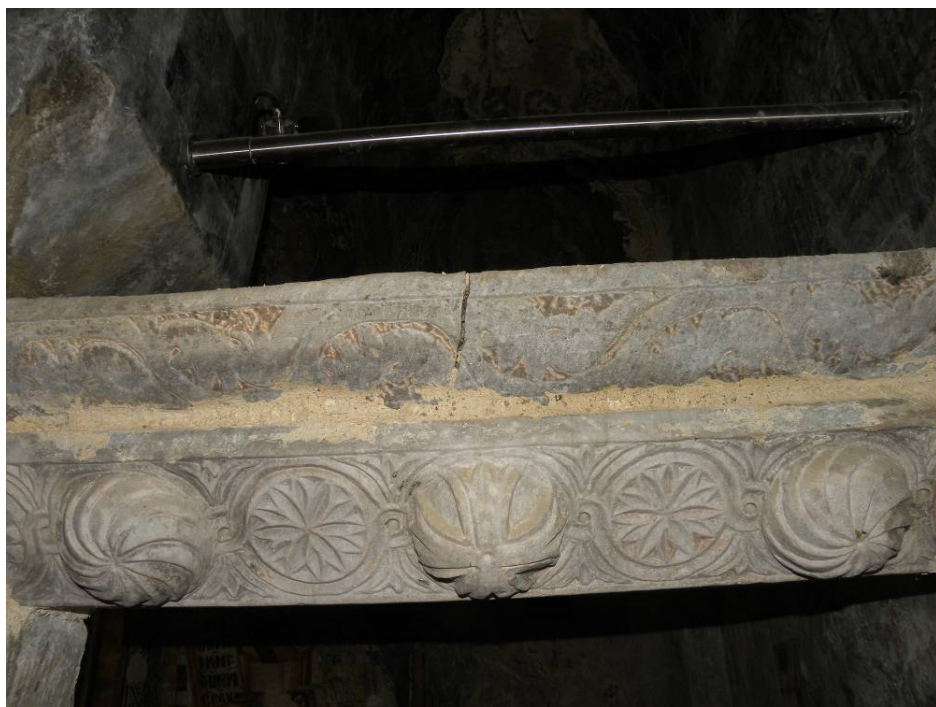
Εικ.17. Λεπτομέρεια του Ν. τμήματος του επιστήλιου και του γείσου του τέμπλου, διακρίνεται η θραύση του γείσου.
