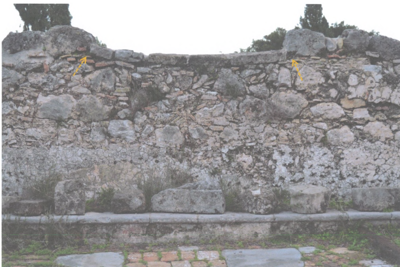
Φωτ.55 Η ποδιά του δυτικού παραθύρου του βόρειου τοίχου (ΠΒ1).
