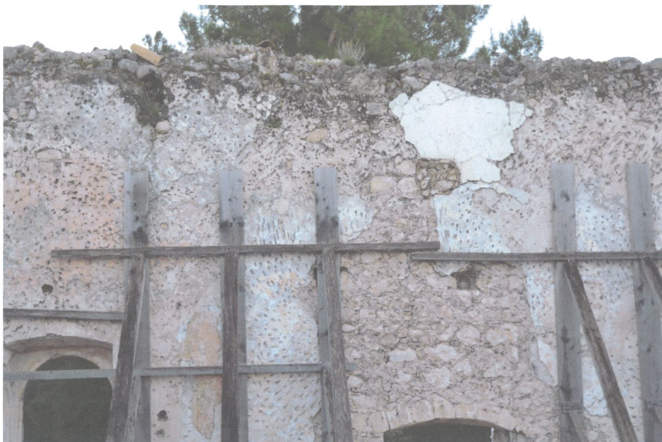
Φωτ.30 Τμήμα του νότιου τοίχου πάνω από τη νότια θύρα. Διακρίνονται τα επάλληλα στρώματα επιχρισμάτων και οι φραγμένες δοκοθήκες της στέγης.
