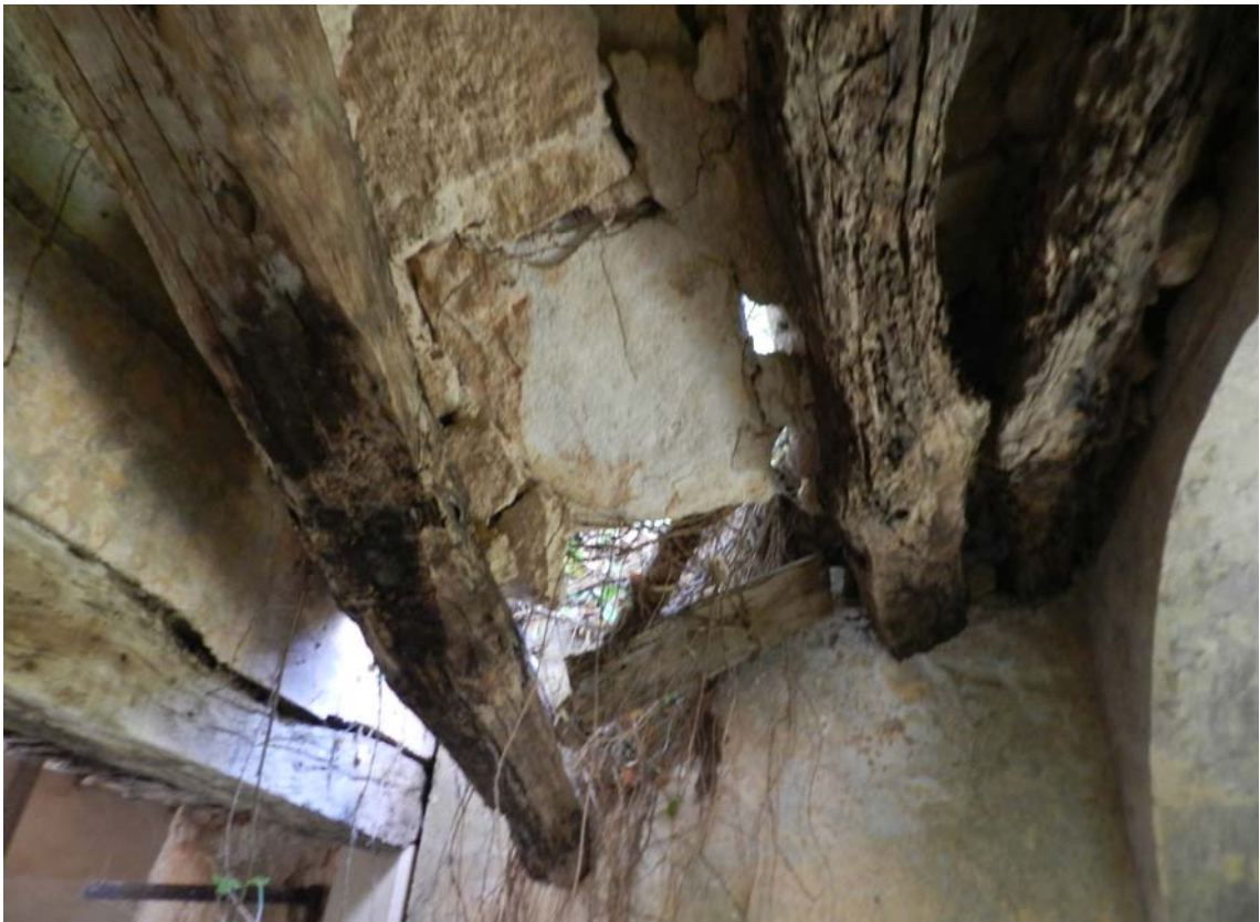
Εικ. 16. Κατάρρευση του πατώματος στέγασης του χώρου Ι4. Καταστροφή των ξύλινων δοκών και εξαιρετικά επισφαλής θέση των μετεωριζόμενων λίθινων πλακών πλήρωσης του πατώματος.
