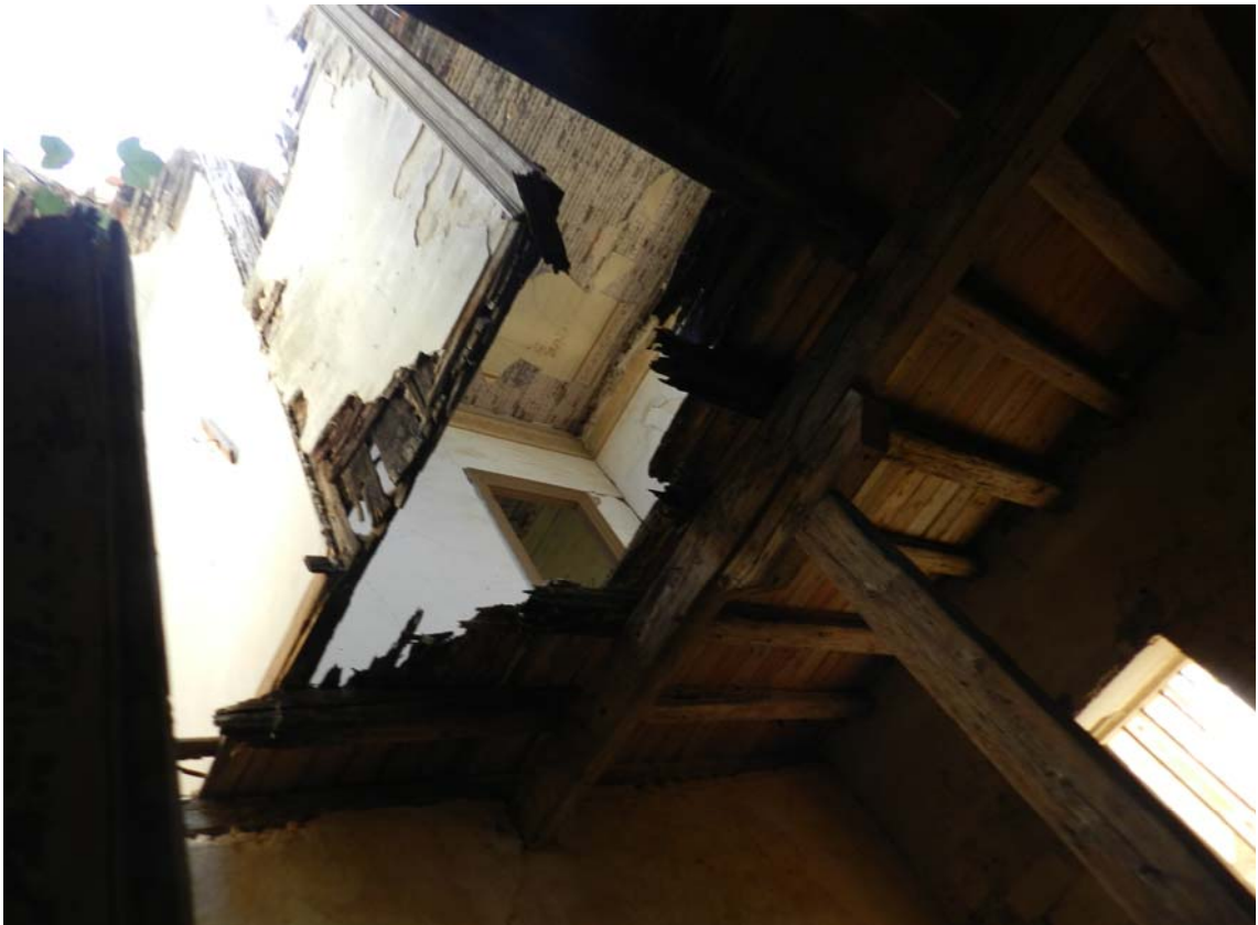
Εικ. 6. Επισφαλή και ετοιμόρροπα τμήματα στο εσωτερικό της οικίας: μετέωροι κρεμάμενοι εσωτερικοί τοίχοι του ορόφου (μοροφίντο), στέκουν στη θέση τους, ακόμη και μετά την καταστροφή μέρους του μεσοπατώματος.
