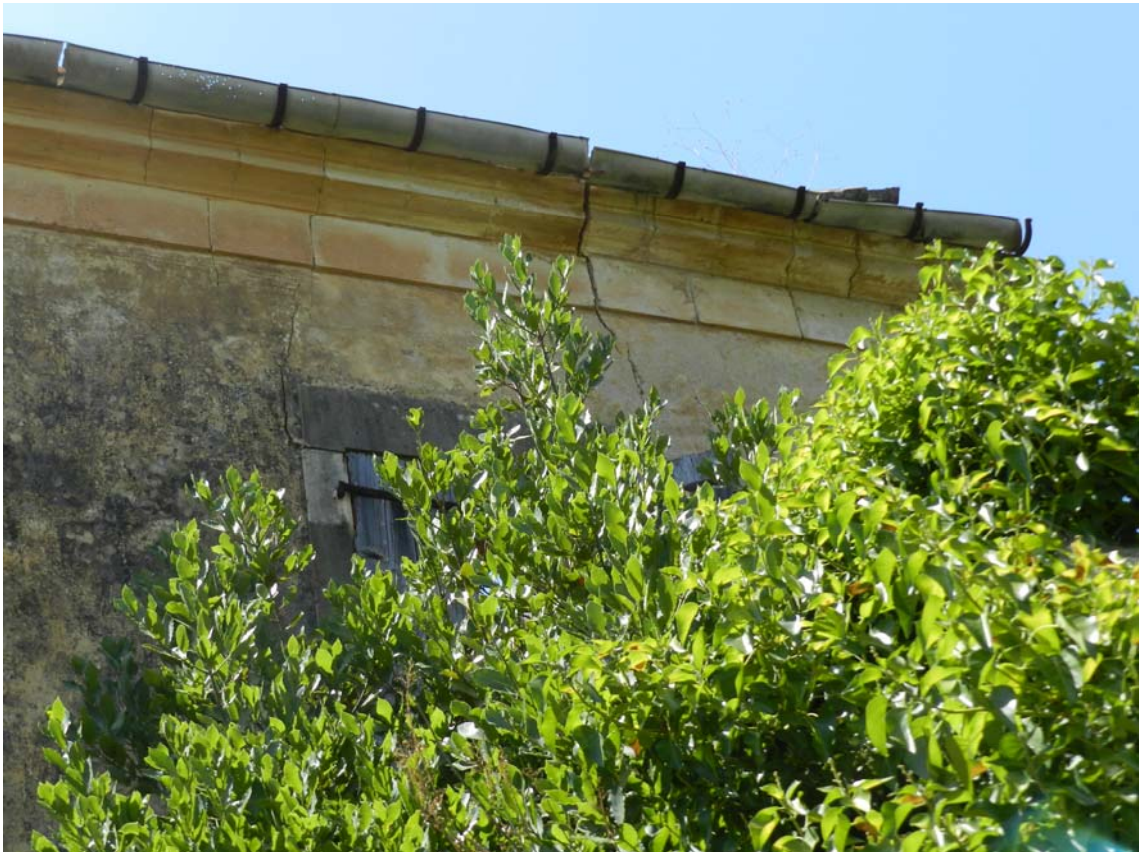
Εικ. 12, 13. Μετακίνηση, ετοιμορροπία έως και απώλεια των λίθινων λαξευτών στοιχείων του γεισώματος.
