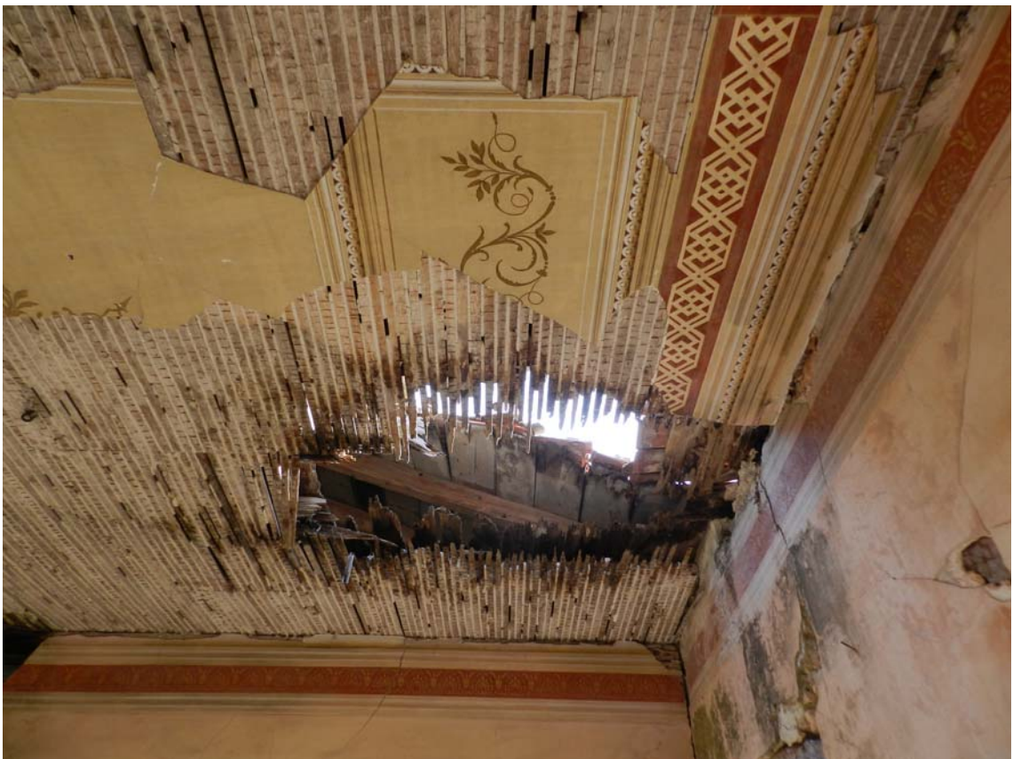
Εικ. 7. Επισφαλή και ετοιμόρροπα τμήματα στο εσωτερικό της οικίας: τμήματα της επιζωγραφισμένης οροφής.
