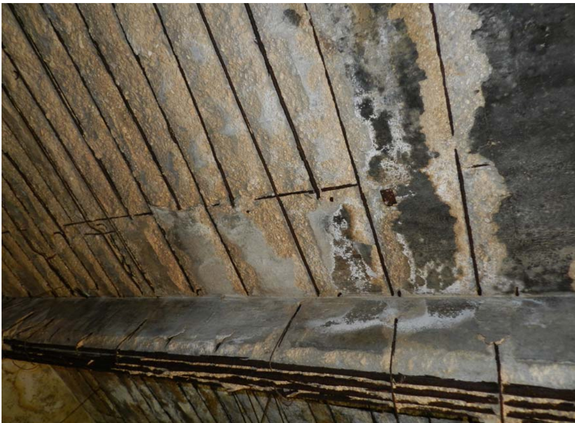
Εικ. 14. Οξείδωση και αποκάλυψη του σιδηροπλισμού κατόπιν απόπτωσης του σκυροδέματος επικάλυψης (κάτω ίνας) των πλακών και δοκών Ω.Σ.
