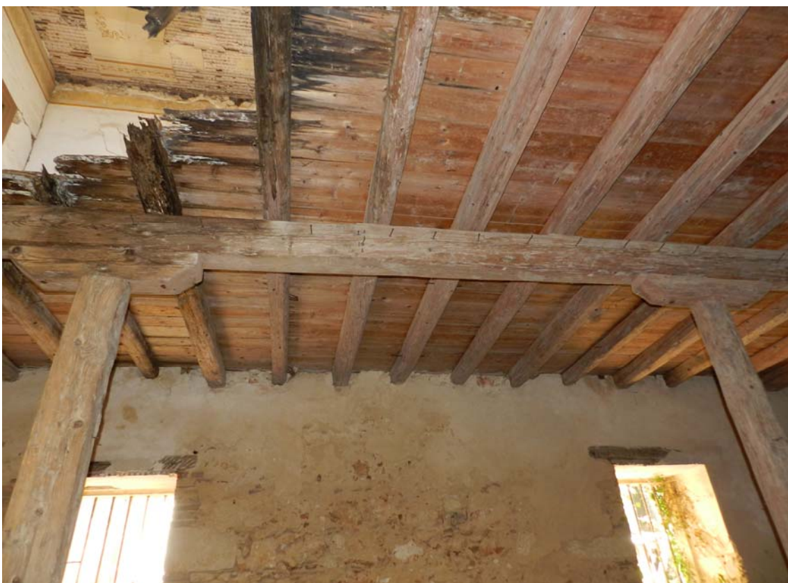
Εικ. 15. Τοπικές βλάβες στα ξύλινα στοιχεία διαδοκίδωσης του μεσοπατώματος. Γενική κατάσταση διατήρησης της ξυλείας καλή, όπως επίσης και καλή η εκτιμώμενη αντοχή της.
