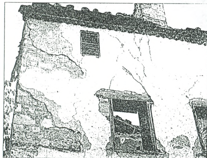
Ο Πύργος Church στην Πλάκα έχει πλέον σχεδόν καταρρεύσει.
