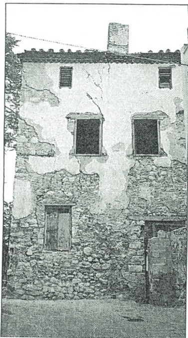
Ο Πύργος του Church στην Πλάκα, κτίσμα του 18ου αιώνα, καταρρέει.
