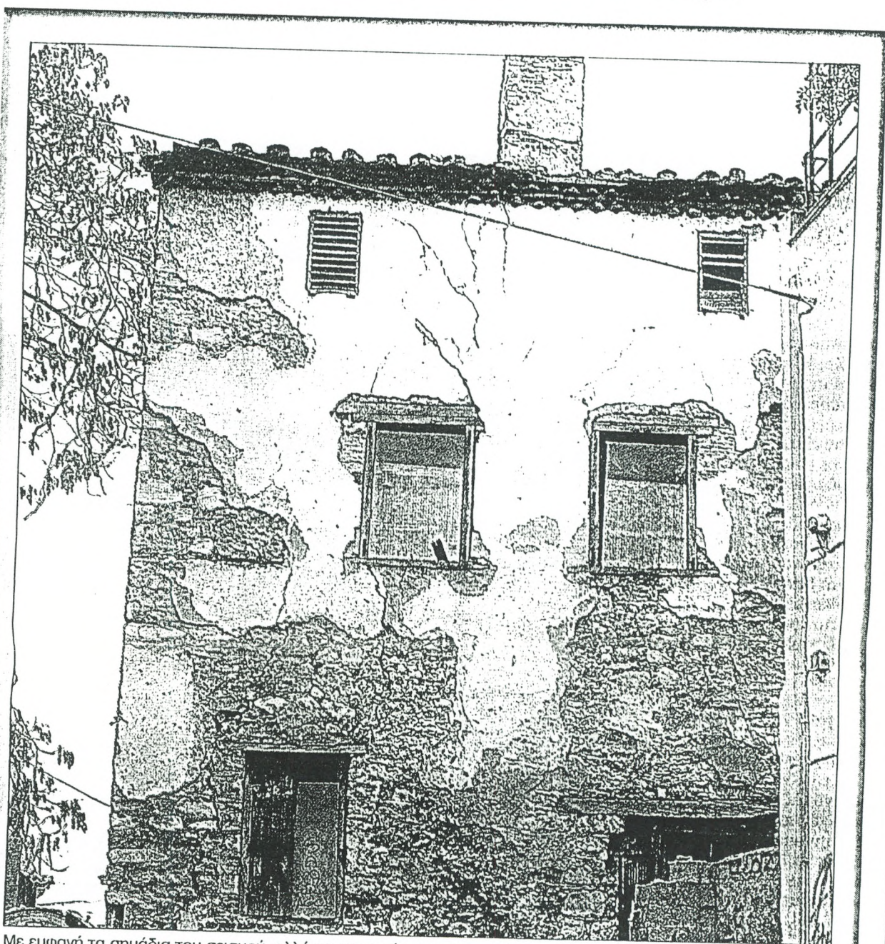
Με εμφανή τα σημάδια του σεισμού, αλλά και της πρόσφατης καταιγίδας, το παλαιότερο σπίτι της Αθήνας. Όπως επισημαίνει η Επιτροπή Πρωτοβουλίας Κατοίκων Πλάκας, απαιτείται άμεση λήψη μέτρων για να μην καταστραφεί ολοσχερώς
