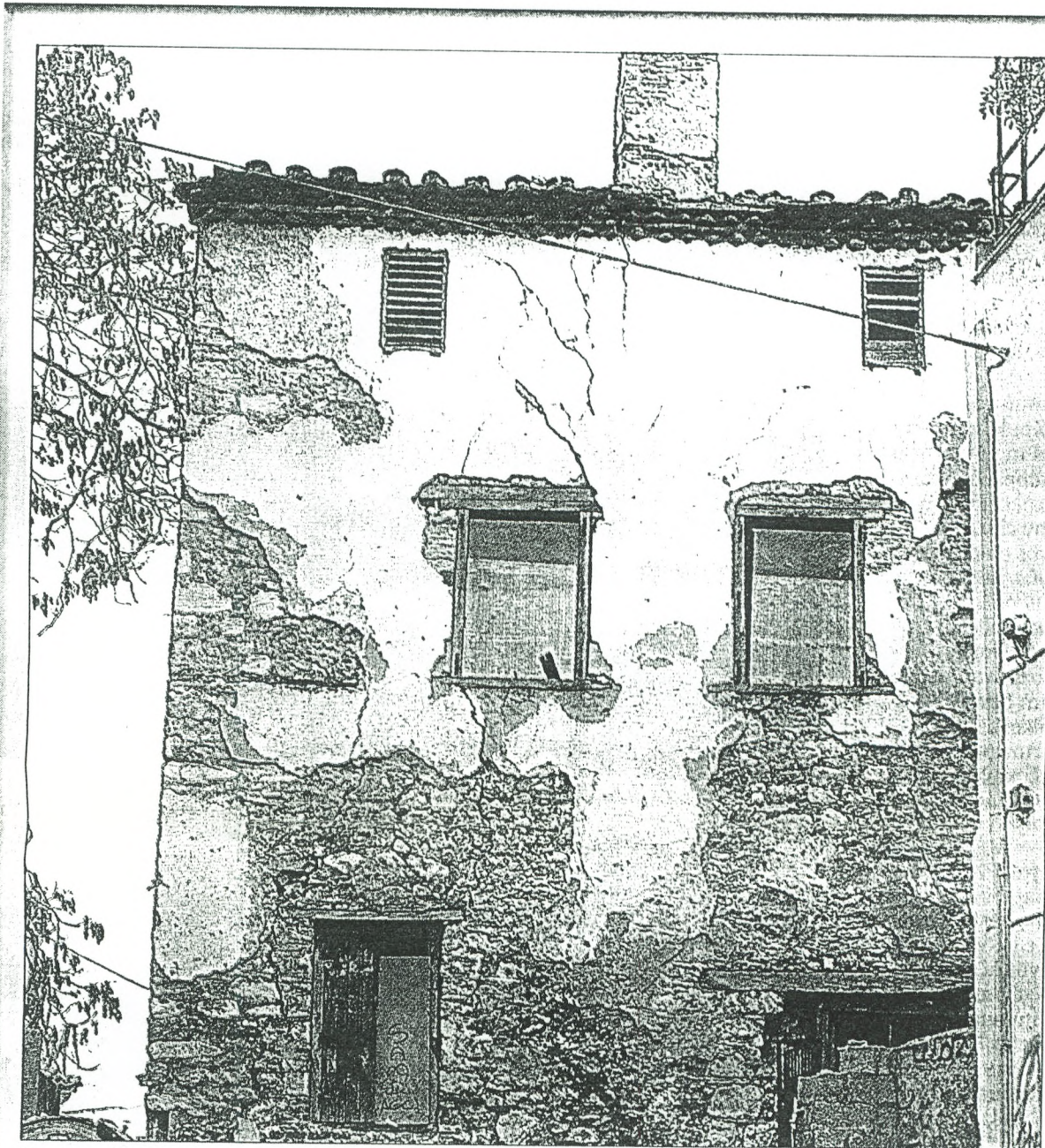
Με εμφανή τα σημάδια του σεισμού, αλλά και της πρόσφατης καταιγίδας, το παλαιότερο σπίτι της Αθήνας. Όπως επισημαίνει η Επιτροπή Πρωτοβουλίας Κατοίκων Πλάκας, απαιτείται άμεση λήψη μέτρων για να μην καταστραφεί ολοσχερώς
