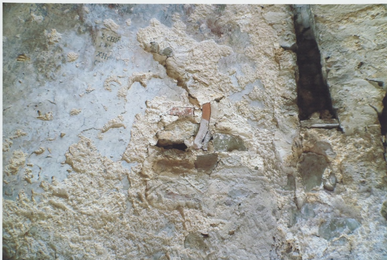
φωτ.69 Υπάρχουσα κατάσταση στο βόρειο τμήμα του τρούλου με δομικές φθορές
