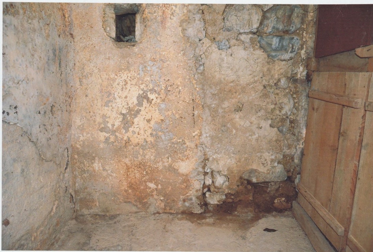
φωτ.34 Τμήμα του νότιου τοίχου με προσθήκη νεότερων υλικών και προβλήματα υγρασίας
