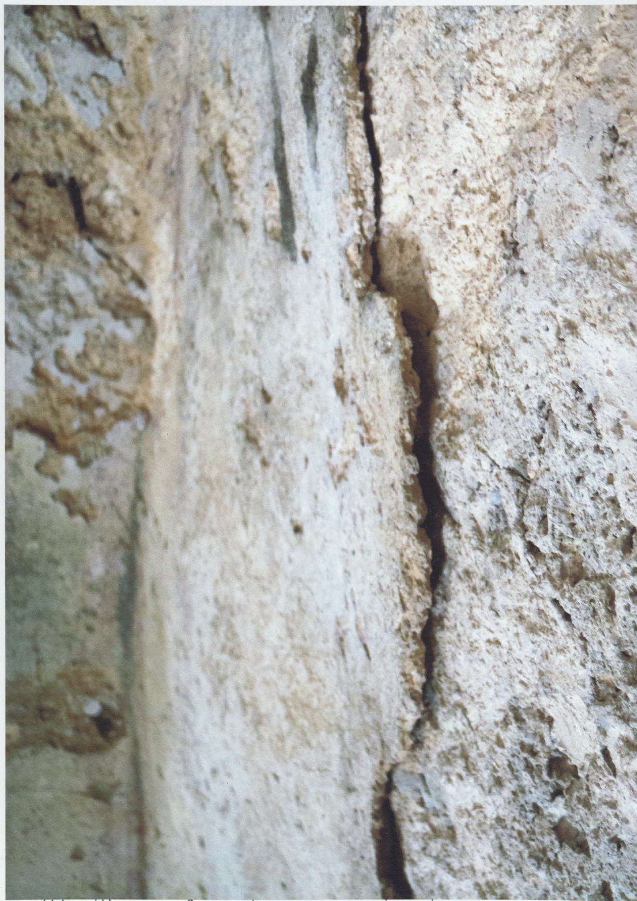
φωτ.64 Αποκόλληση του ασβεστοκονιάματος της χρωματικής επιφάνειας
