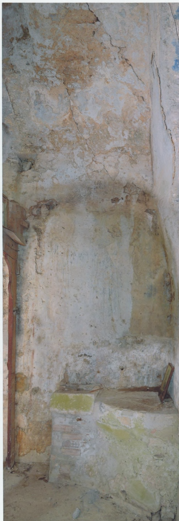
φωτ.58 Όψη βόρειου τοίχου τμήματος από το Ιερό Βήμα της εκκλησίας του Αγίου Ανδρέα
