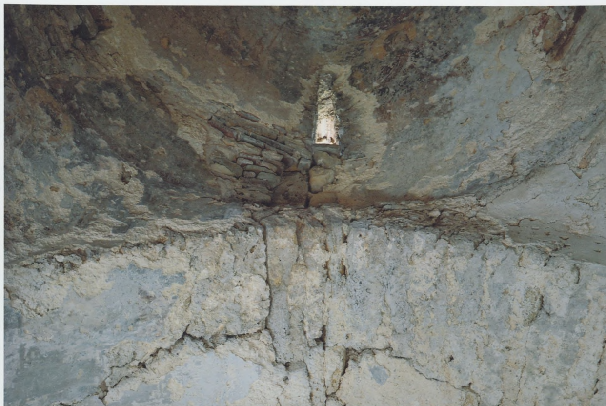
φωτ.67 Υπάρχουσα κατάσταση στο δυτικό τμήμα του τρούλου με δομικές φθορές
