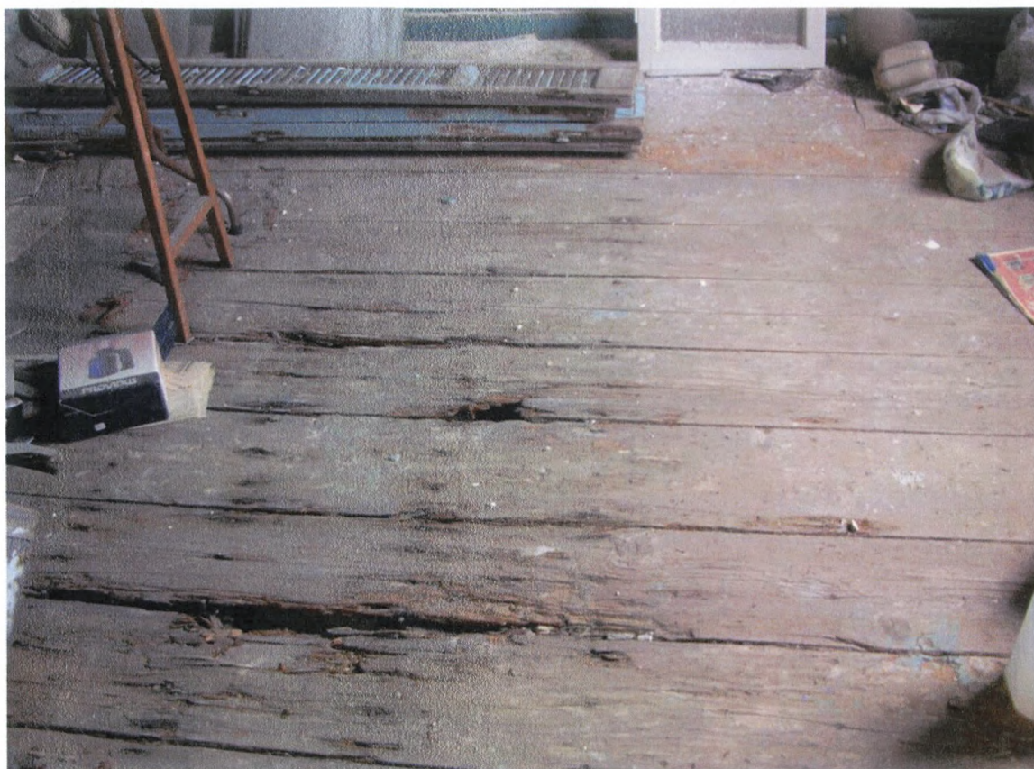
22 ΦΘΟΡΕΣ ΣΤΟ ΞΥΛΙΝΟ ΔΑΠΕΔΟ ΤΟΥ ΙΣΟΓΕΙΟΥ
