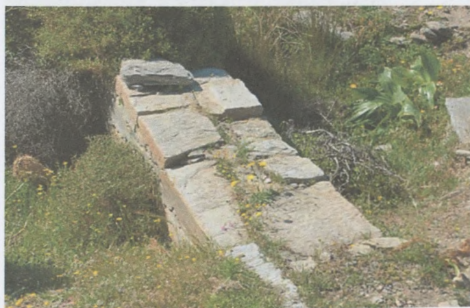
Πιν. 36 Τομέας G, Αυτοφυής βλάστηση σε τοίχους.
