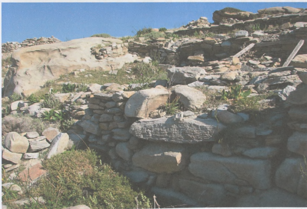
Πιν.42 Τομέας F, Φθορά και απώλεια υλικού.
