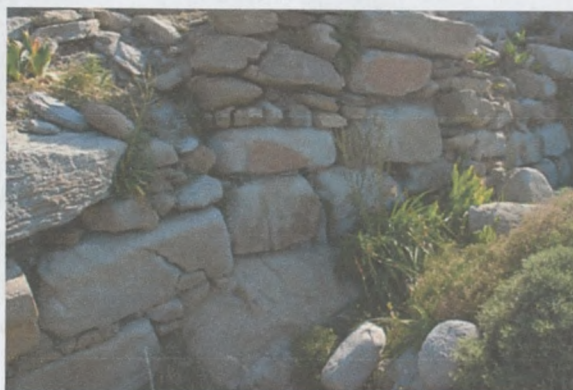
Πιν. 35 Τομέας F, Ρηγματώσεις και απώλεια συνοχής τοίχων.
