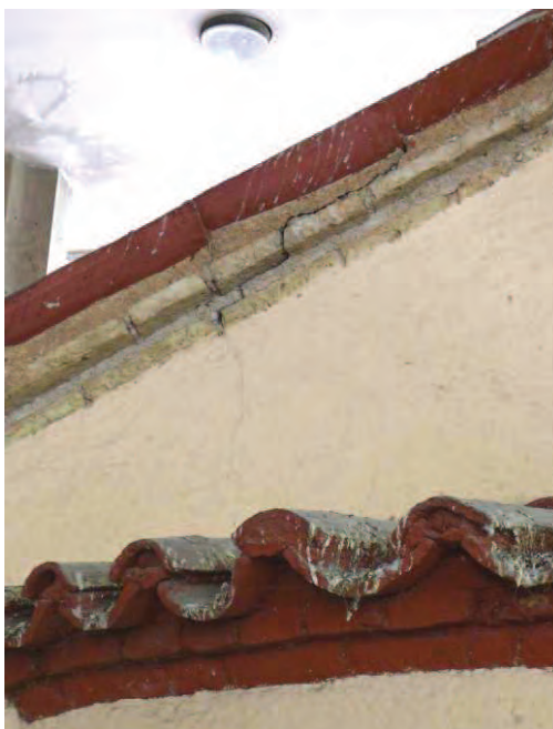
Εικόνα 12 Ρωγμή στον ανατολικό τοίχο εξωτερικά
