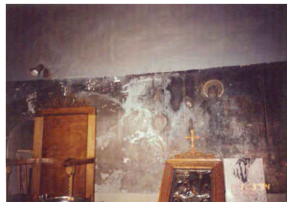
Εικόνα 13 Φθορές και επισκευές στο νότιο τοίχο. (αρχείο ΔΑΒΜΜ 1994)
