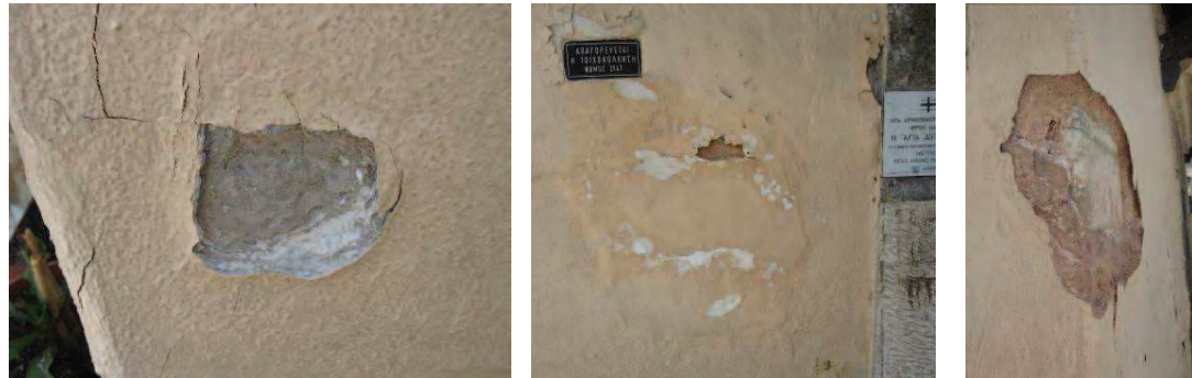
Εικόνα 19 Φθορές στα εξωτερικά επιχρίσματα, δυτικός τοίχος
