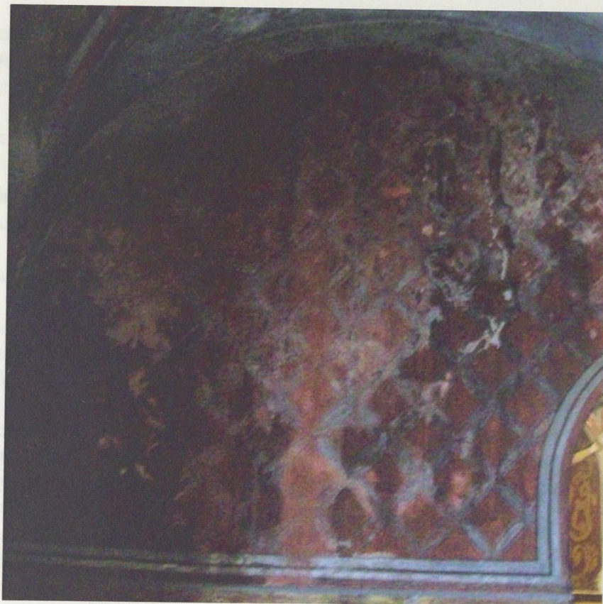
Φωτογραφία 10. Δημιουργία εξανθημάτων στην επιφάνεια του ζωγραφικού στρώματος που οφείλεται από την εισροή νερού από την οροφή.
