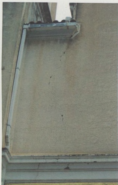
Φωτογραφία 3. Ρωγμή στο εξωτερικό του Ι. Ναού.
