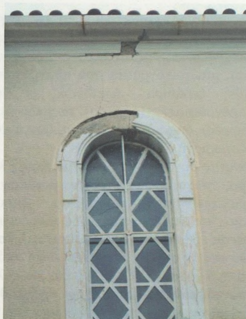
Φωτογραφία 4. Ρωγμή στο εξωτερικό του Ι. Ναού.
