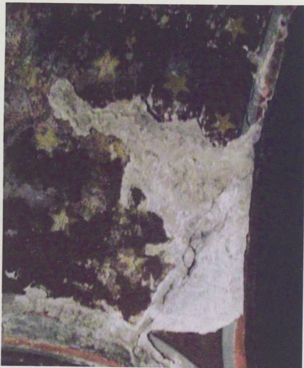
Φωτογραφία 6. Περιοχή όπου το κονίαμα είναι σαθρό.
