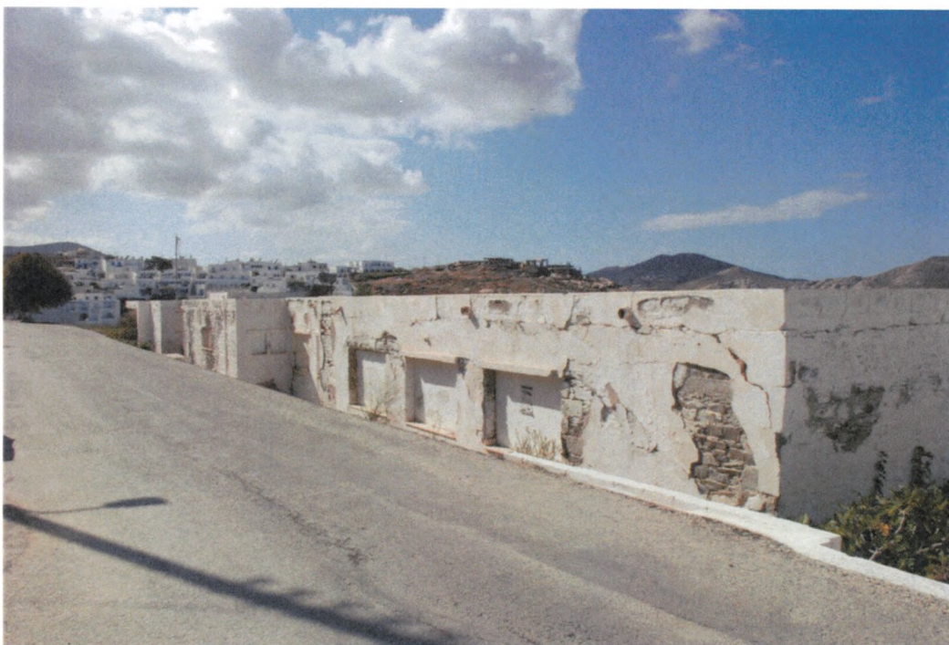
Εικ. 4 Άποψη του κτηρίου από Α. Διακρίνονται οι εμφανείς βλάβες στην τοιχοποιία.
