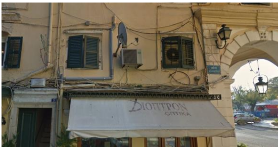
Εικόνα 23. Τυπική εικόνα όψης κτιρίου με επίτοιχη ανάπτυξη ενσύρματων δικτύων.
