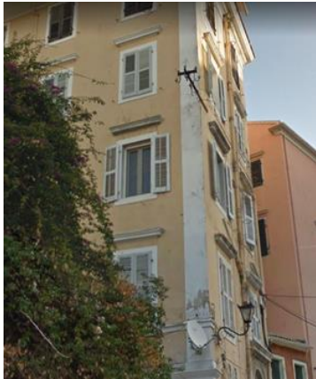
Εικόνα 22. Τυπική εικόνα όψης κτιρίου με επίτοιχη όδευση δικτύων
