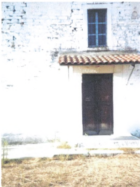
Η ακριανή θύρα της νότιας πλευράς του ναού (επάνω και δεξιά της διακρίνονται μερικές από τις ρωγμές του τοίχου)
