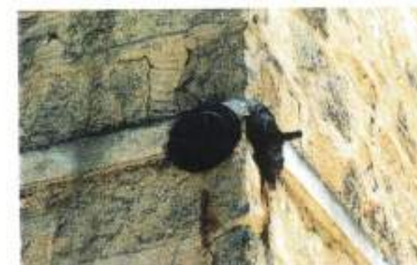
Λεπτομέρεια απολήξεων μεταλλικών ελαστήρων ενόχλησης της τοιχοποιίας στο ύψος του πατώματος του ορόφου. Διακρίνεται το περιμετρικό διάζωμα από τσιμεντοκονία.
