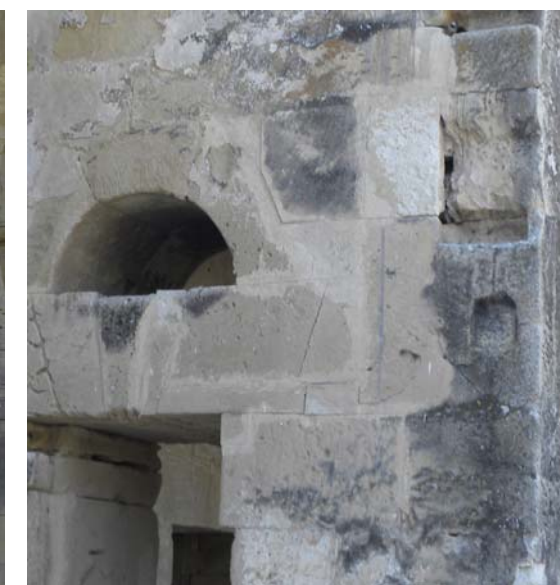
Εικ.21. Κατά την αναστήλωση του '30 πιθανολογείται ότι έγιναν συμπληρώσεις σε ορισμένους από τους λίθους της βόρειας παρειάς του νότιου τοίχου του κεντρικού κλίτους.
