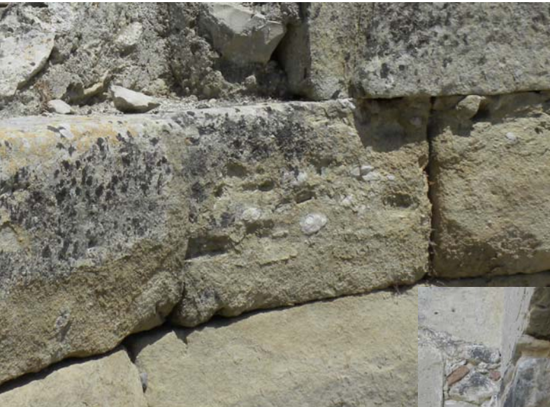
Εικ.25. Διακρίνεται η επιφανειακή αποσάθρωση, από την κονιορτοποίηση του πετρώματος στο κάτω μέρος των λίθων.
