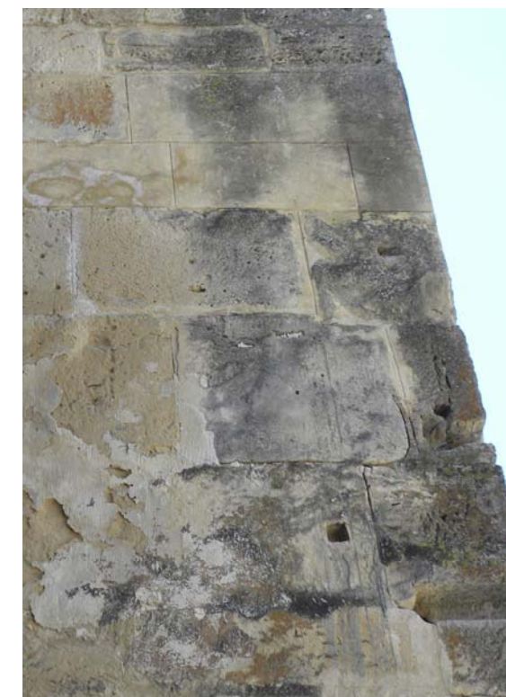
Εικ.24. Οι κηλίδες γκρίζου τσιμέντου στους τοίχους του ναού, υποδηλώνουν τη χρήση του ως ενισχυτικού υλικού στις στέγες.
