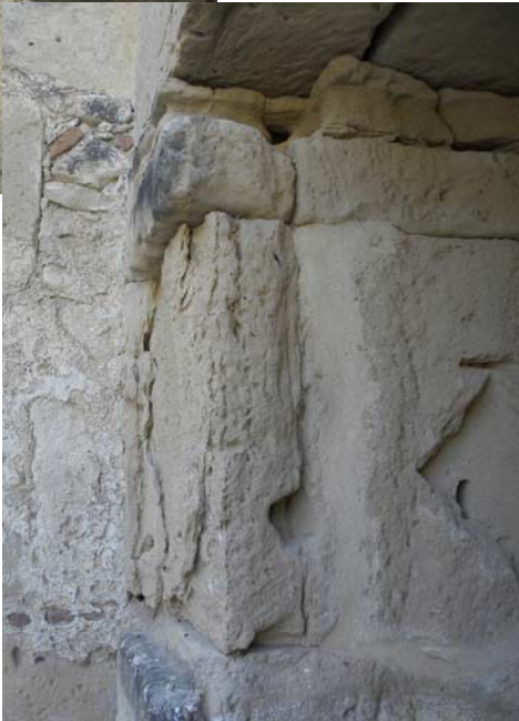
Εικ.26. Διακρίνονται οι επάλληλες αποφλοιώσεις με το διαχωρισμό κατά στρώσεις του πετρώματος και την κατάρρευση θραυσμάτων.
