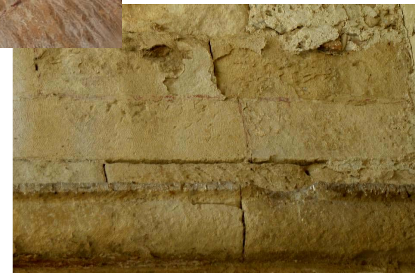
Εικ.16. Κεντρικό κλίτος, θόλος. Εντοπίστηκε ερυθρά χρωστική, περιμετρικά των αρμών.
