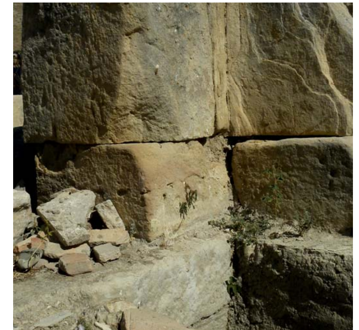
Εικ.30. Ο περιοχές που παλιότερα επλήγησαν από πυρκαγιά αναγνωρίζονται από την σφαιρική απομείωση των λίθων και την ερυθρωπή απόχρωσης.
