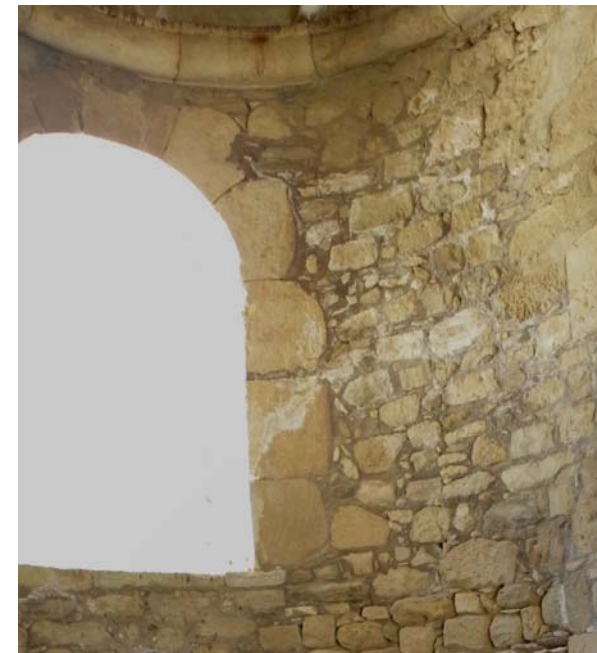
Εικ.29. Στο εσωτερικό του μνημείου κατά τόπους διακρίνονται λευκές εξανθίσεις αλάτων.
