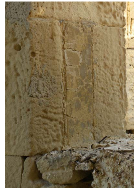
Εικ.43. Στο κονίαμα επισκευής των τελευταίων ετών παρατηρούνται κηλίδες ρωγμές συρρίκνωσης και εξανθίσεις αλάτων.
