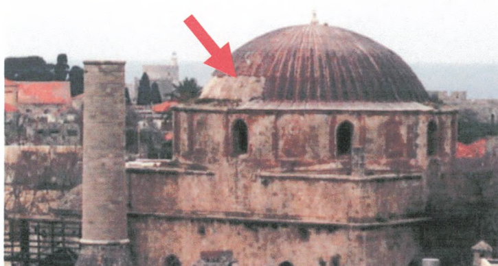
Εικ. Νότια όψη του κτιρίου. Σημειώνεται η απώλεια φύλλων μολύβδου από τη στέγη η οποία έχει ως αποτέλεσμα την είσοδο νερού στο εσωτερικό του μνημείου.
