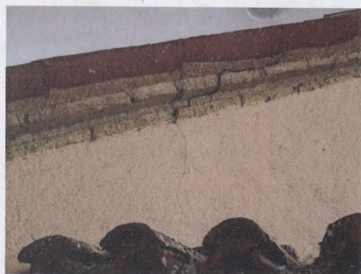
εικ. 4 Η ρωγμή στην ανατολική όψη
