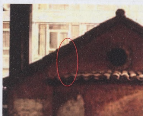
εικ. 5 Η ανατολική όψη του ναού όπου διακρίνεται η αστοχία (αρχείο ΔΑΒΜΜ)
