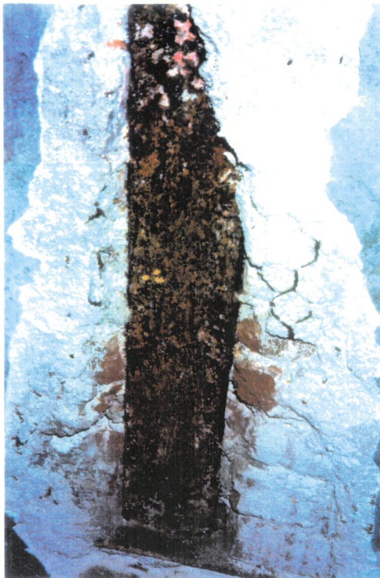
Φωτ. 5. Εικόνα κατάστασης μεταλλικών στοιχείων του τρούλου.
