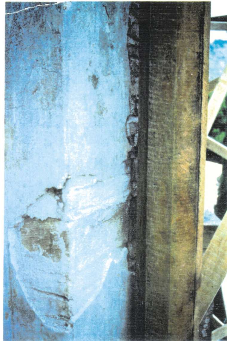
Φωτ. 10. Λεπτομέρεια τυμπάνου του τρούλου. Διακρίνονται κατακόρυφες ρωγμές πίσω από τον κιονίσκο.
