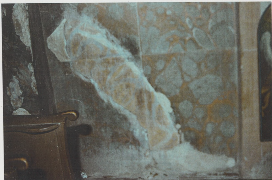
Εικ. 16. Λεπτομέρεια επισκευών στο επίχρισμα του εσωνάρθηκα.
