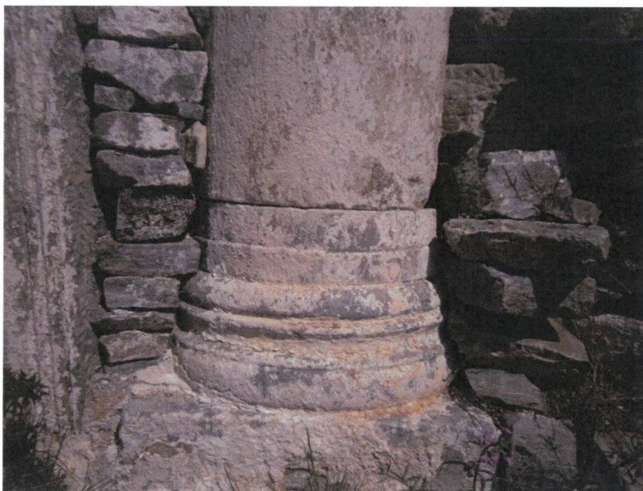
Φωτ. 14: Άποψη νότιου κίονα δυτικής εισόδου με ανάπτυξη δυσμενούς κλίσης προς νότο.
