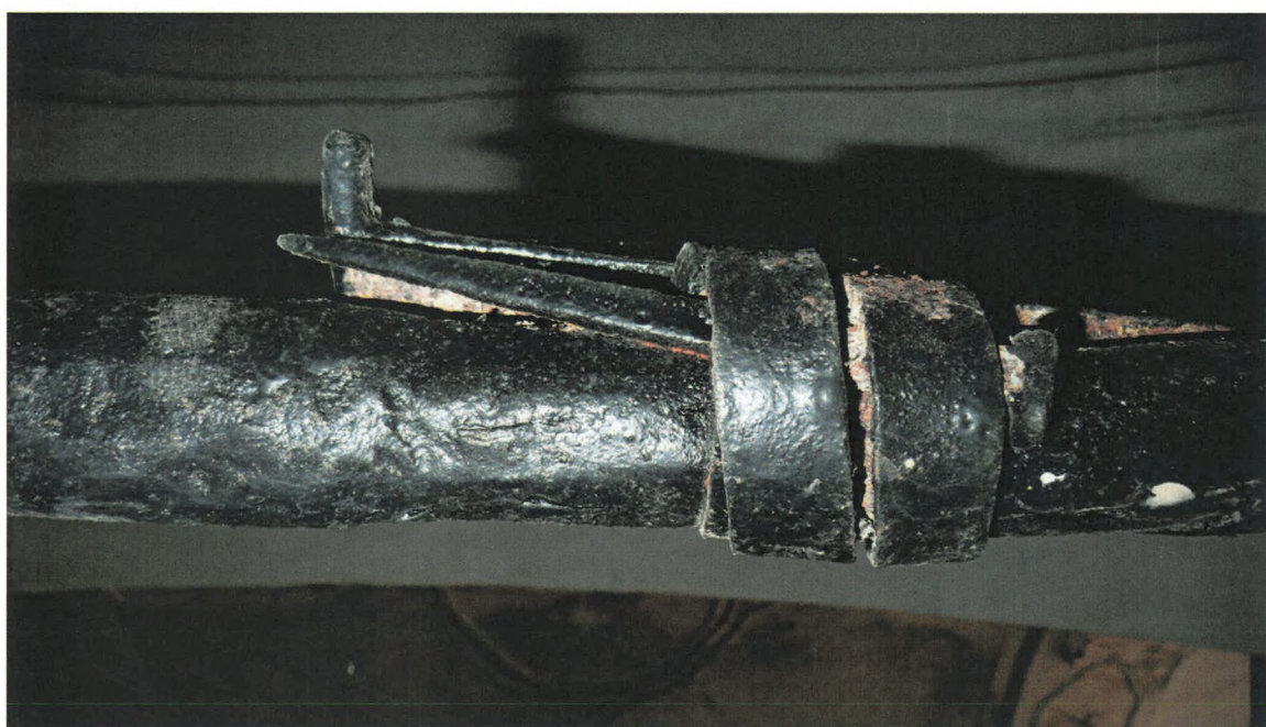
42, 43. Λεπτομέρειες των σιδηρών ελκυστήρων. Άνω, χαρακτηριστική εικόνα φθοράς του σφυρήλατου σιδήρου με αποφλοιώση της διατομής.
