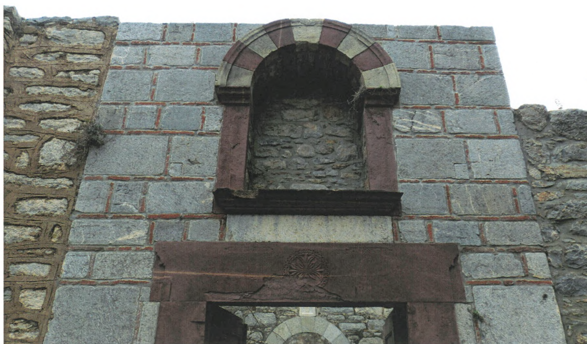
2. Το υπέρθυρο της νότιας θύρας του περιβόλου. Διακρίνεται η αρμολόγηση με τσιμεντοκονίαμα.
