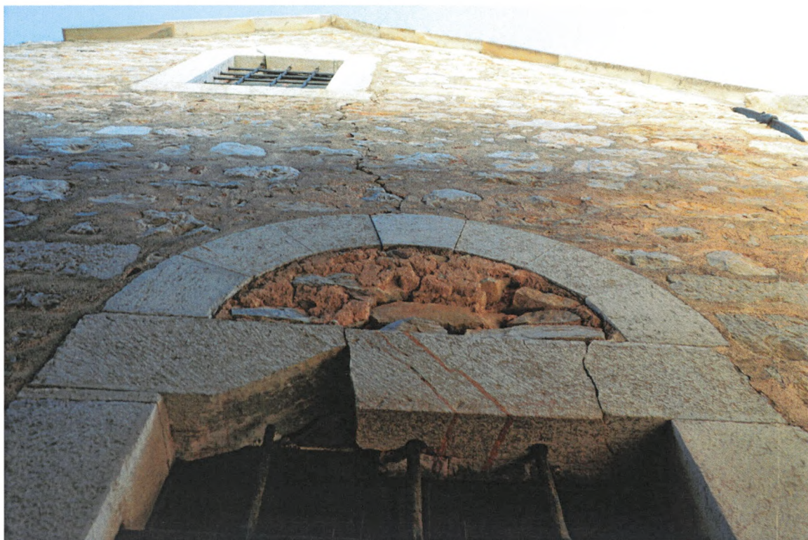
45. Ρήξη ανωφλίου και ρήγμα στο δυτικό τοίχο
