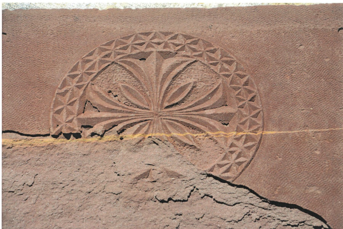
3. Η φθορά του αναγλύφου στη Θυμιανούσικη πέτρα, λόγω της χρήσης τσιμέντου στους γειτονικούς αρμούς
